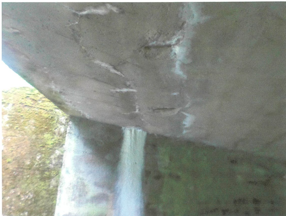
Fot. 3 . Erozja betonu płyty pomostowej, przecieki i wykwyty na powierzchni płyty i przyczółka.
