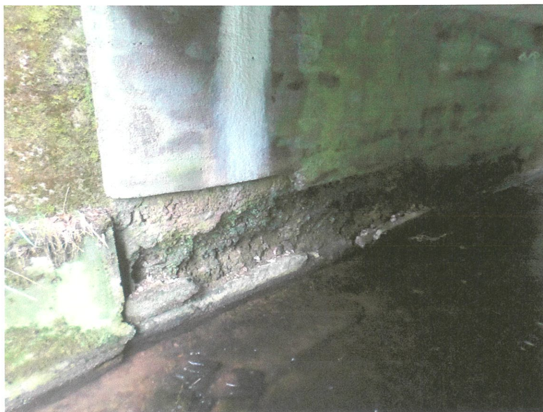
Fot. 2 . Erozja betonowego przyczółka lewobrzezowego, zniszczenie struktury materiału.
