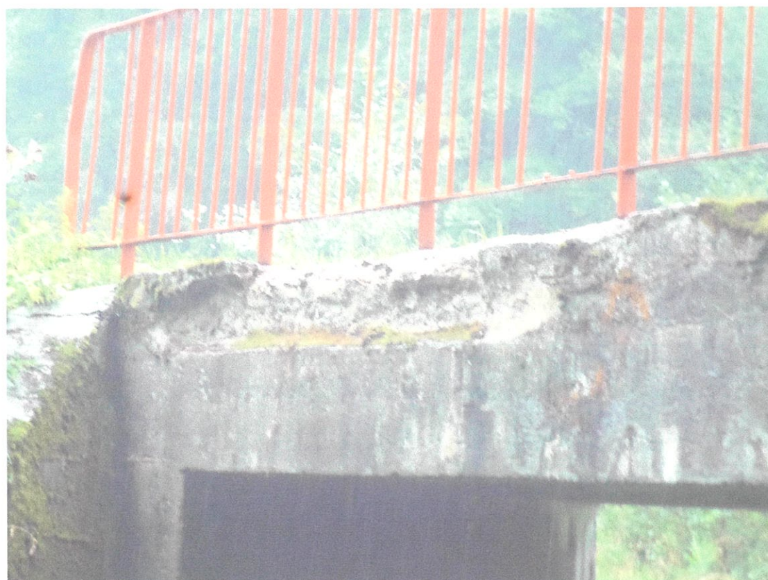
Fot. 4 . Erozja betonu belki podporczowej.
