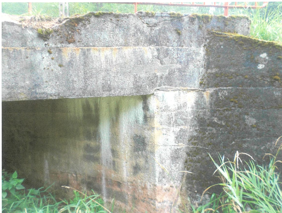
Fot. 1 . Przecieki i wykwyty na płycie pomostowej i przyczółku.
