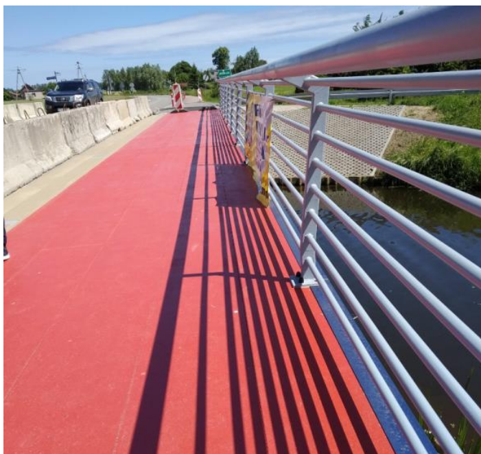
Fotografia 17. Odgięcie balustrada na obiekcie inżynierskim, trasa R9, gmina Cedry Wielkie. Źródło: Materiały Urzędu Marszałkowskiego Woj. Pomorskiego.
