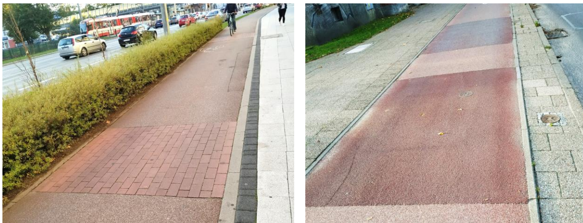
Fotografia 34-35. Przykład wprowadzenia etapowego wypełnienia ubytku powstałego w wyniku prac ziemnych, w tym przez gestora sieci.
