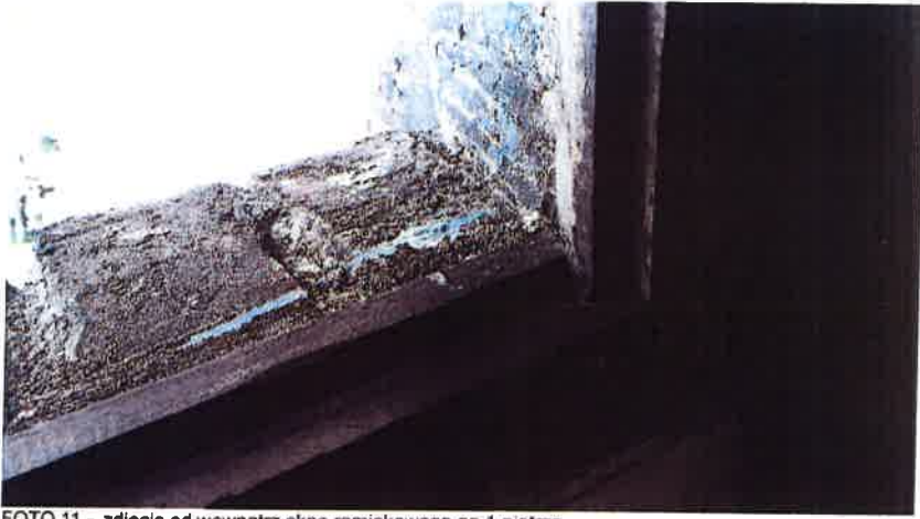
FOTO 11 – zdjęcie od wewnątrz okna ramiakowego na 1 piętrze
