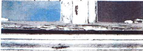
Ramiak od strony zewnętrznej bardzo zły stan drewna
