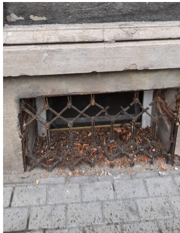
↑ Fot. 16. Stolarka okienna piwniczna do wymiany
