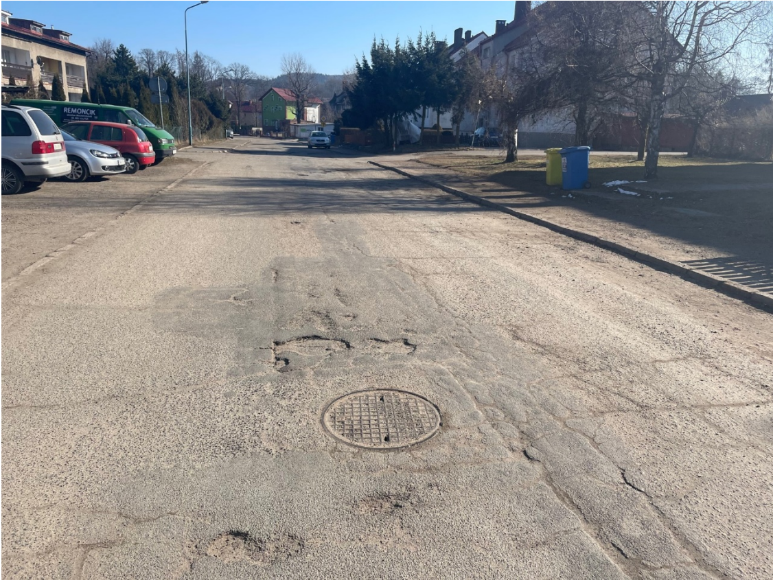
Fotografia 11 Widok na stan nawierzchni jezdni w rejonie bloku mieszkalnego nr 12
