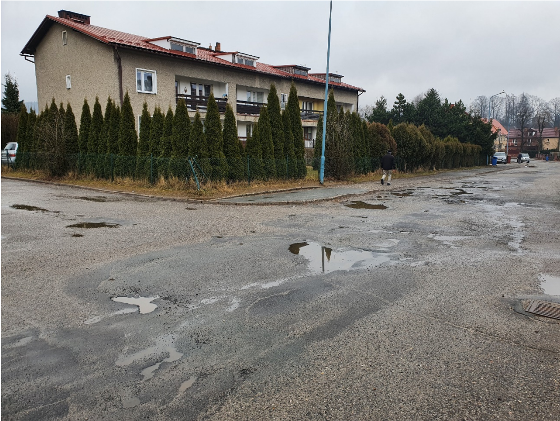
Fotografia 17 Stan nawierzchni jezdni w rejonie skrzyżowania z drogą dojazdową na posesję nr 14
