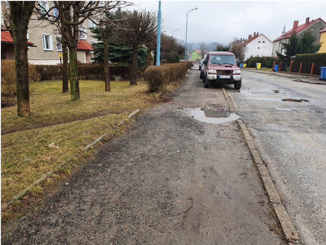
Fotografia 20 Stan nawierzchni chodników w rejonie budynku nr 10
