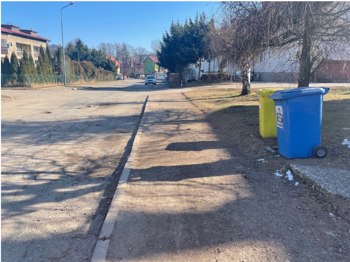
Fotografia 12 Widok na stan nawierzchni chodnika przy posesji nr 13
