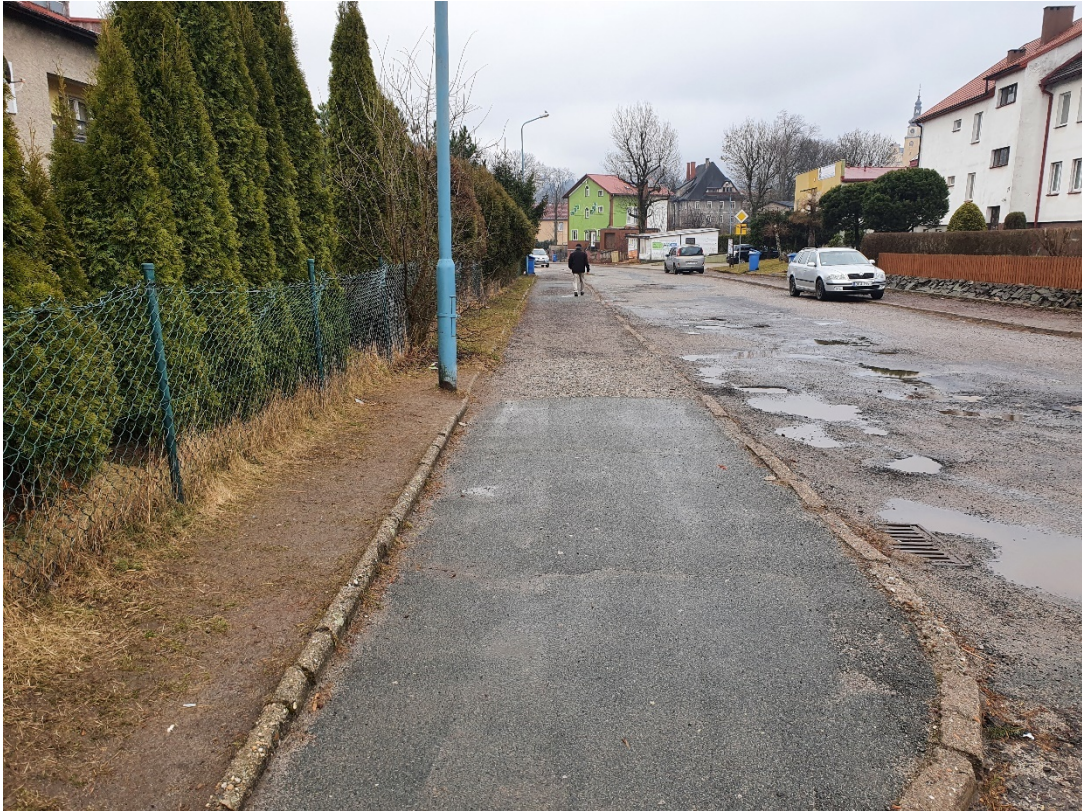
Fotografia 23 Widok na stan nawierzchni chodników przy budynku wielorodzinnym nr 16a-16b
