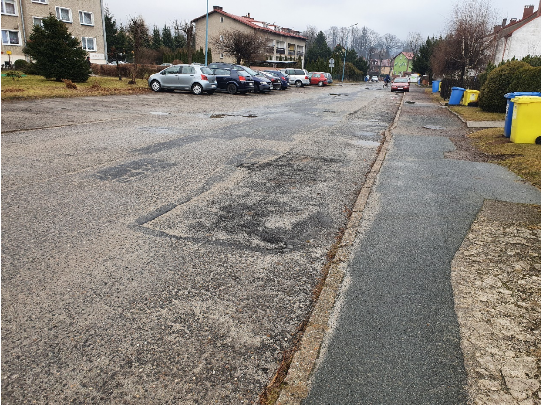
Fotografia 21 Stan nawierzchni jezdni i chodników w rejonie budynku nr 11
