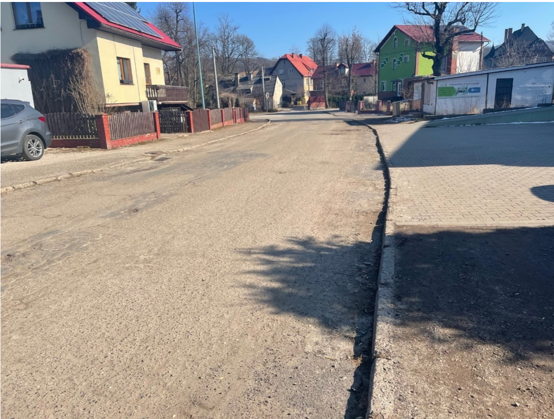
Fotografia 14 Widok na stan nawierzchni jezdni i chodnika w rejonie posesji nr 17
