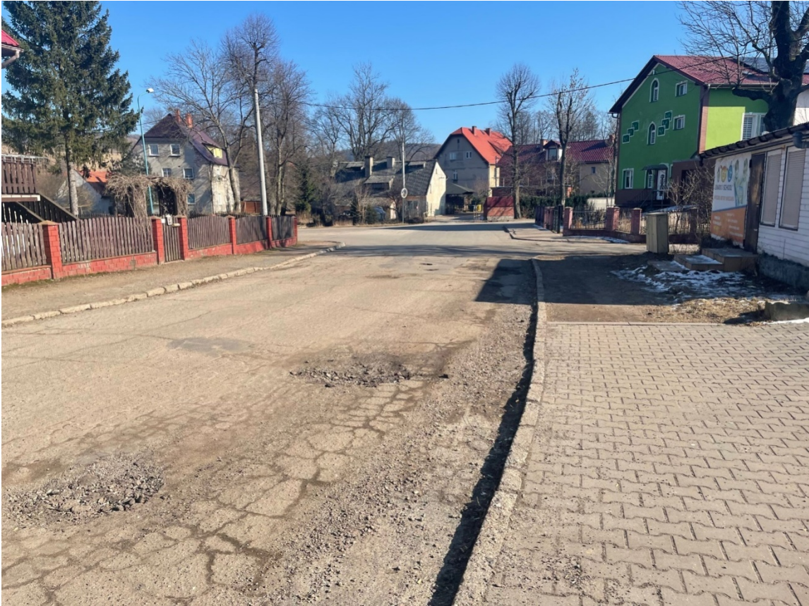
Fotografia 15 Stan nawierzchni jezdni ulicy Kolonia w rejonie posesji nr 19
