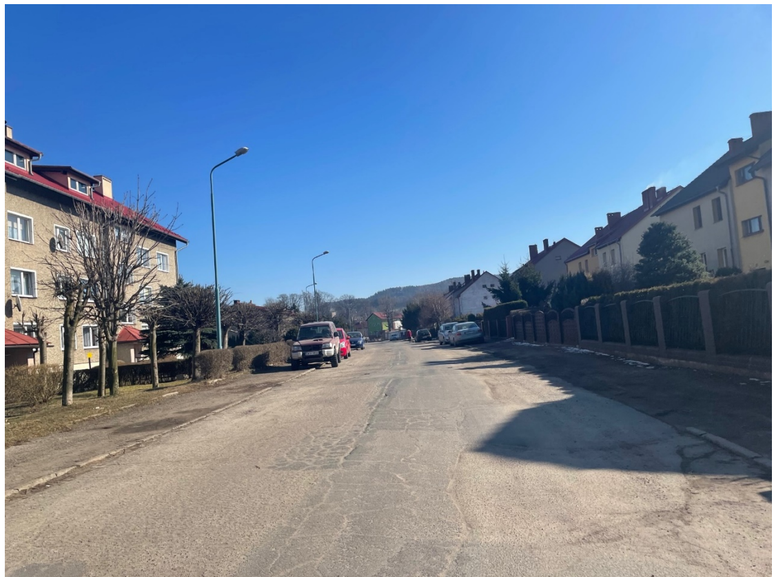
Fotografia 10 Widok na stan nawierzchni jezdni w rejonie bloku mieszkalnego nr 10
