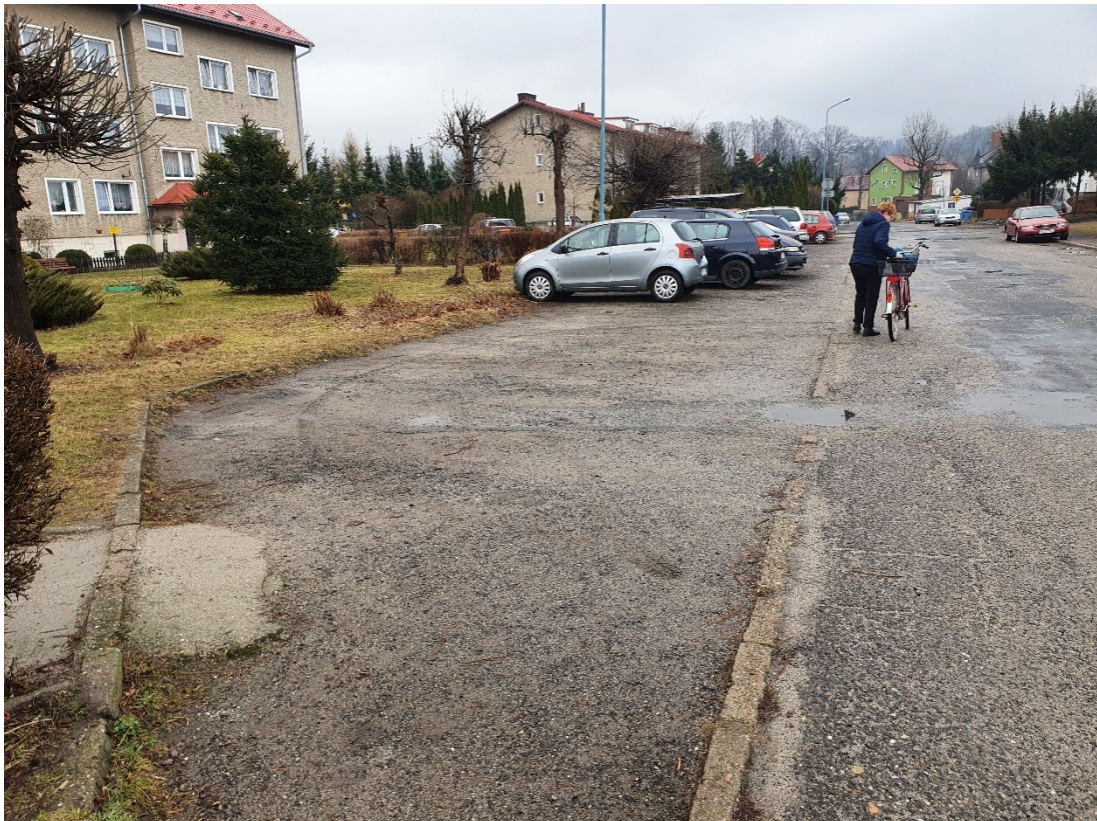
Fotografia 22 Stan nawierzchni miejsc postojowych w rejonie budynku nr 12
