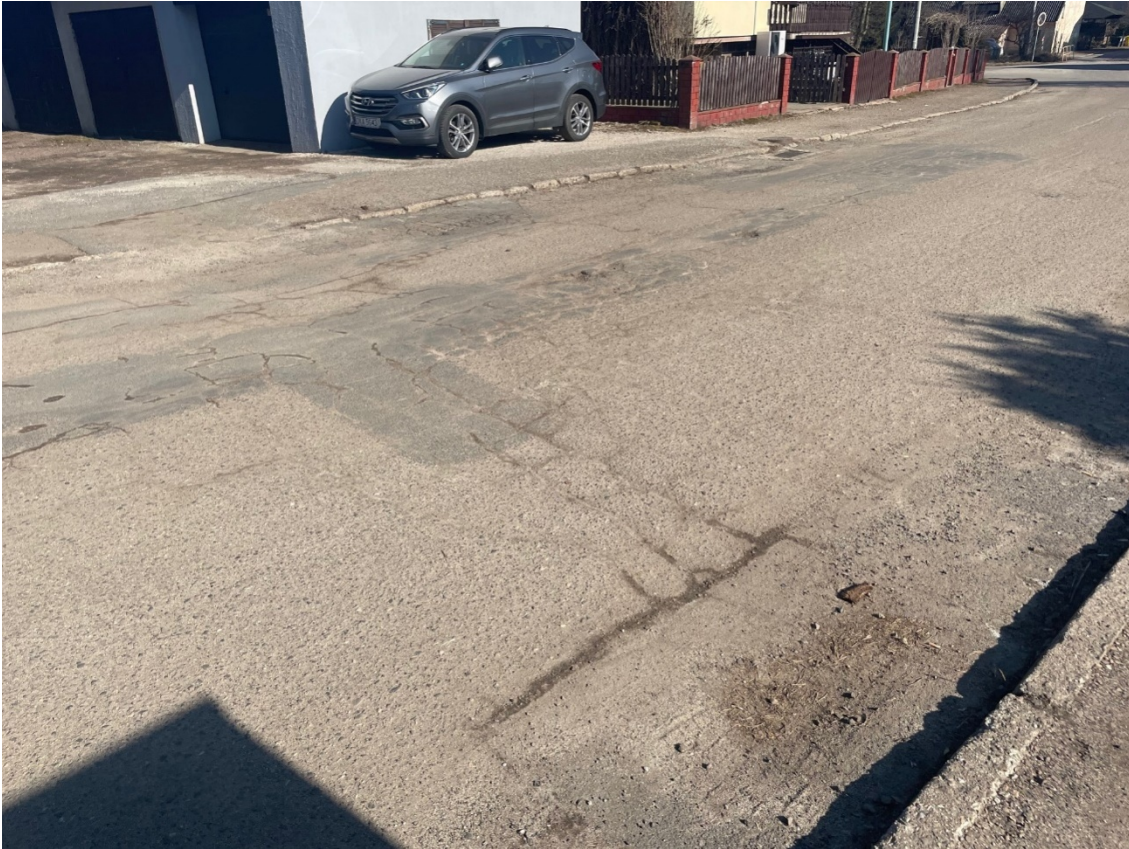
Fotografia 13 Widok na stan nawierzchni jezdni w rejonie posesji nr 17
