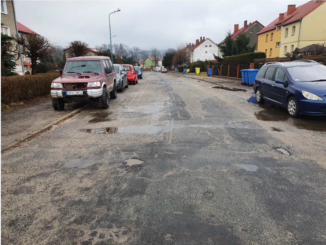
Fotografia 19 Stan nawierzchni jezdni ulicy Kolonia w rejonie budynku nr 10
