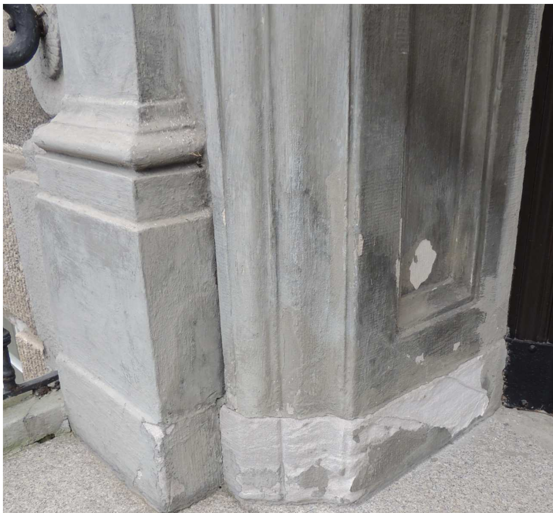
15. Łuszczące się warstwy cementowe odsłaniające piaskowiec.
