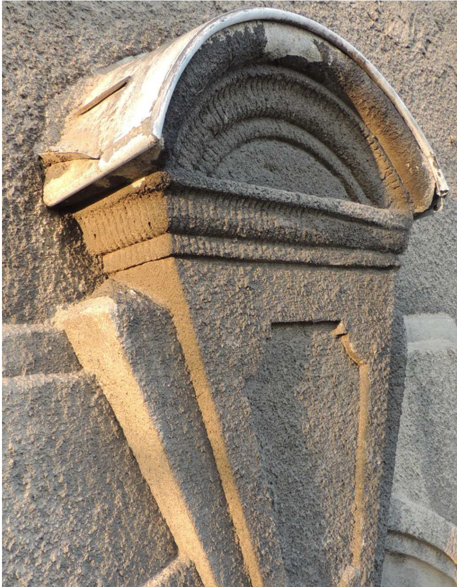
38. Zwornik okna eliptycznego. Widoczne nawarstwienia na tynku, podgięcia blachy, kapinos na rolkę.
