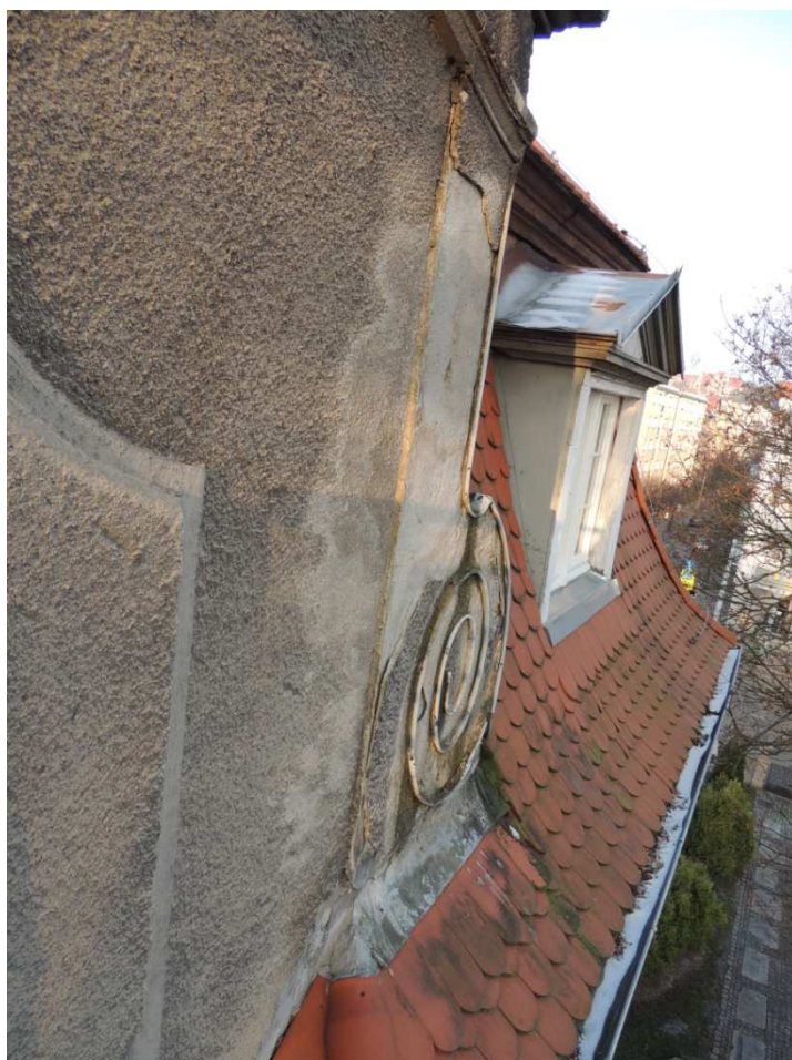
37. Zakres zniszczenia tynku prawej strony lukarny. Dalej widoczne plamy korozji na oblachowaniu facjaty.
