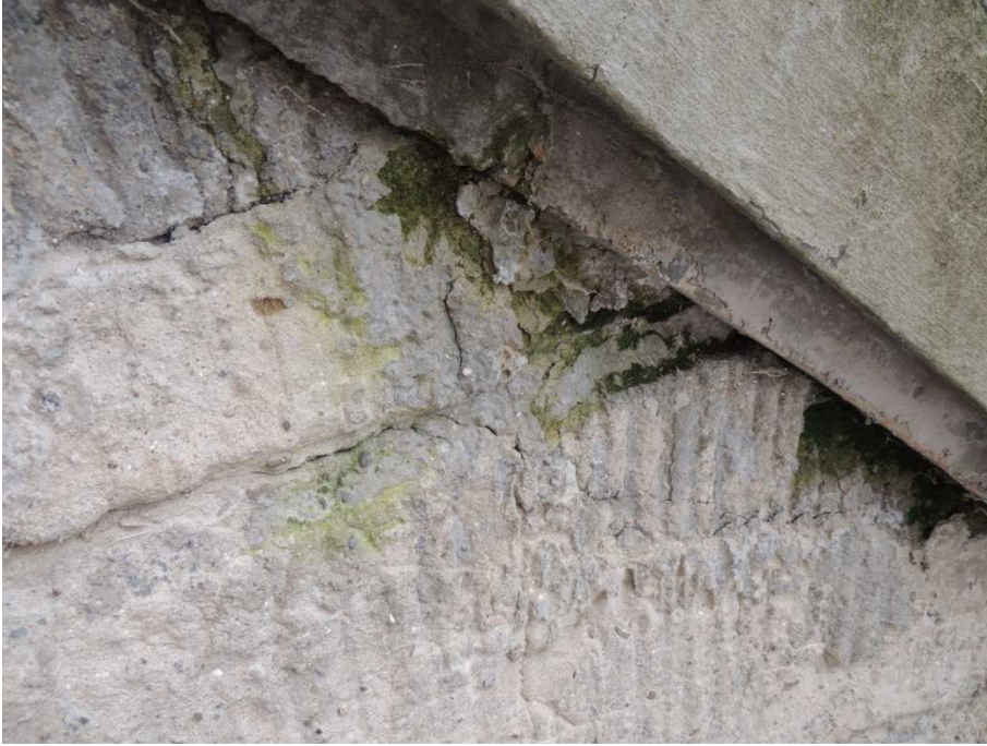
21. Zniszczenia tynku, warstwy wtórne pokrywające piaskowiec.
