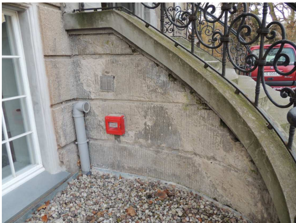
6. Uszkodzenia i zniszczenia obrzutki tynkarskiej schodów wejściowych.
