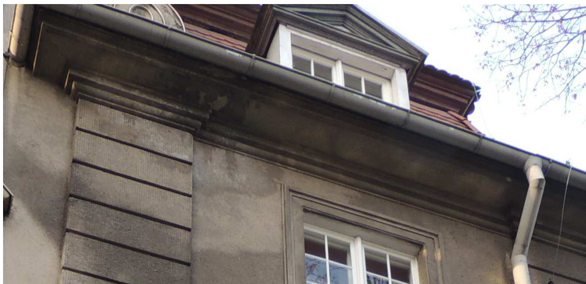
34. Gzyms podokapawy, widoczne czarne nawarstwienia i zaplamienia elewacji.
