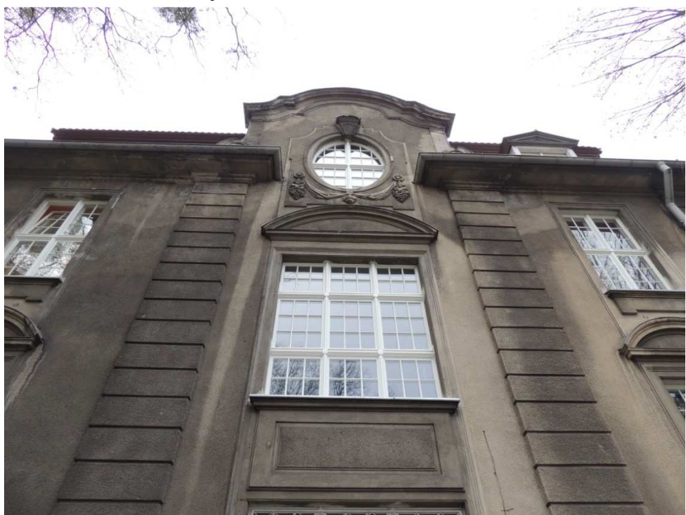
31. Elewacja od strony ul. Armii Krajowej.
