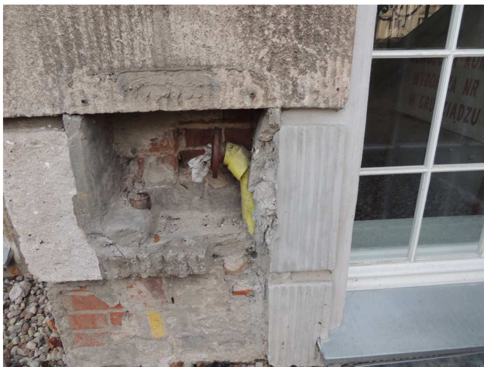
5. Uszkodzenia i wtórne naprawy muru oraz tynku.
