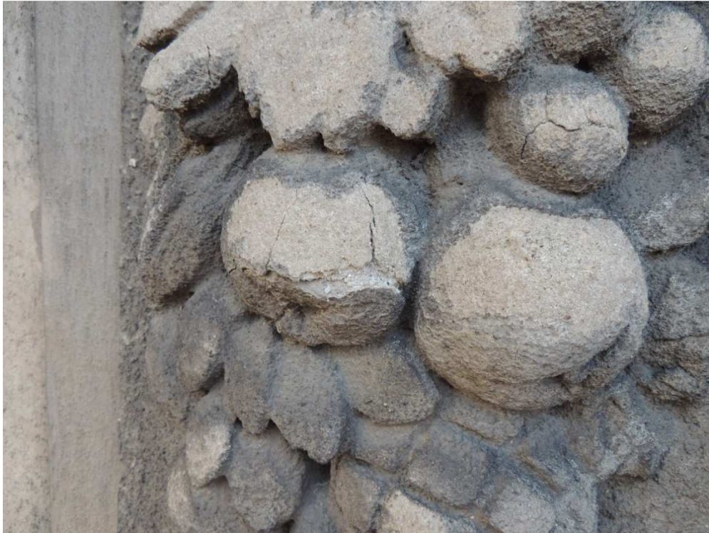
42. Pęknięcia zaprawy wierzchniej, jasne miejsca znacząco osypują się.
