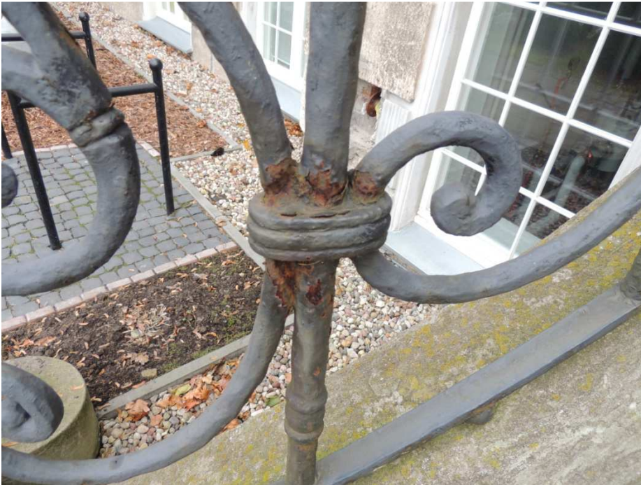
22. Korozja elementów balustrady.
