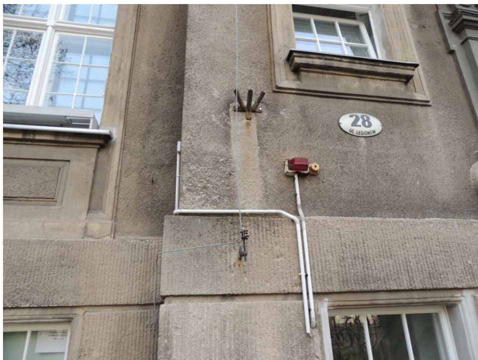
4. Przewody, korodujące flagownice.
