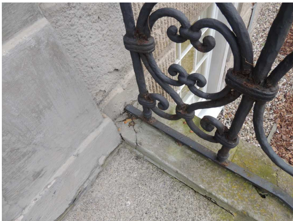
17. Pęknięcia piaskowca pod balustradą. Widoczne glony i porosty zasiedlające kamień.
