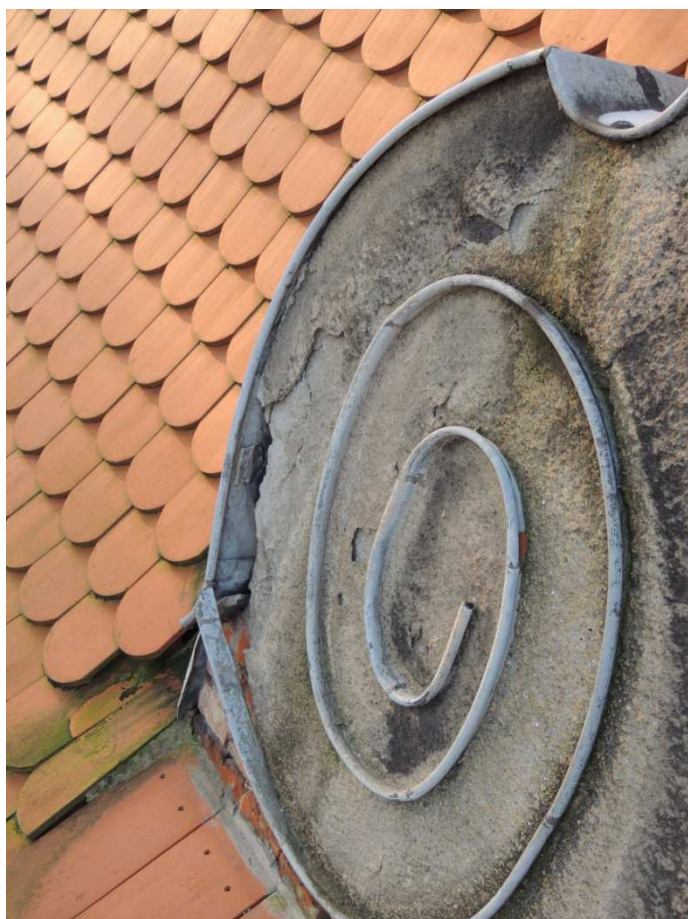
35. Ślimacznica lukarny, zniszczenia tyków, zplamienia, ubytki głębokiej warstwy tyku. Lewa strona.
