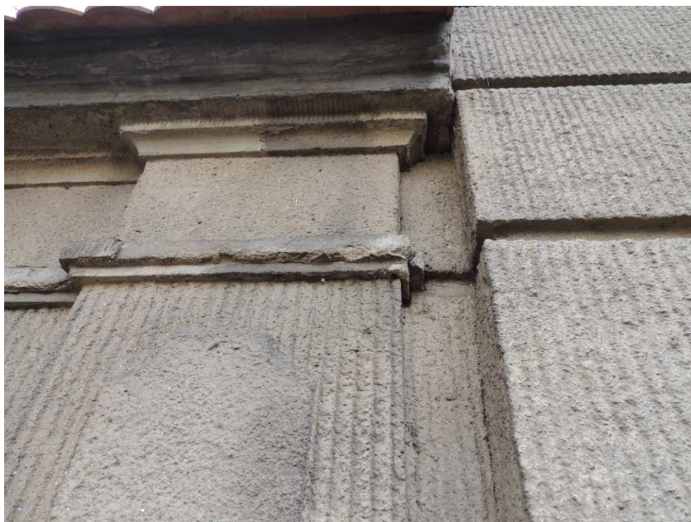
26. Murek wjazdowy, widoczne przepłukanie zaprawy w obrębie profilu.
