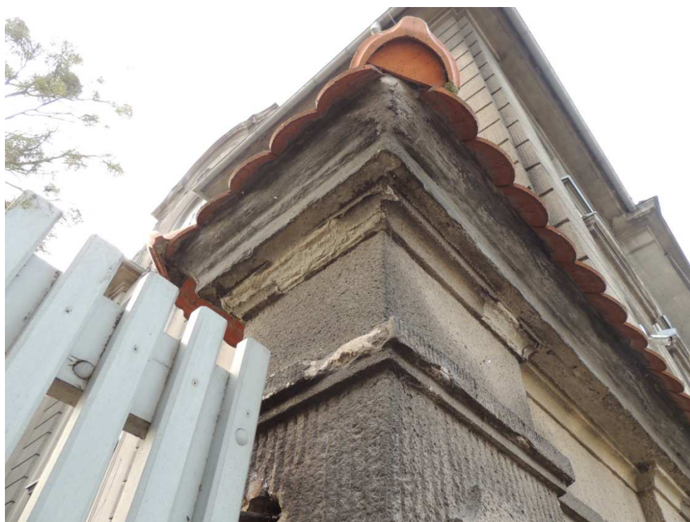
25. Zniszczenia profilu podokapowego, warstwa cementowa.
