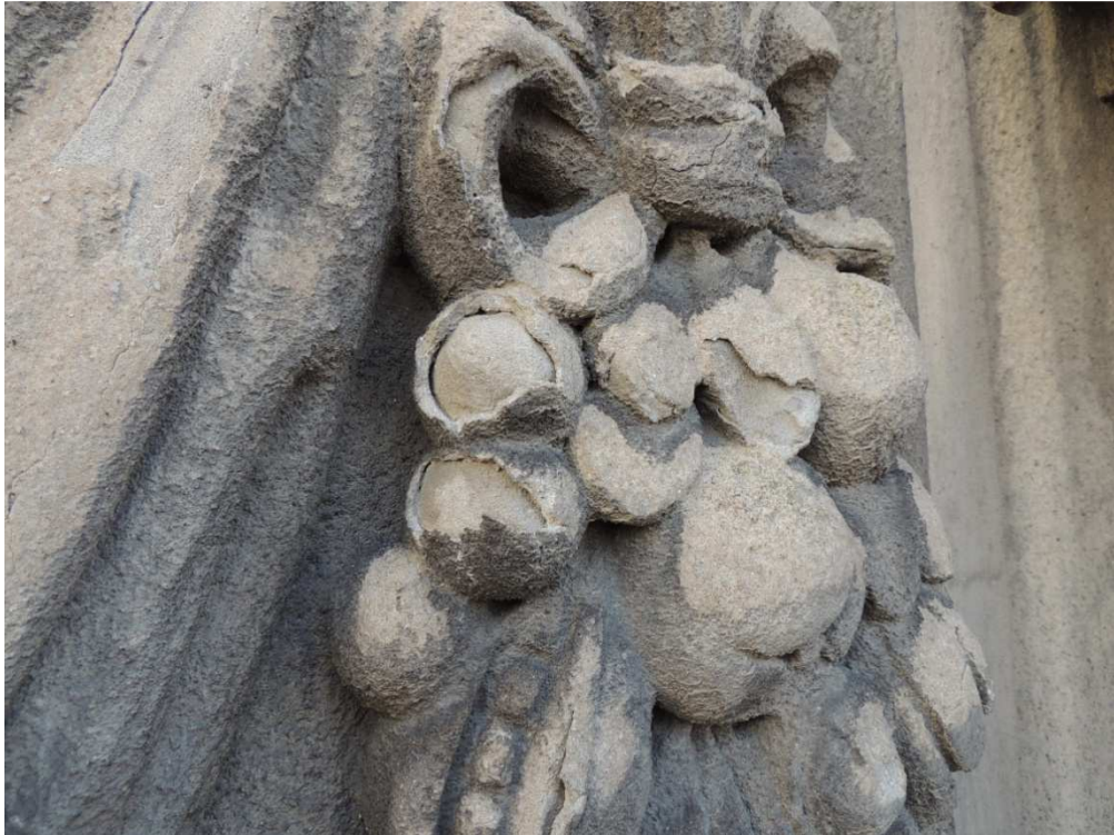
44. Rozwarstwienia na granicy tynku nośnego i obrzutki.
