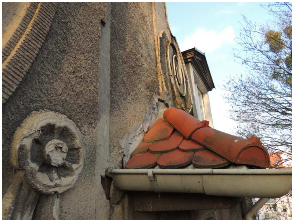
41. Wtórna próba podtrzymania odspojonych tynków, wykonana zaprawą mineralną klejową.
