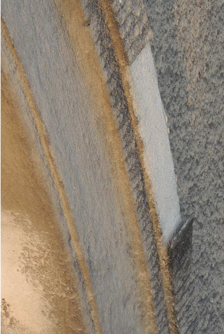
39. Złuszczenia obrzutki tynkarskiej, okno eliptyczne.
