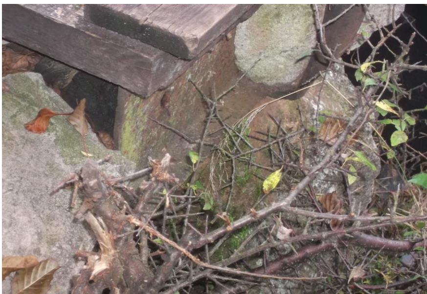
Fot.20. Widok posadowienia pomostu P-2 na przyczółku po stronie kościoła i dolnej wody. Stalowa konstrukcja pomostu z dwóch dwuteowników 200 mm stężanych poprzecznie kształtownikami 160 mm posadowiona, bez łożyskowania, na uszkodzonym,spękany i pozbawionym skrzydeł oczepie przyczółka. Betonu korpusu przyczółka niskiej klasy C 8/10, C 12/15 i pozaklasowy w miejscach uszkodzeń.
