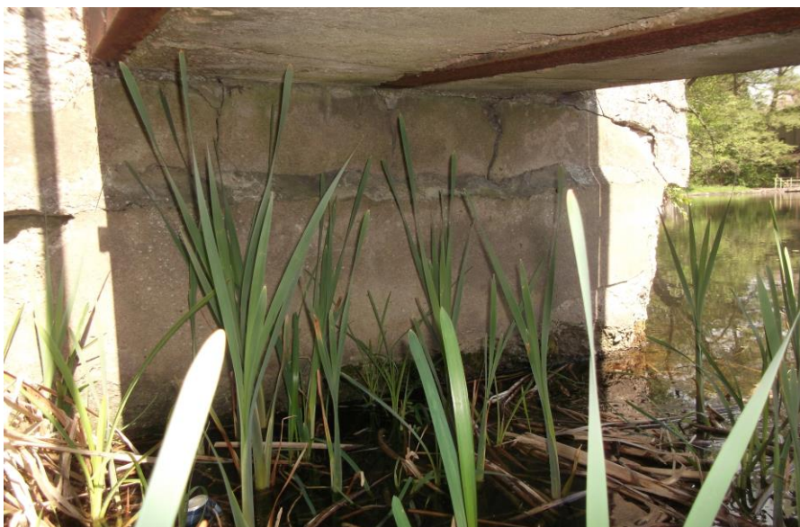
Fot.8. Widok czola filara po stronie ulicy i spodu żelbetowego pomostu P-1 w C 180 mm wzmocnionego osiowo blachą stalową 5x200 mm. Widoczne miejscowe spękania i odspojenia betonu filara oraz zacieki i ubytki betonu pomostu. Korozja stali.
