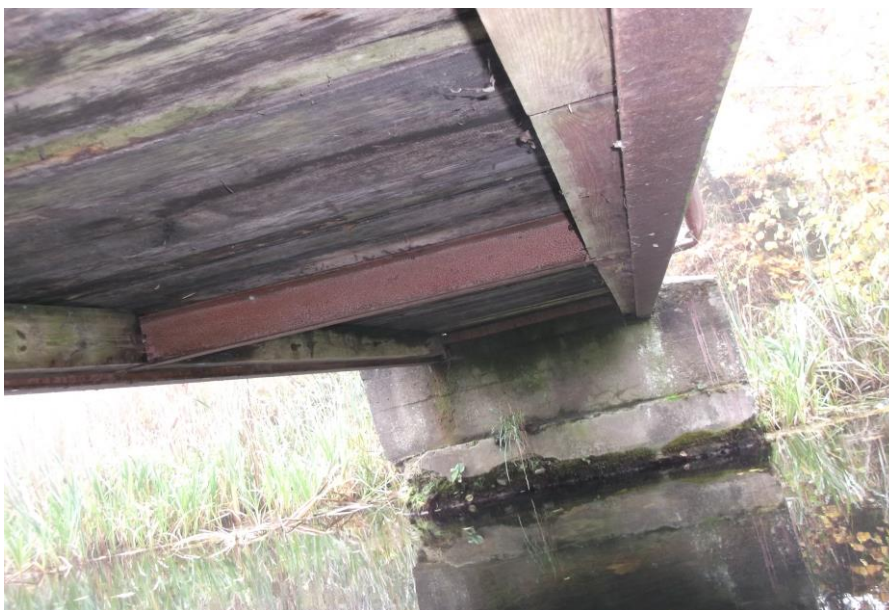
Fot.15. Widok spodu pomostu P-2 i przyczółka po stronie ulicy. Stalowa konstrukcja pomostu z dwóch dwuteowników 200 mm stężanych poprzecznie kształtownikami 160 mm z uszkodzeniami powłok antykorozyjnych. Drewno pomostu sosnowe z widocznymi zaciekami i bielą pleśni, po kilku latach eksploatacji. Uszkodzony betonowy filara z widocznymi spękaniami i ubytkami oczepów oraz ubytkami, spękaniami i wymyciami korpusu. Betonu korpusu przyczółka niskiej klasy C 8/10, C 12/15 i pozaklasowy w miejscach uszkodzeń.
