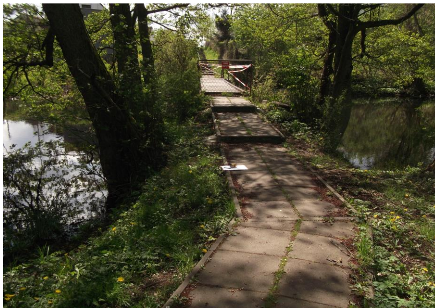
Fot.1. Widok dojścia do kładki po wąskim półwyspie i początku pomostu P-2 kładki od strony kościoła. Umocnienie dojść płytami betonowymi 5x50x50 cm w obrzeżach betonowych o całkowitej szerokości około 116 cm. Kładka zamknięta dla ruchu. Brak balustrad na skarpach rzeki po wzdłuż dojścia do kładki. Gęste zarośla krzewów i drzewa na dojściach do kładki.
