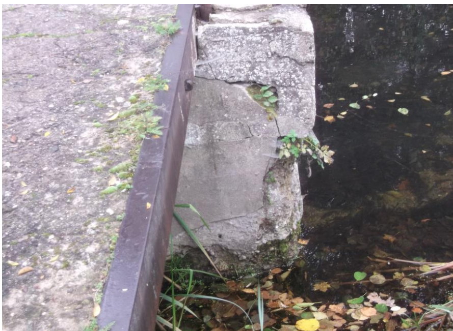
Fot.13. Widok szczegółów boku i czoła filara od strony ulicy i dolnej wody. Widoczne, znaczne uchyty, odspojenia i spękania betonu góry i korpusu filara. Widok posadowienia żelbetowego pomostu P-2 na filarze. Korozja stali C 180 mm.
