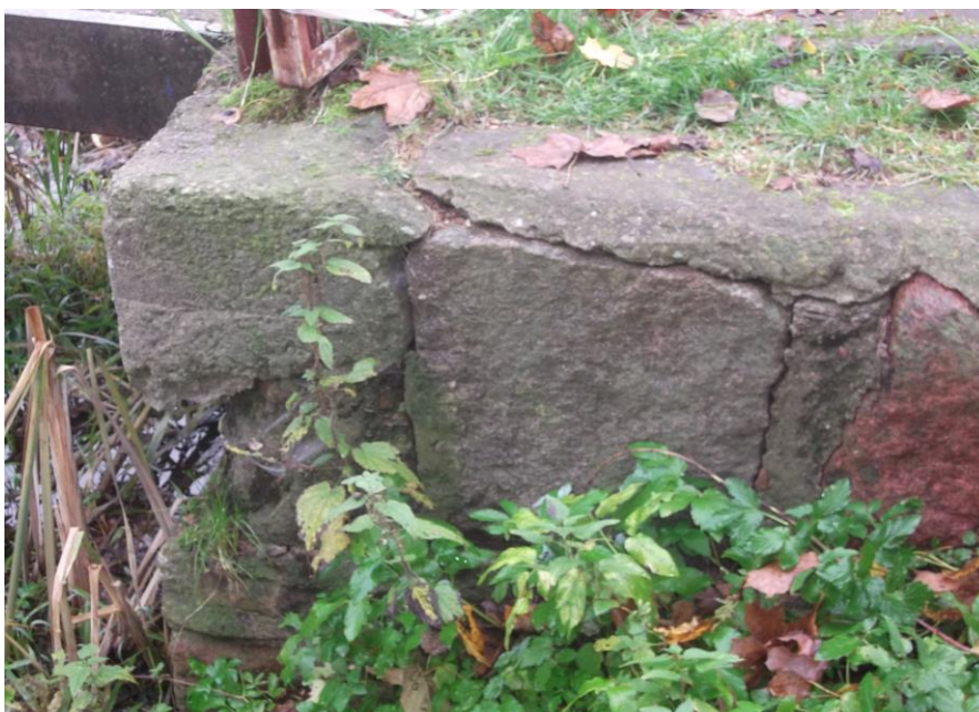
Fot.10. Widok szczegółów boku przyczółka od strony ulicy i górnej wody. Widoczne, znaczne uchyty, odspojenia i spękania betonu góry i oczepu przyczółka oraz spękania i ubytki spoinowania kamieni przyczółka i skrzydeł.
