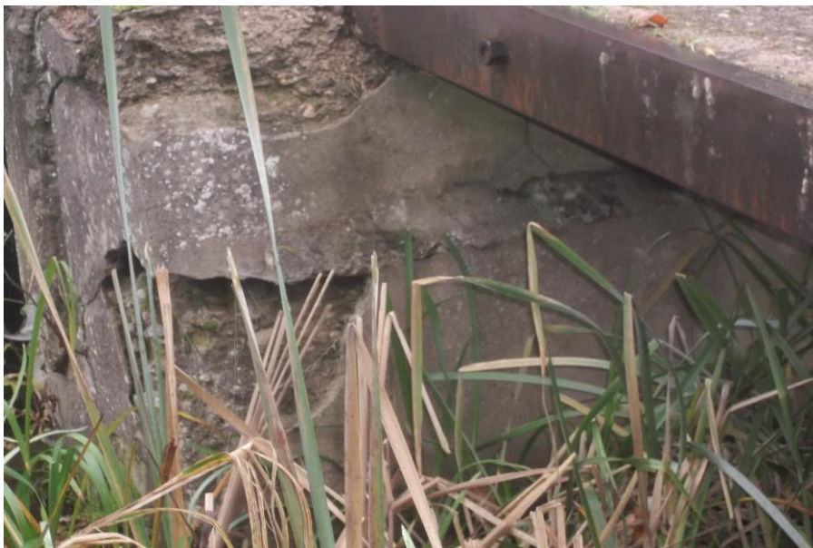
Fot.12. Widok szczegółów boku i czoła filara od strony ulicy i górnej wody. Widoczne, znaczne ubytki, odspojenia i spękania betonu góry i korpusu filara. Widok posadowienia żelbetowego pomostu na filarze. Korozja stali C 180 mm.
