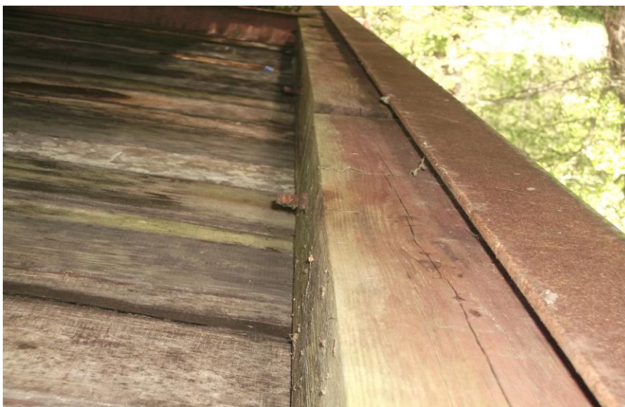
Fot.17. Widok odwrócony szczegółów spodu pomostu P-2. Stalowy dwuteownik 200 mm z początkami korozji. Do I 200 mm przykręcona podłużnica sosnowa 160x110 mm, do której przybito gwoździami sosnowe deski pomostu grubości 50 mm. Deski pomostu z zaciekami i uszkodzeniami korozji biologicznej-pleśni.
