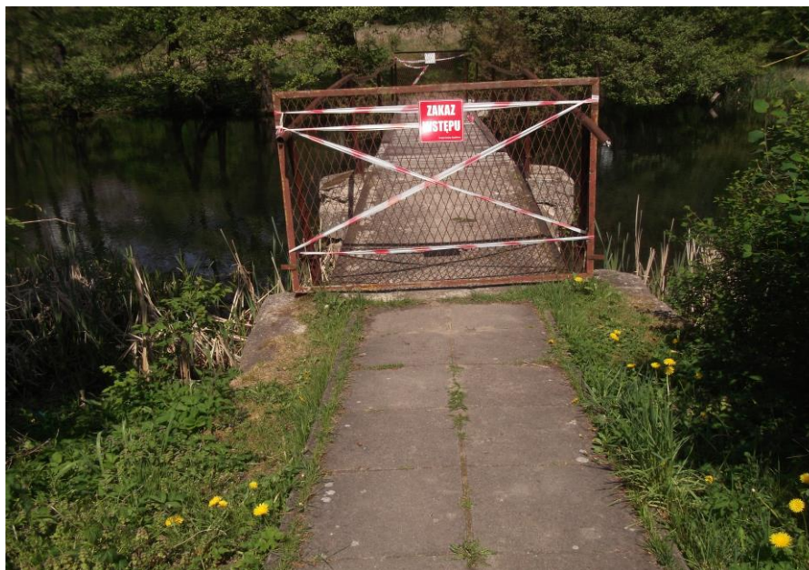
Fot.4. Widok dojścia do kładki i początku pomostu P-1 kładki od strony ulicy. Umocnienie dojść płytami betonowymi 5x50x50 cm w obrzeżach betonowych o całkowitej szerokości około 116 cm. Kładka zamknięta dla ruchu. Brak balustrad na skrzydłach dojścia do kładki. Gęste zarośla krzewów przy przyczółkach jednym z powodów uszkodzeń skrzydeł kładki.
