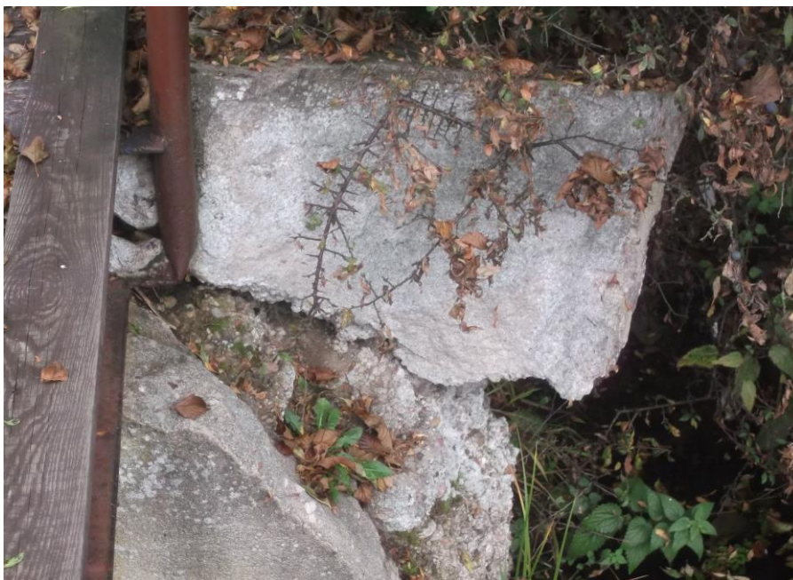
Fot.19. Widok posadowienia pomostu P-2 na przyczółku po stronie kościoła i dolnej wody. Stalowa konstrukcja pomostu z dwóch dwuteowników 200 mm stężanych poprzecznie kształtownikami 160 mm posadowiona, bez łożyskowania, na uszkodzonym,spękany i pozbawionym skrzydeł oczepie przyczółka. Betonu korpusu przyczółka niskiej klasy C 8/10, C 12/15 i pozaklasowy w miejscach uszkodzeń.
