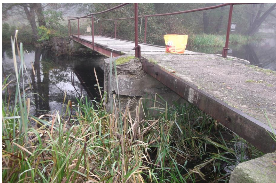
Fot.6. Widok podłużny pobocza kładki po stronie górnej wody, od strony ulicy. Widok fragmentu przyczółka i uszkodzonego filara oraz żelbetowego pomostu P-1 w stalowych ceownikach 180 mm, a na dalszym planie stalowej konstrukcji głównego pomostu P-2 z nawierzchnią drewnianą, oraz uszkodzonego przyczółka po stronie kościoła. Istniejące, nienormatywne balustrady z rur stalowych, powyginane i wystające do około 10 cm poza obrys pomostu, nie stanowią wymaganego zabezpieczenia dla ruchu. Widoczne, trwałe ugięcie pomostu w środku rozpiętości nim. 80 mm.
