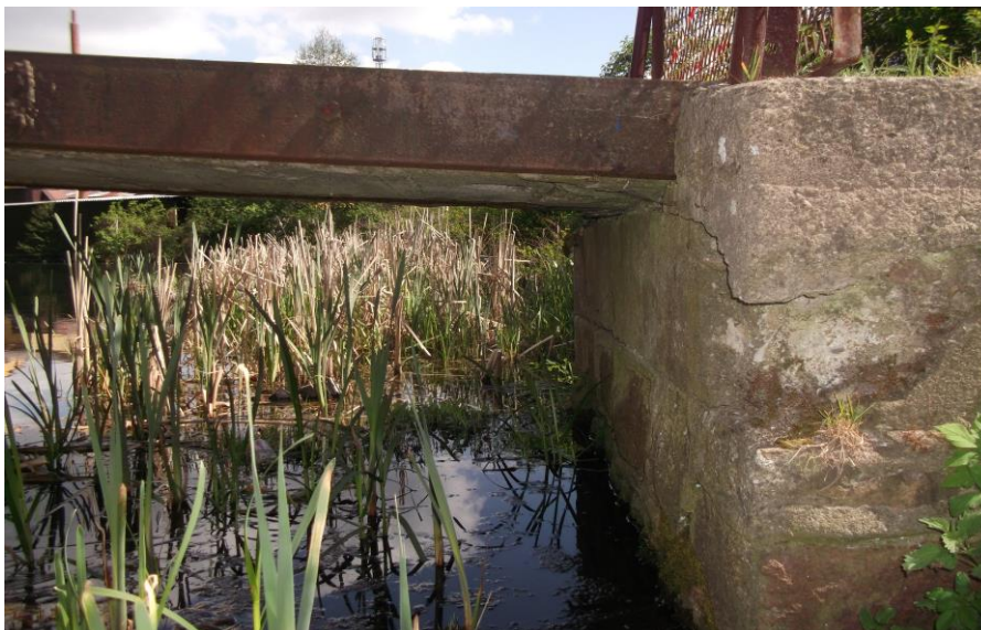
Fot.7. Widok ogólny czola i boku przyczółka od strony ulicy i górnej wody oraz żelbetowego pomostu P-1 w stalowych ceownikach 180 mm i koryta rzeki pod pomostem. Widoczne miejscowe uszkodzenia konstrukcji przyczółka. Korozja stali.
