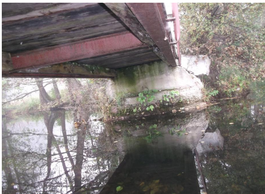
Fot.14. Widok spodu pomostu P-2 i przyczółka po stronie kościoła. Stalowa konstrukcja pomostu z dwóch dwuteowników 200 mm stężanych poprzecznie kształtownikami 160 mm z uszkodzeniami powłok antykorozyjnych. Drewno pomostu sosnowe z widocznymi zaciekami i bielą pleśni, po kilku latach eksploatacji. Uszkodzony betonowy przyczółek z odłamanymi skrzydłami i odspojeniami luźnego, zwisającego betonu oczepu i korpusu przyczółka. Podmycia i spękania betonu korpusu przyczółka niskiej klasy C 8/10, C 12/15 i pozaklasowy w miejscach uszkodzeń.
