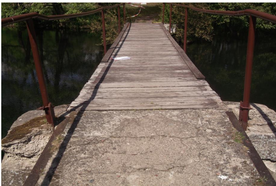
Fot.18. Widok ogólny-poprzeczny pomostów kadki od strony ulicy. Pomost żelbetowy P-1 z widocznymi spękaniem betonu, pomost główny P-2 z nawierzchnią sosnową z ubytkami desek krawężnikowych 30x100 mm. Spękania i odspojenia betonu oczepów filara. Istniejące, nienormatywne balustrady z rur stalowych, powyginane i wystające około 10 cm poza obrys pomostu, nie stanowią wymaganego zabezpieczenia dla ruchu.
