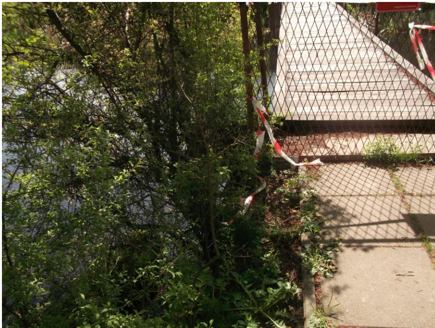
Fot.3. Widok dojściado kładki i początku pomostu P-2 kładki od strony kościoła, po stronie dolnej wody. Umocnienie dojść płytami betonowymi 5x50x50 cm w obrzeżach betonowych o całkowitej szerokości około 116 cm. Kładka zamknięta dla ruchu. Brak balustrad na skarpach rzeki wzdłuż dojścia do kładki. Całkowity brak skrzydła przyczółka, podmytego, odspojonego i leżącego w w korycie rzeki. Krzewy, będące jedną z przyczyn uszkodzenia przyczółka i oderwania skrzydła, bujnie porastając skarpe, utrzymując dojście do kładki.
