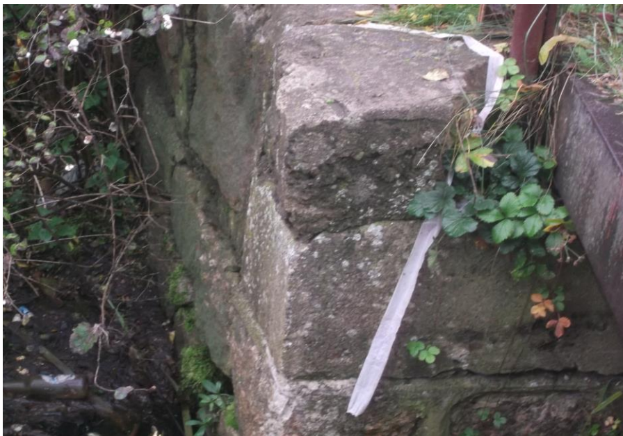
Fot.11. Widok szczegółów boku i czoła przyczółka od strony ulicy i dolnej wody. Widoczne odspojenia i spękania betonu góry i oczepu przyczółka oraz spękania i ubytki spoinowania kamieni oraz ubytki kamieni przyczółka i skrzydła.
