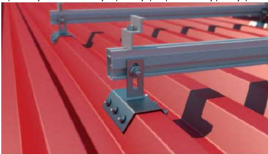
Rysunek 20 - Detal montażu podkonstrukcji paneli w przypadku wersji inwazyjnej do blachy trapezowej
