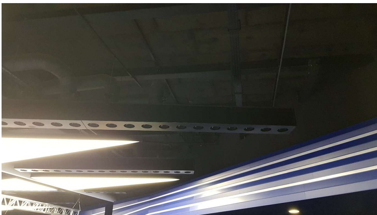
Rysunek 4 - Widok instalacji zamontowanych do spodu dachu
