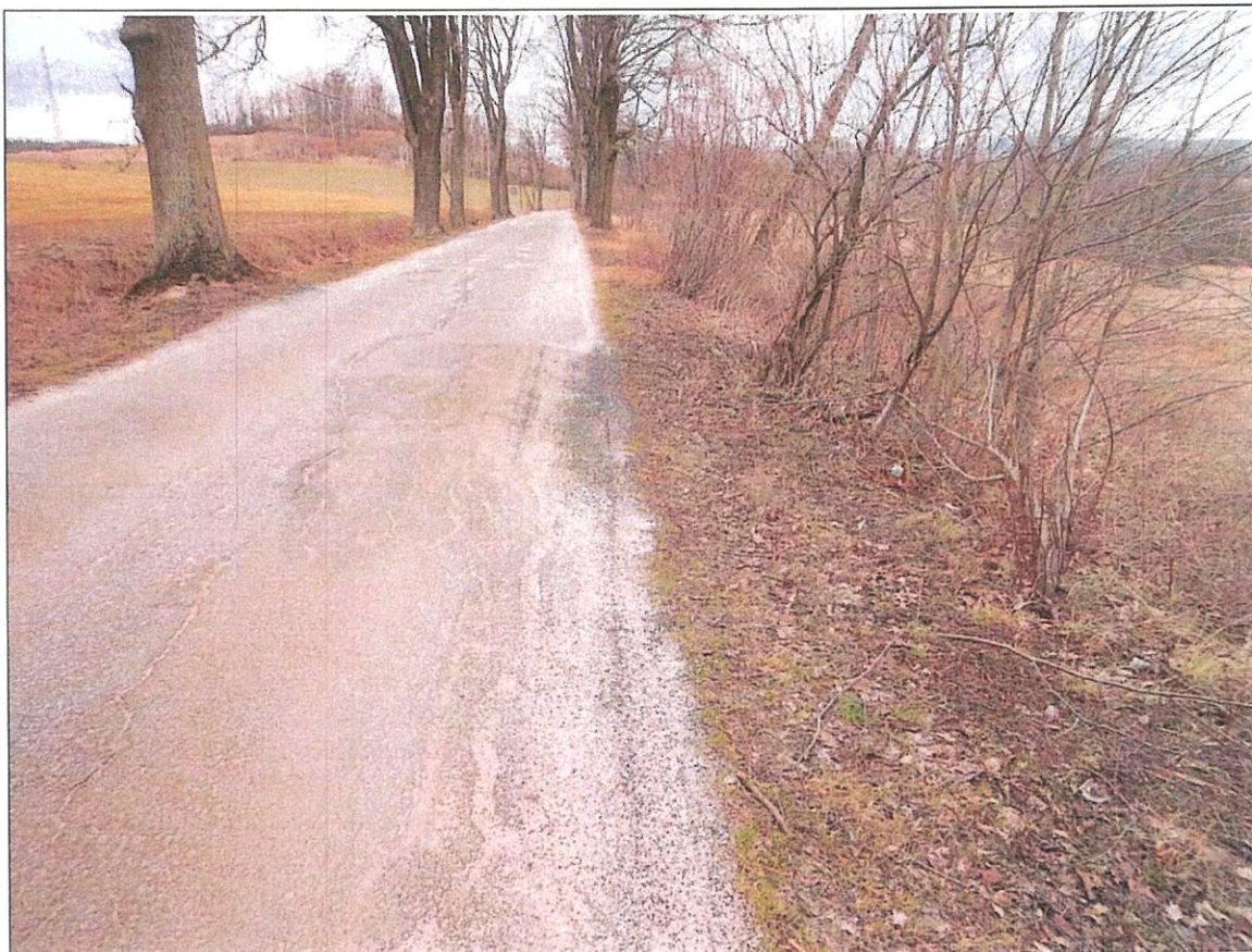
Pęknięcia i przemieszczenia w nawierzchni asfaltowej.
