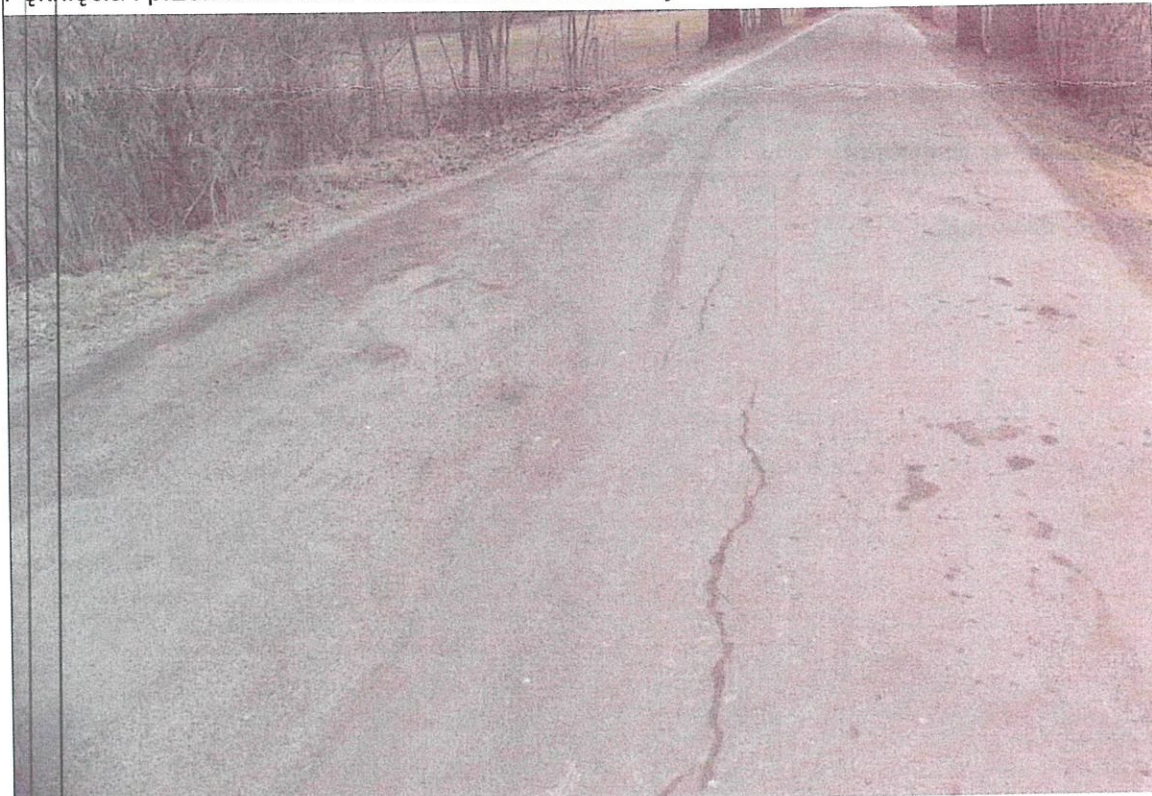
Pęknięcia i przemieszczenia w nawierzchni asfaltowej.
