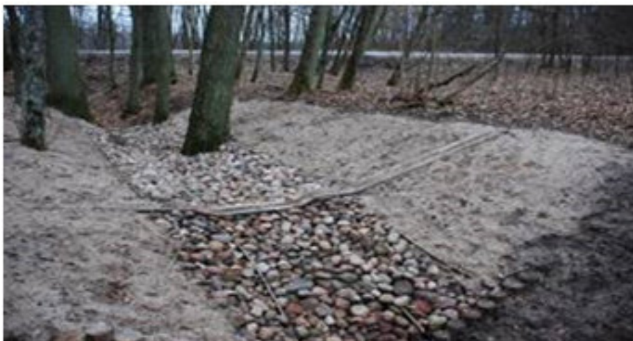
Bystrzok faszynowo-kamienny z drewnianą ścianką szczelną i palisadą drewnianą w Nadleśnictwie Strzałowo (fot. M. Goździk)
