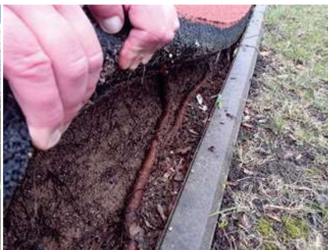
4. Korzenie pod wierzchnią warstwą nawierzchni
