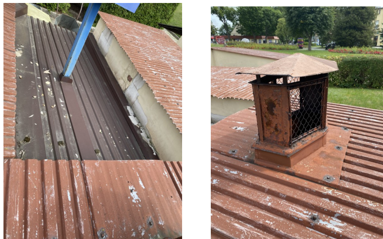
Ilustracje 2-3: Stan dachu toalet miejskich
