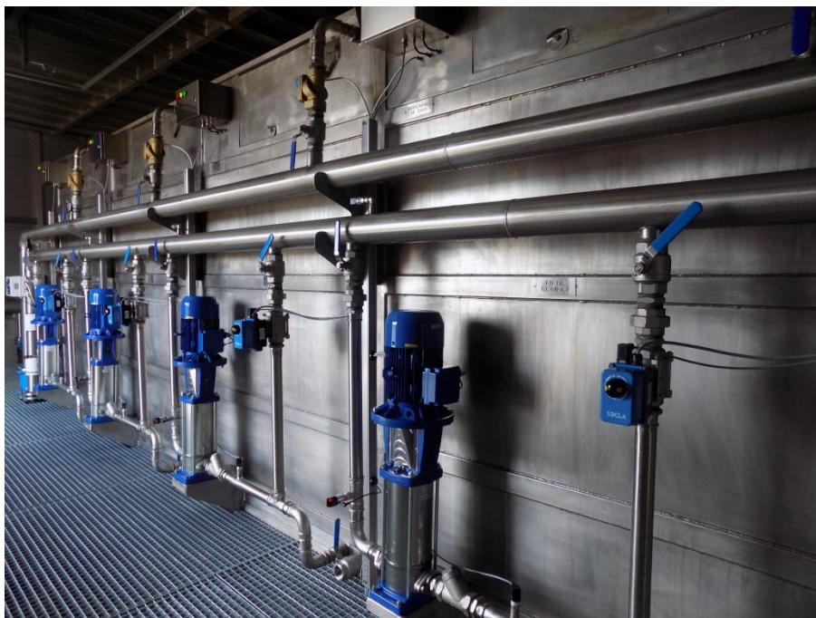
System sterownia pracą filtrów
