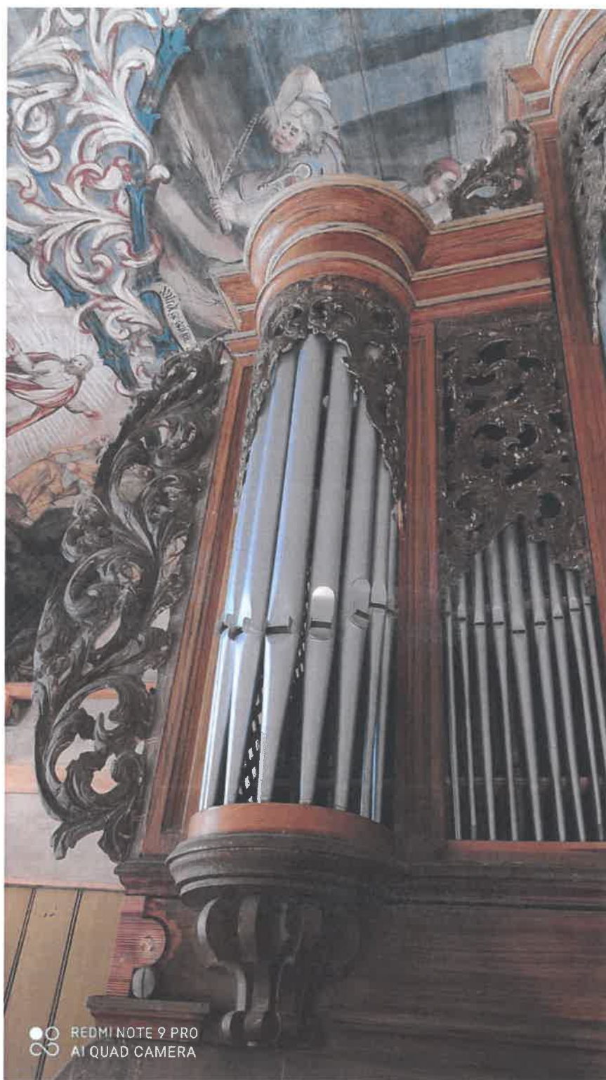
Zdj.4. Prospekt organowy XVIII w., kościół p.w. Świętej Trójcy, parafia Sokolowiec, gm. Świerzawa, woj. dolnośląskie. Akantowa dekoracja rzeźbiarska w całości przemalowana brunatną farbą, na jej powierzchni widoczne odpryski, pod którymi widać białą warstwę oraz złocenia.
