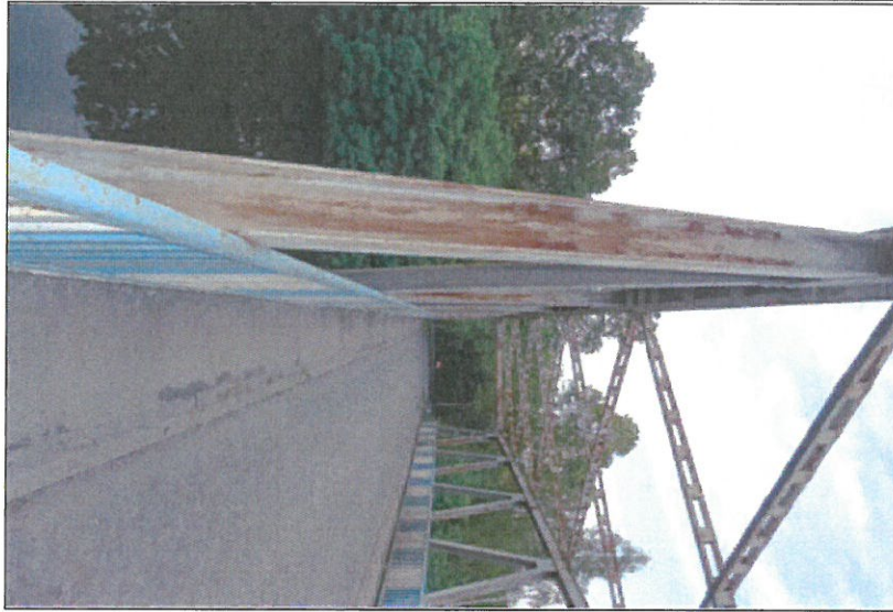
Fot. 21 Łuszczenie się powłoki ochronnej na elementach kratownicy
