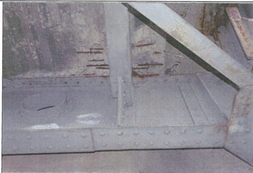
Fot. 32 Ubytki betonu oraz odsłonięte korodujące zbrojenie płyty pomostowej
