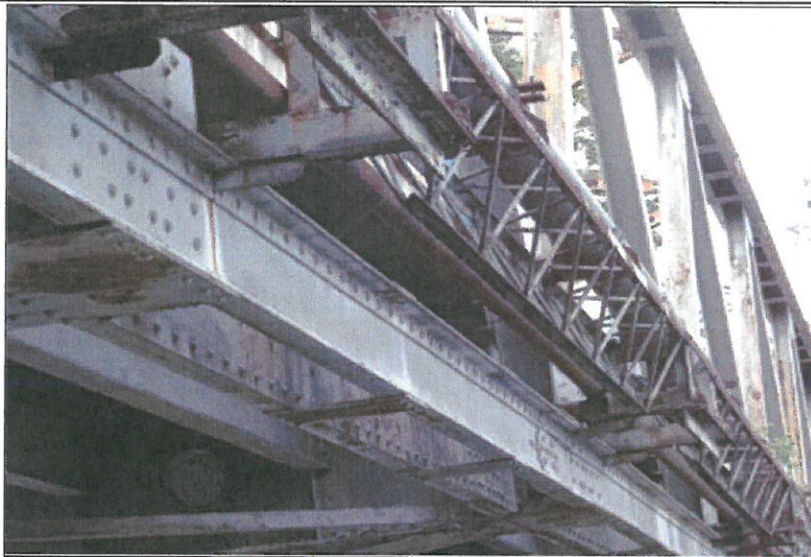
Fot. 8 Korozja rur osłonowych od urządzeń obcych
