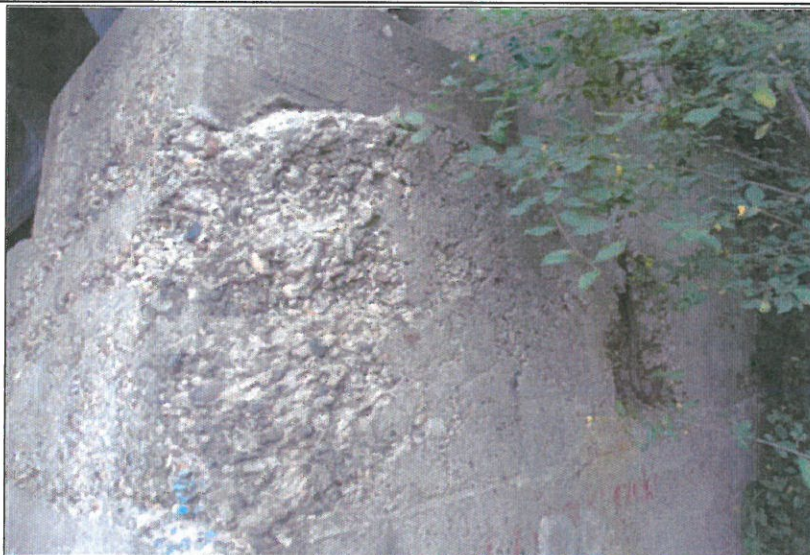
Fot. 30 Degradacja powierzchniowa przyczółku
