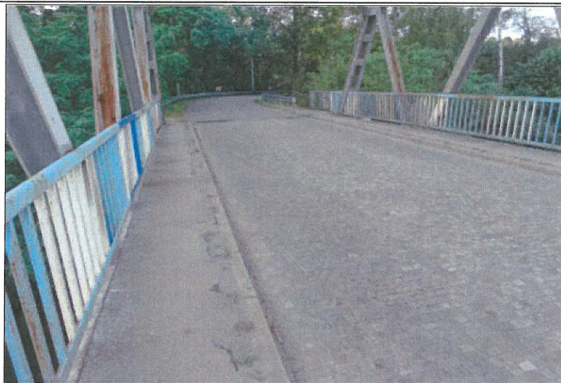
Fot. 24 Rozluźnienie i brak wypełnienia spoin kostki kamiennej na nawierzchni
