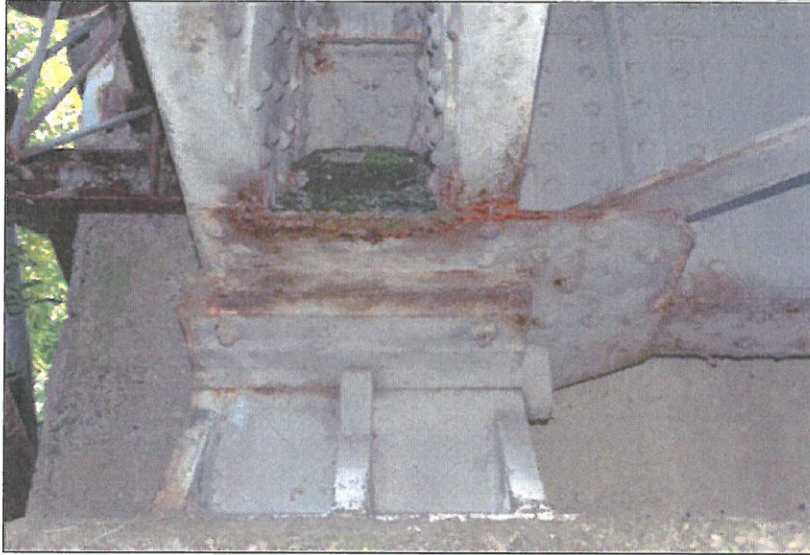
Fot. 9 Zanieczyszczenia wężła oraz korozja elementów łożyska
