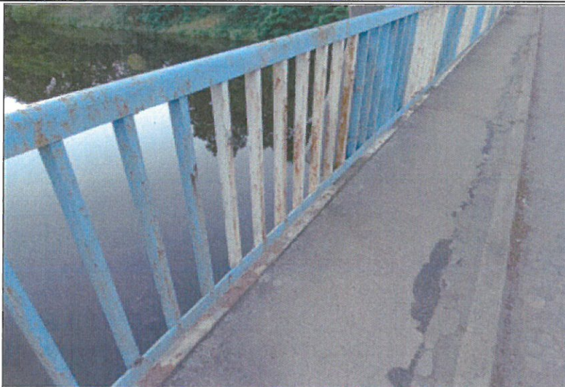
Fot. 18 Łuszczenie się powłoki ochronnej i korozja na balustradzie
