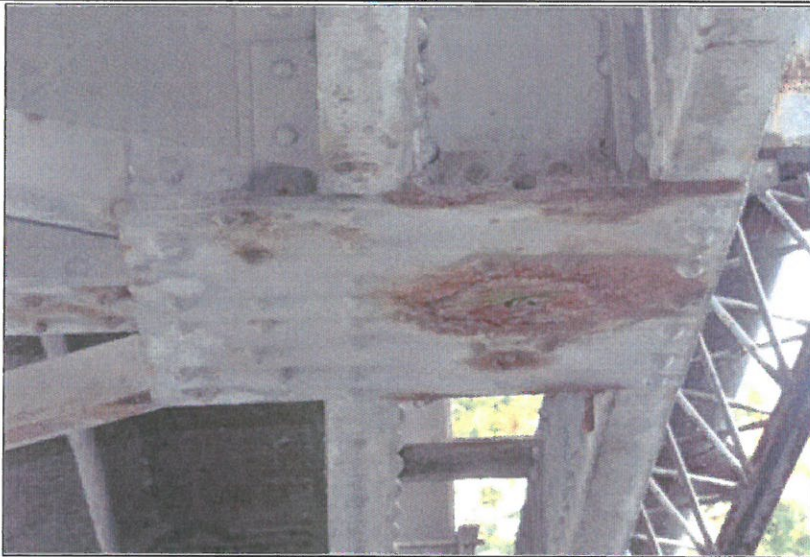
Fot. 10 Korozja blach węzłowych
