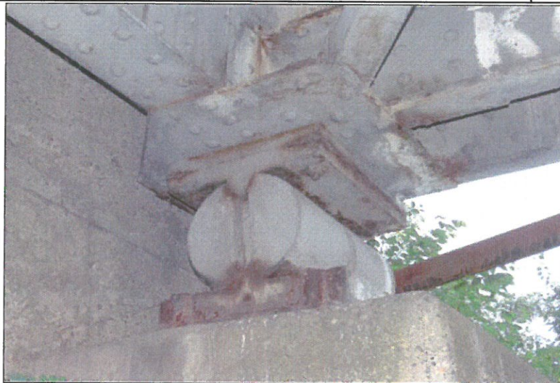
Fot. 31 Korozja powierzchniowa elementów łożyska
