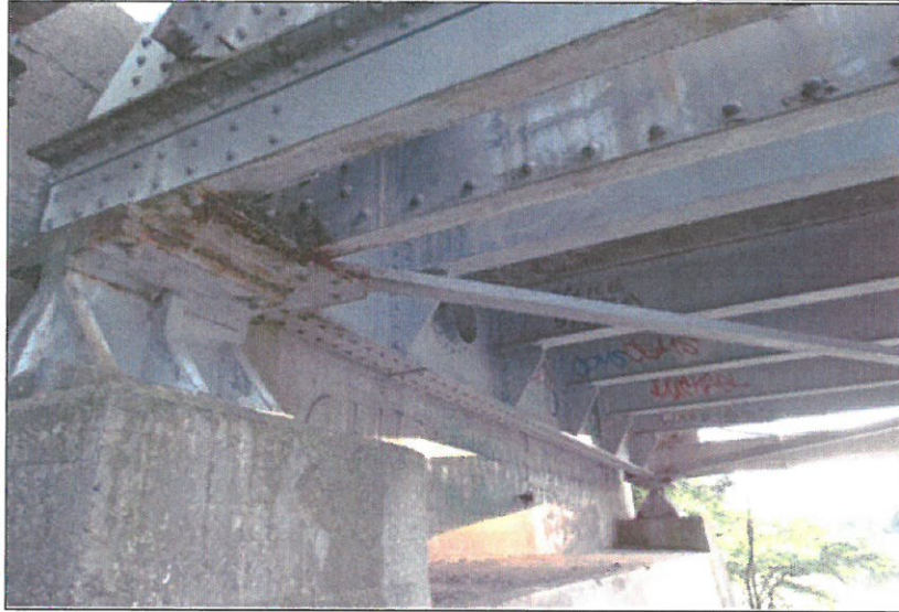
Fot. 7 Korozja blach węzłowych nad łożyskami
