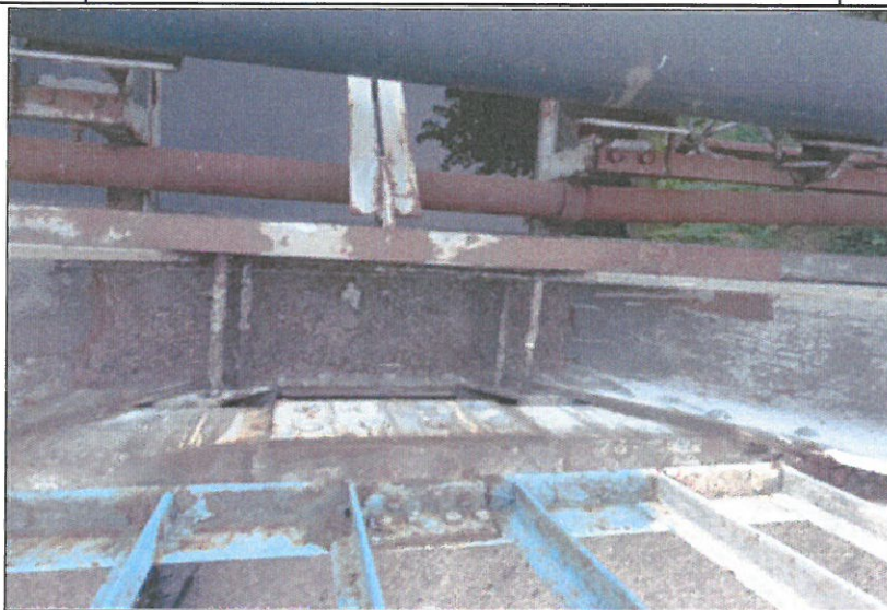
Fot. 29 Zanieczyszczenia węzła kratownicy
