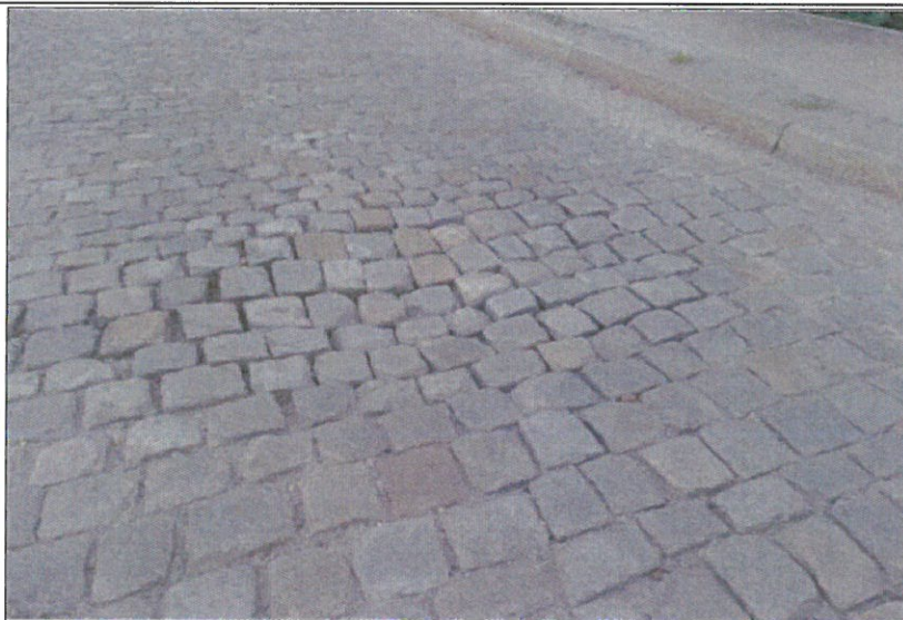
Fot. 28 Nierówności, rozluźnienie i brak wypełnienia spoin kostki kamiennej na nawierzchni
