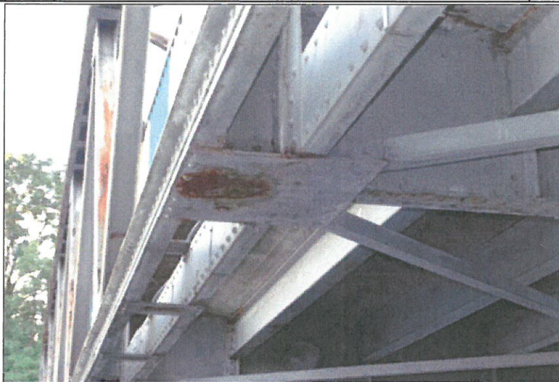
Fot. 13 Korozja blachy węziowej
