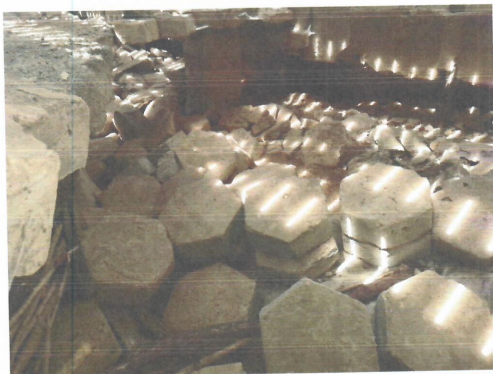
Fot.16 Widok uszkodzonego nabrzeża
