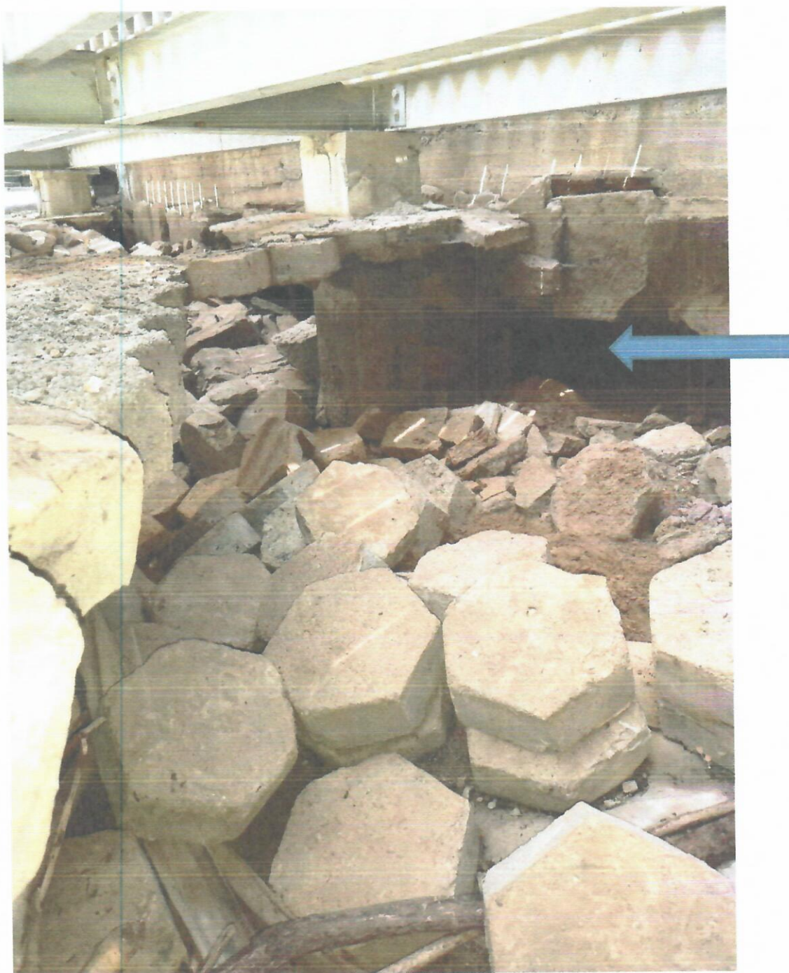
Fot. 8 Zapadnięty fragment umocnienia nabrzeża przy zachodniej części utwardzonego placu. Podbudowa na której ułożono umocnienie opadła miejscami nawet o 1.3 m.
