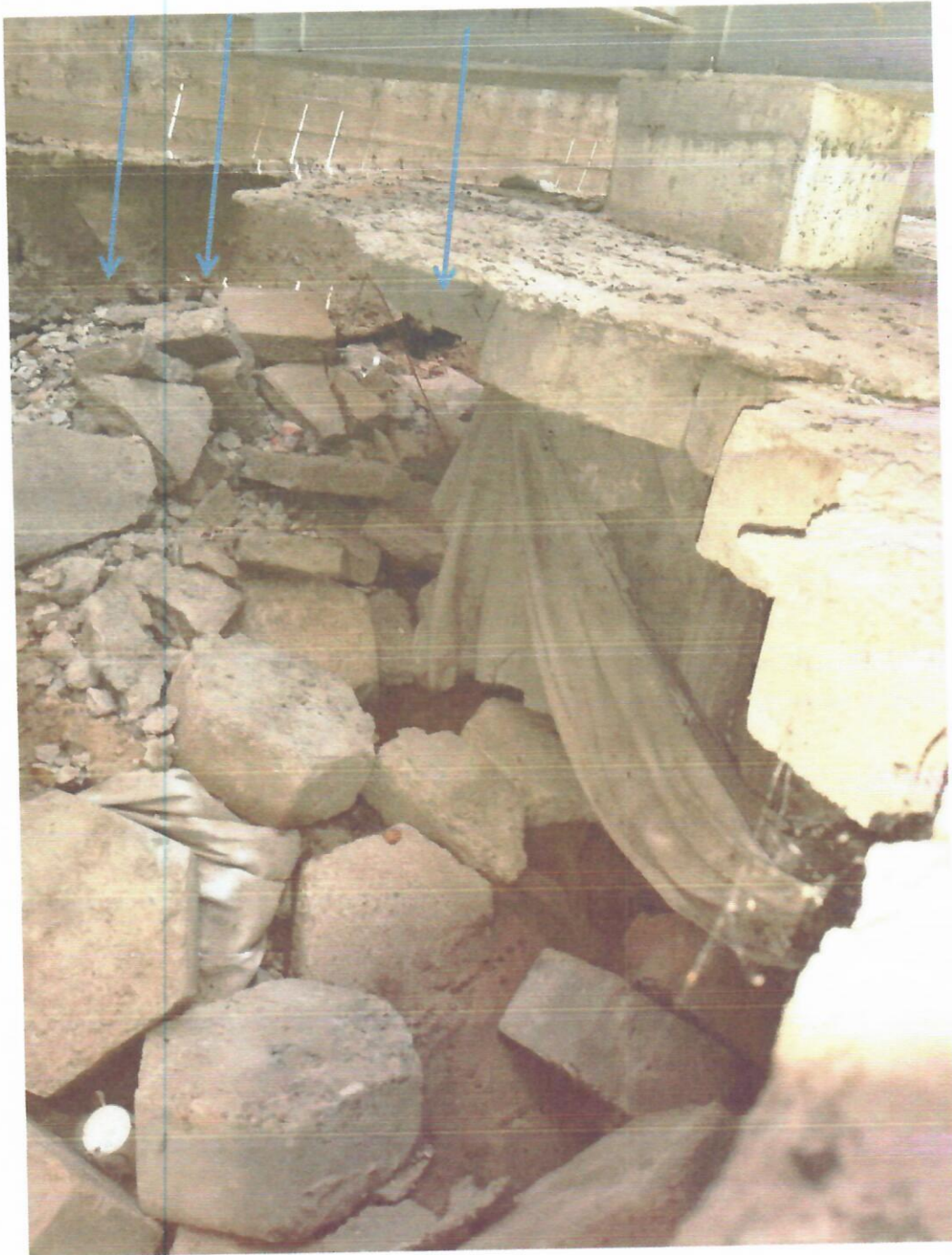
Fot.7 Zarwany fragment środkowy umocnienia w pobliżu słupa podpierającego konstrukcję mola. Widoczne fragmenty geowłókniny. Strzałkami oznaczono miejsce spływu wód opadowych ze ściany oporowej
