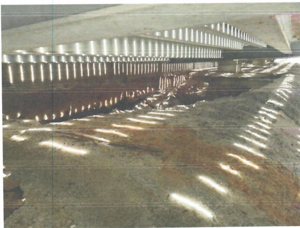
Fot.19 Widok uszkodzonego nabrzeża
