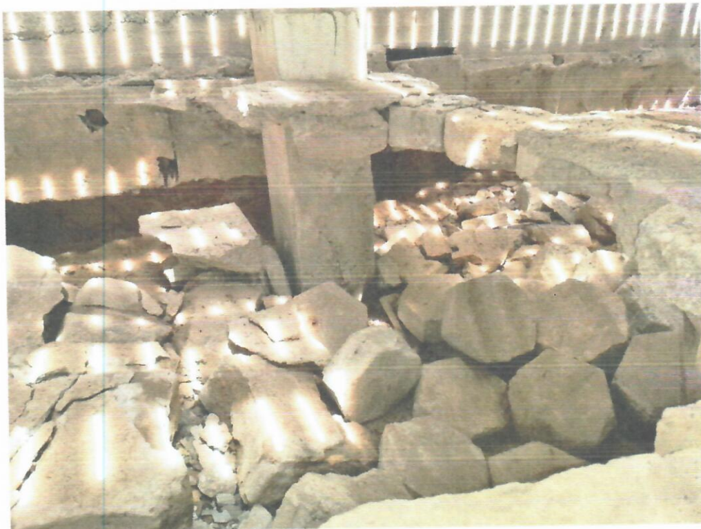
Fot.18 Widok uszkodzonego nabrzeża
