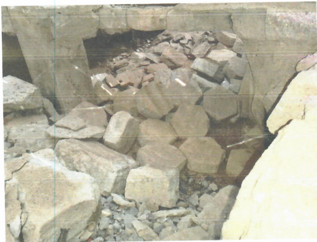
Fot.9 Zarwane umocnienie w części zachodniej nasady moła
