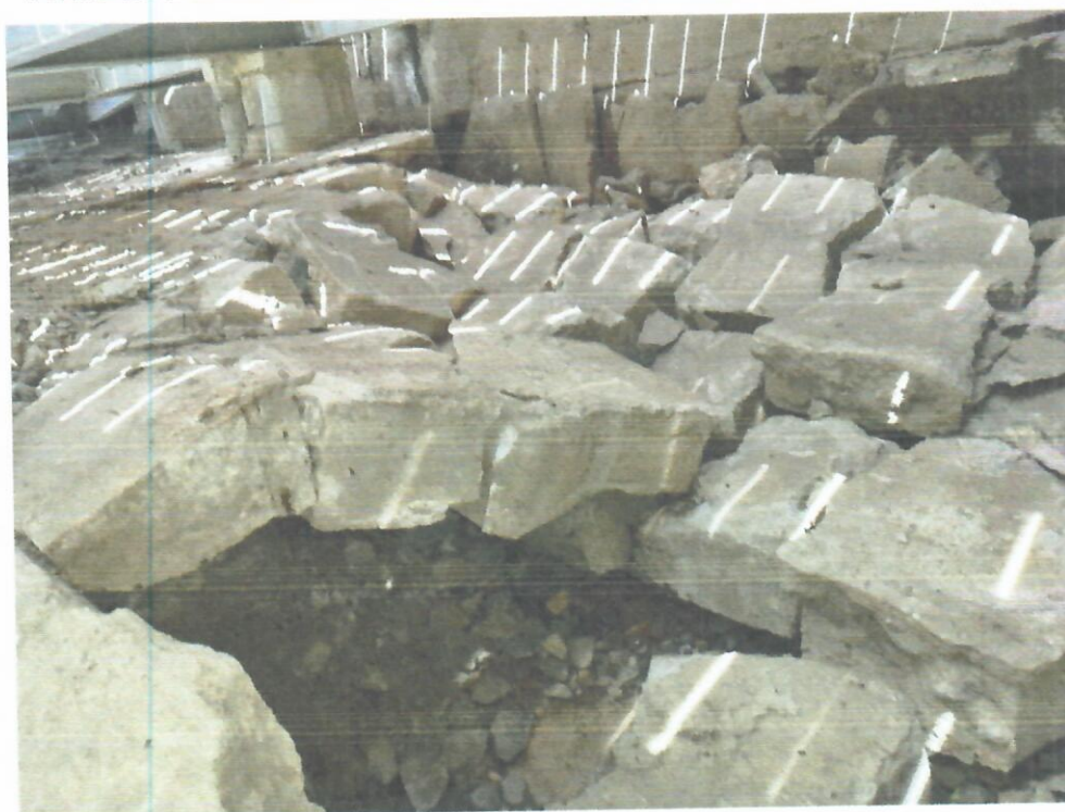
Fot.10 Widok uszkodzonego nabrzeża
