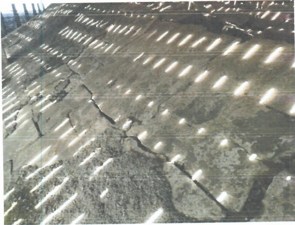
Fot.17 Widok uszkodzonego nabrzeża
