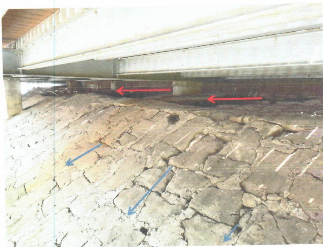
Fot. 5 Wschodnia część uszkodzonego umocnienia z zaznaczeniem miejsc przelewania się wód opadowych przez wymyte spoiny w części pochylej
