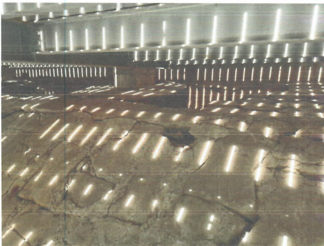
Fot.13 Widok uszkodzonego nabrzeża
