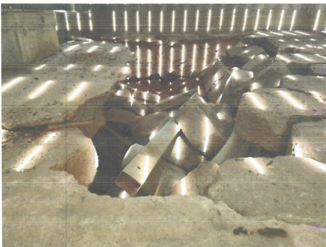
Fot.14 Widok uszkodzonego nabrzeża
