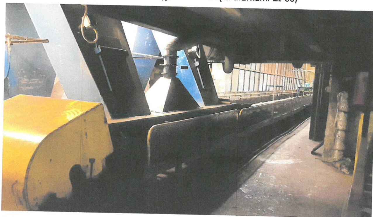
Galeria nawęglania w kotłowni (CŁII)
