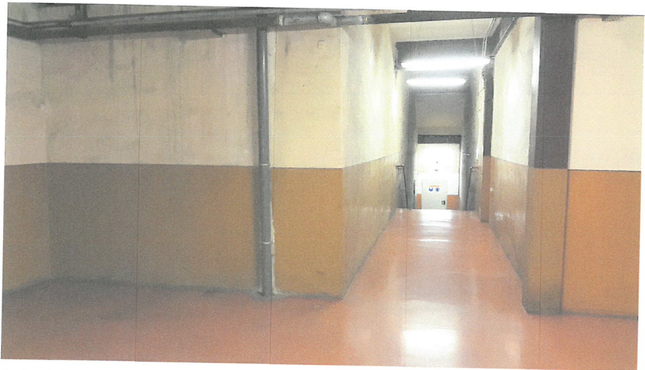
Parter BW w kierunku budynku CŁ I zakończony drzwiami z odpornością ogniową.
