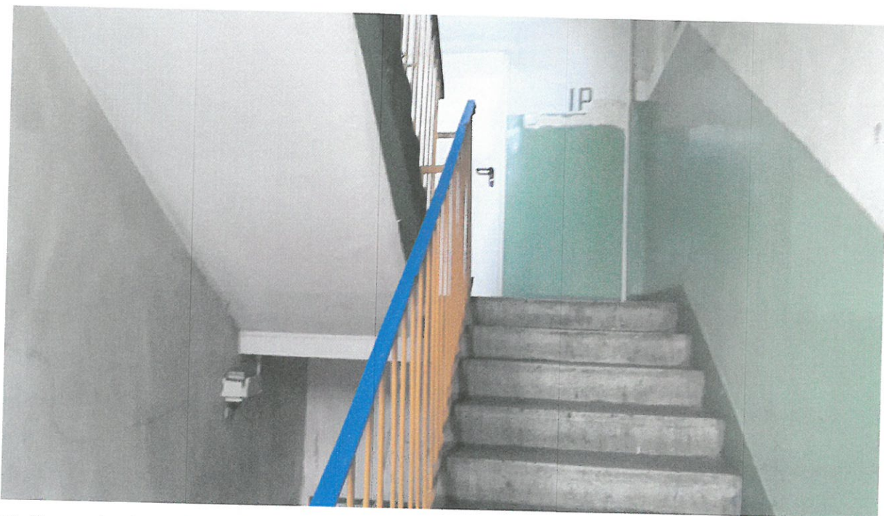
Klatka zachodnia oddymiana grawitacyjnie i zamknięta drzwiami EI 60,
