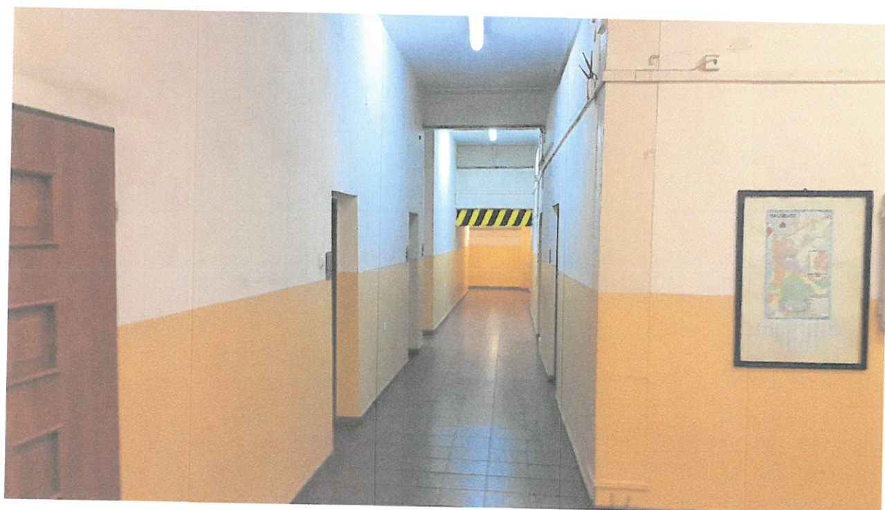
Trzecie piętro BW- korytarz w kierunku kotłowni (CŁII) bez przejścia. Widoczne elementy stalowe konstrukcji – niezabezpieczone przeciwogniowo.
