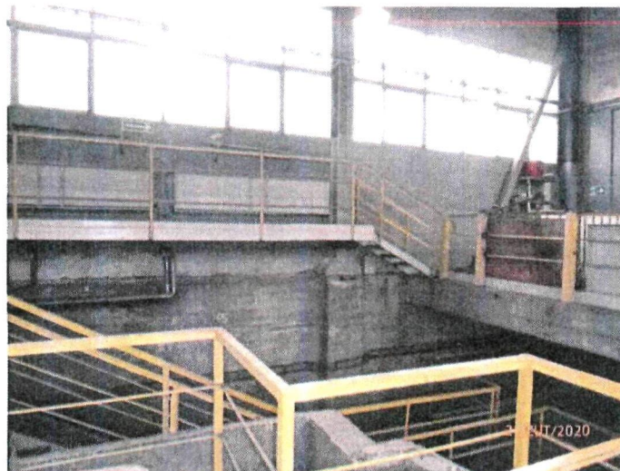
Fot. 7. Wnętrze budynku – podesty obsługowe
