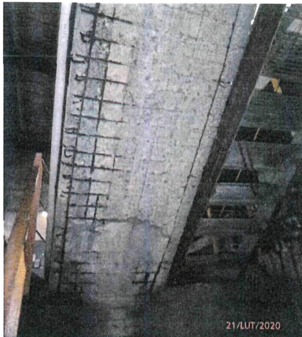
Fot. 6. Ubytki otuliny zbrojenia
