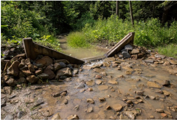
Próg powyżej brodu ukierunkowujący wodę na bród.
