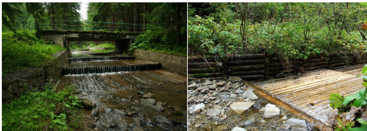
Stopnie wykonane z belek wzdłuż cieku przerywające ciągłość biologiczną. Źródło: Archiwum CKPS
