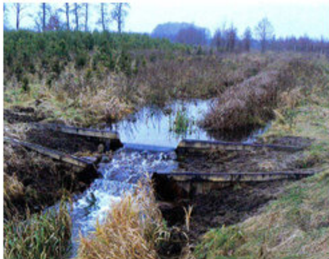
Próg z dwiema ściankami szczelnymi, wypełniony ziemią – brak ubezpieczenia progu dolnego od strony wody dolnej. Źródło: „Natura a gospodarka wodna” P.Kowalczyk, P.Niezanński, R.Stańko, F.M.Mas, M.B.Sanz, 2009 r.
