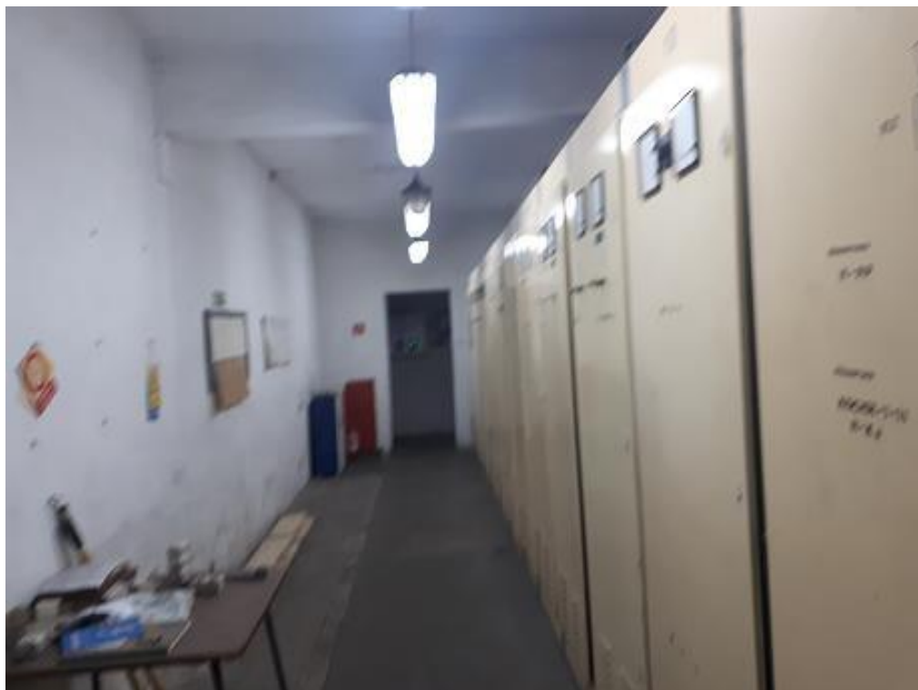
Rysunek 13. Budynek istniejącej kotłowni rozdzielnia nN
