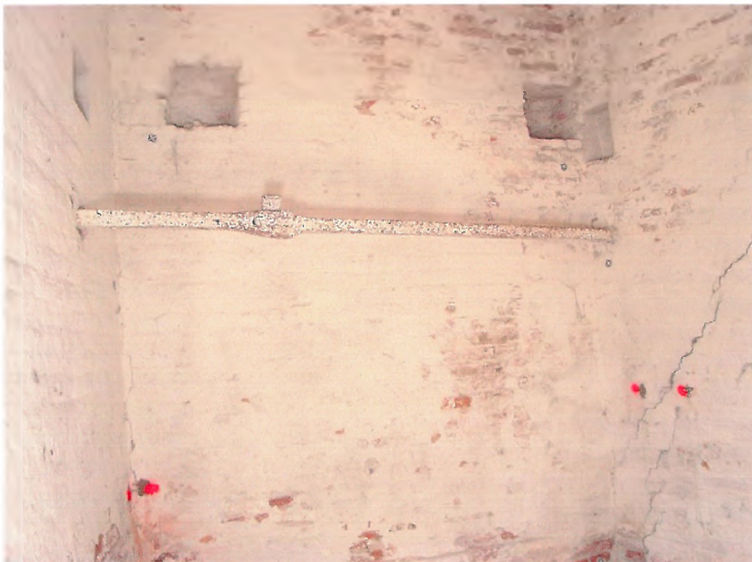
Zdj. 12 Anker stężący ściany bastionu w pomieszczeniach od strony Muru Fosbrei Północnego; widoczne zarysowania ściany zewnętrznej bastionu (na zdjęciu po prawej stronie)
