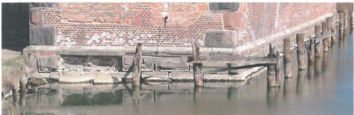
Fot. 5 Szczegół fundamentu z widoczną zniszczoną drewnianą palisadą
