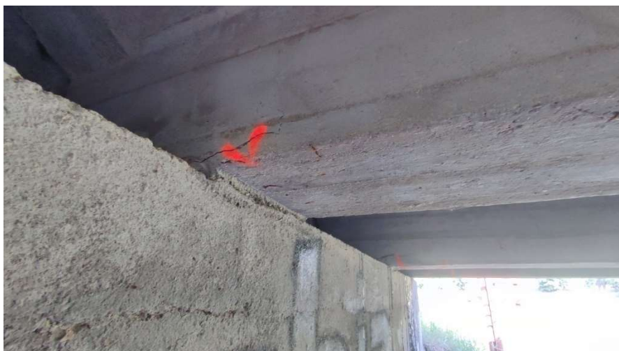
Fot nr. 4 Widok dźwigara w strefie podparcia od strony Chojnic. Widoczne spękania oraz brak szczepności w obrębie podparcia.
