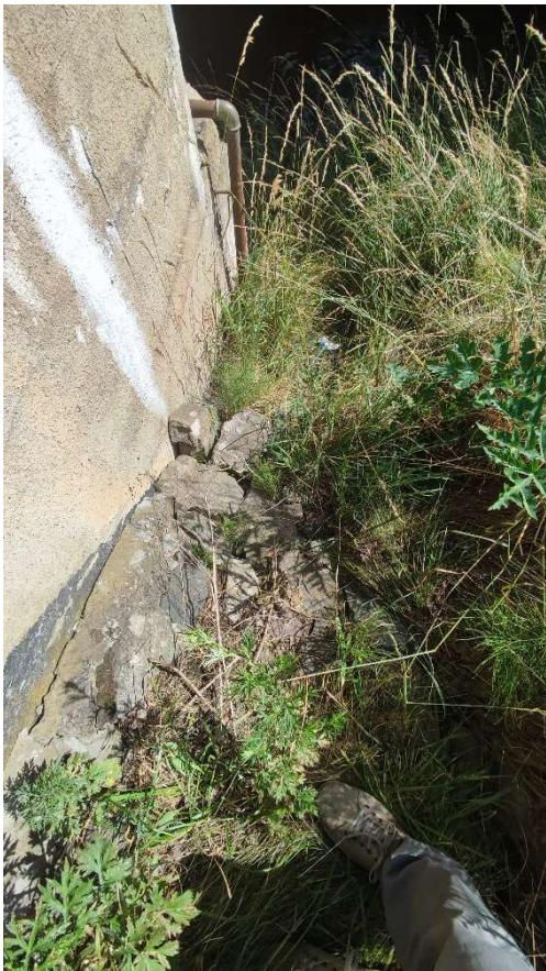
Fot nr. 10 Widok uszkodzonego ciekia kamiennego od str. dolnej wody.
