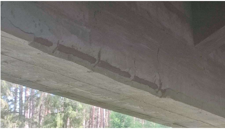
Fot nr. 8 Widok dźwigara odkryte zbrojenie główne od strony górnej wody.
