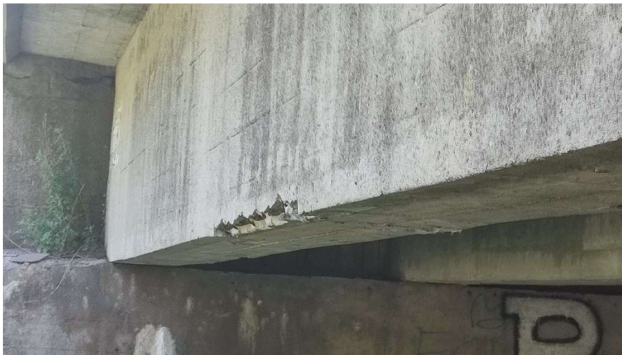
Fot nr. 6 Widok dźwigara lokalny ubytek w dźwigarze od strony dolnej wody.
