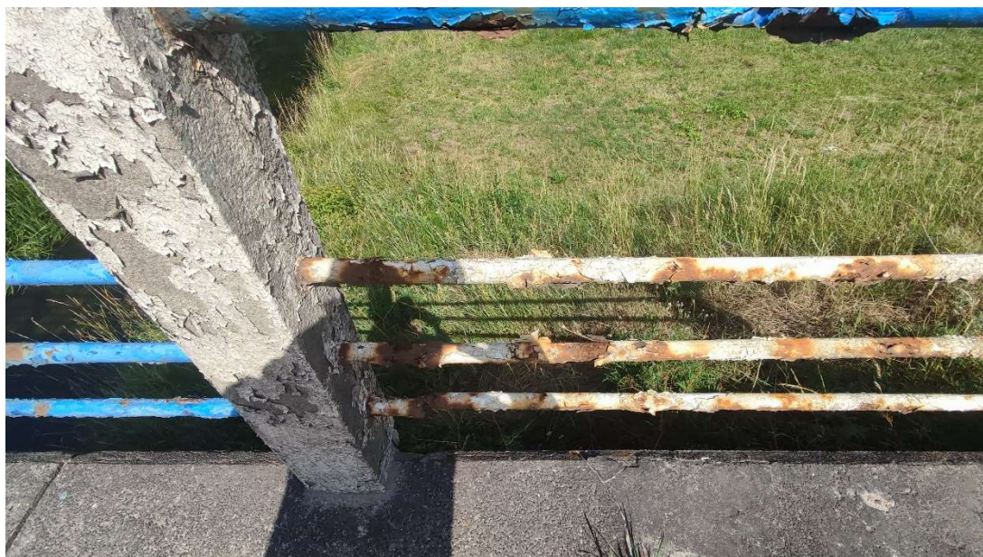
Fot nr. 1 Widok elementów balustrady od strony Korne (prawa strona zgodnie z kilometrażem)
