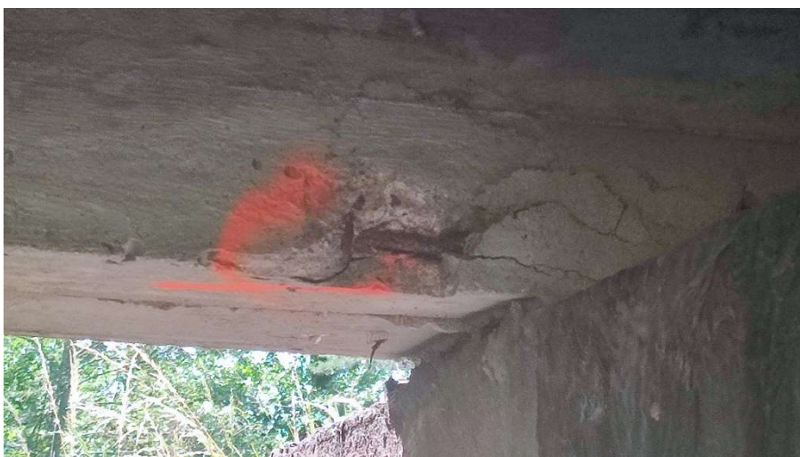
Fot nr. 6 Widok dźwigara lokalny ubytek z korodującym zbrojeniem głównym.
