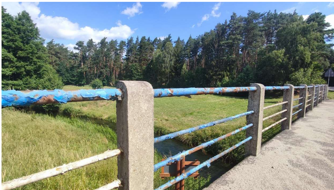
Fot nr. 2 Widok ogólny balustrad – liczne ślady złuszczonej farby i postępującej korozji na powierzchni rur \varnothing 63,5\text{mm} i \varnothing 33,7\text{mm} .
