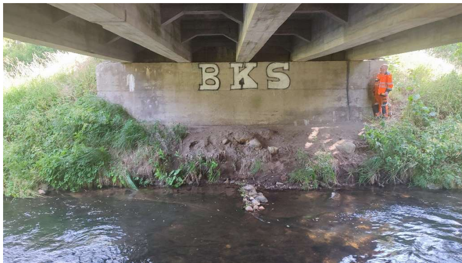
Fot nr. 11 Widok strefy podparcia od strony Kościerzyny – brak umocnień
