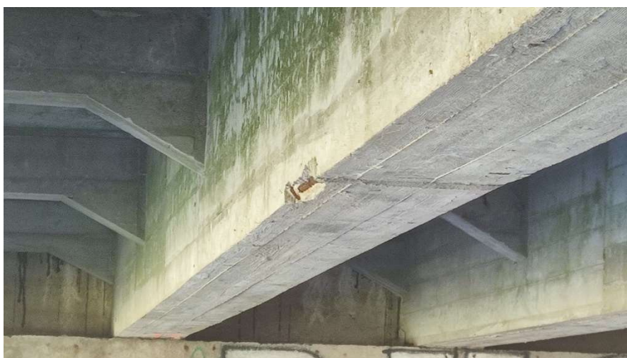
Fot nr 5 Widok dźwigara lokalny ubytek w strefie piątej poprzecznicy od strony Chojnic
