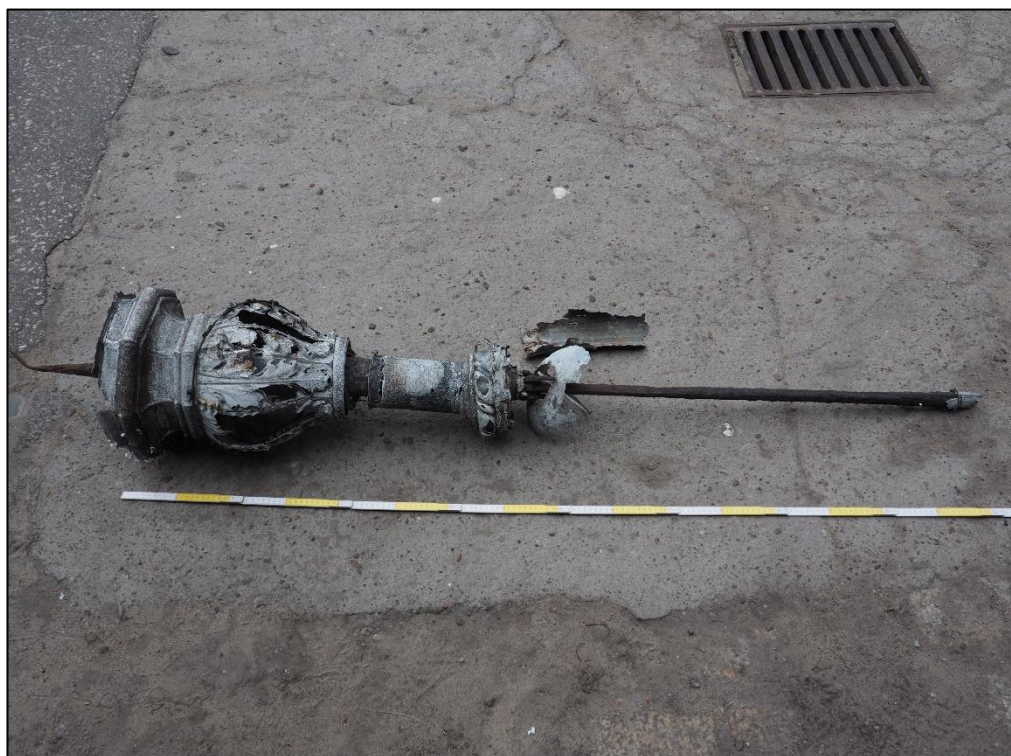
Fot. nr 15. Zdemontowana iglica ze zwieńczenia wykusza. Widok ogólny obrazujący stan zachowania.
