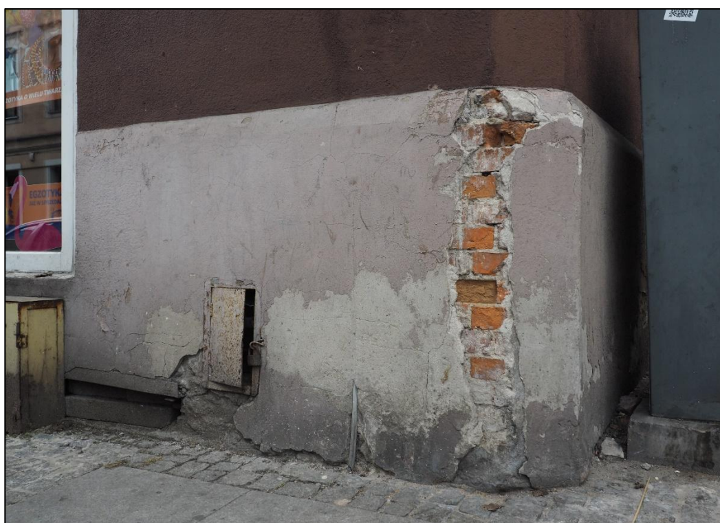
Fot nr 2. Część przyziemia, cokół od ul. Pańskiej. Widoczne rozległe ubytki wytrawy tynkarskiej i dezintegracja cegły w narożniku.
