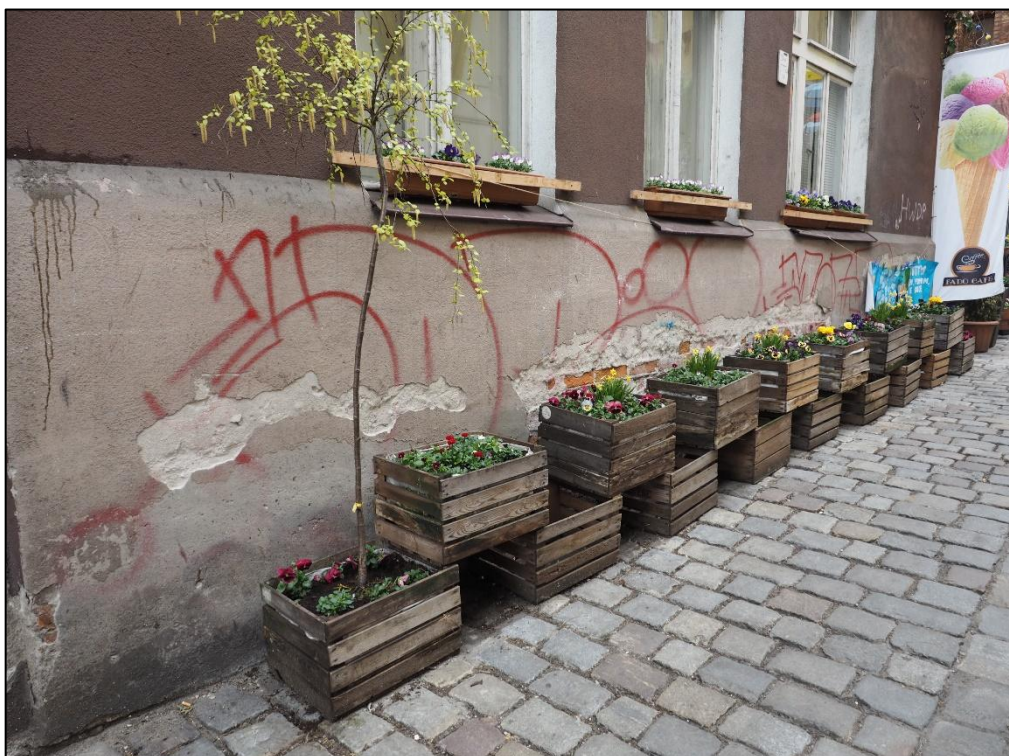
Fot. nr 5. Część przyziemia od ul. Reja. Widok obrazujący rozległe zniszczenia charakterystyczne związane z podciąganiem wody z gruntu oraz zasoleniem. Ubvtki zaprawv. ceętv i brak spoistości materiałów budowlanvch.
