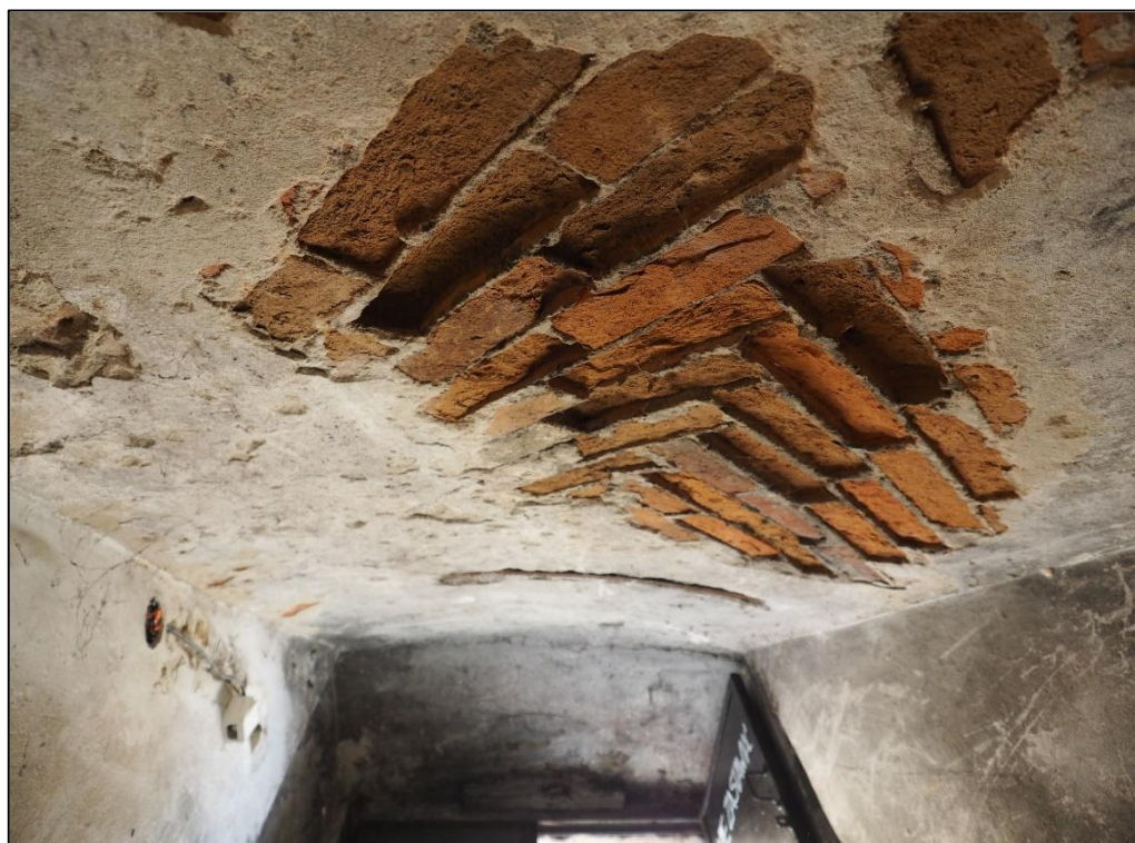
Fot. nr 7. Wnętrze piwnicy gotyckiej. Widok na sklepienie nad schodami wejściowymi od ul. Reja. Widoczna dezintegracja cegły i zaprawy tynkarskiej.
