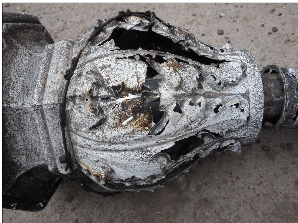
Fot. nr 16. Zdemontowana iglica ze zwieńczenia wykusza. Zbliżenie na dolną partię obrazujące silną dezintegrację metalu (cynk, cyna), rozległe ubytki oraz utlenienie powierzchni.
