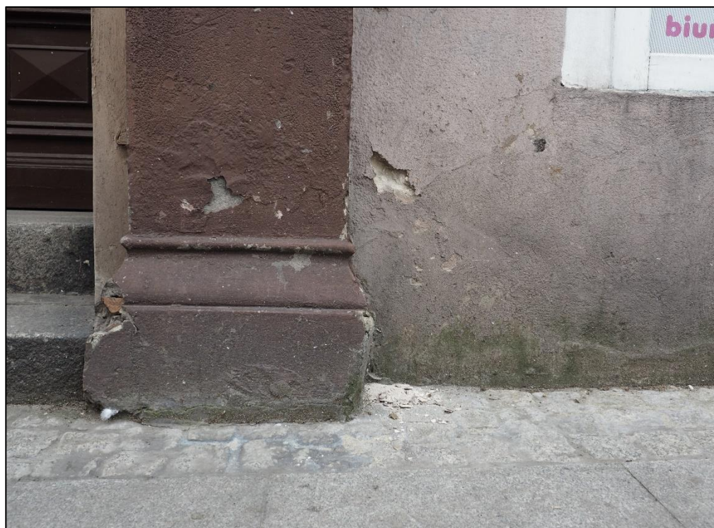
Fot nr 4. Strefa przyziemia przy ul. Pańskiej. Fragment obrazujący uszkodzenia tynku cokołu muru: osypywanie, ubytki, korozja biologiczna oraz uszkodzenia partii cokołowej portalu gł.: ubytki w narożnikach, odpajanie się warstw malarskich.
