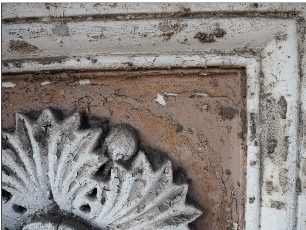
Fot. nr 9. Fragment dekoracji rozetowej. Widoczne silne zniszczenia warstw malarskich na sztukaterii.
