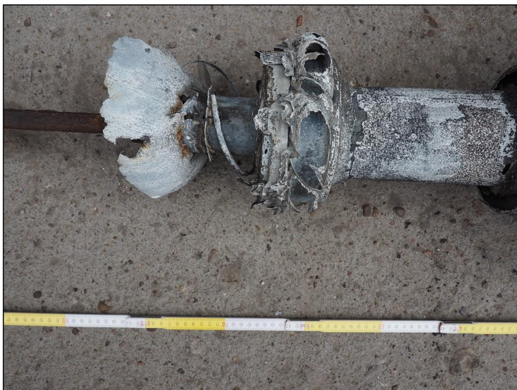
Fot. nr 17. Zdemontowana iglica ze zwieńczenia wykusza. Widok na środkową partię z śladowo zachowaną dekoracją wieńca. Widoczne rozległe ubytki metalu.
