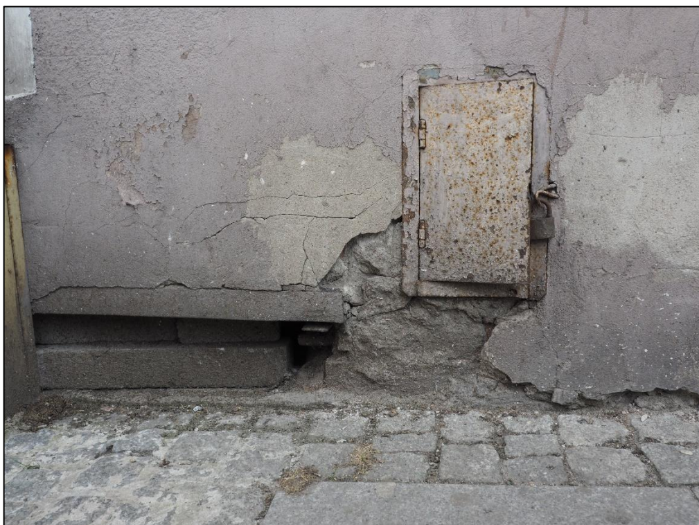
Fot nr 3. Strefa przyziemia od ul. Pańskiej. Widoczne silne spękania i ubytki tynku.
