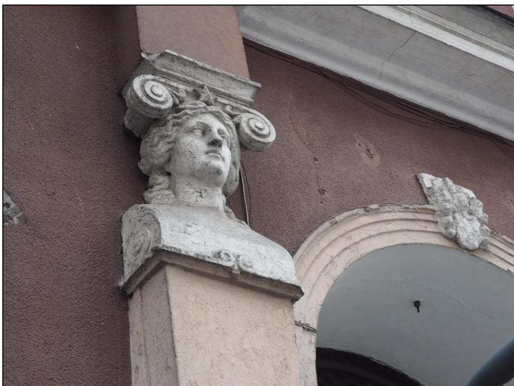
Fot nr 10. Portal główny przy ul. Pańskiej. Głowica pilastra w formie popiersia kobiecego i wolut jońskich z gwiazdą. Widok obrazujący zniszczenia warstw malarskich, drobne ubytki. Na zdjęciu widać kliniec z herbem powyżej wejścia; wykazuje silne zatarcie formy.
