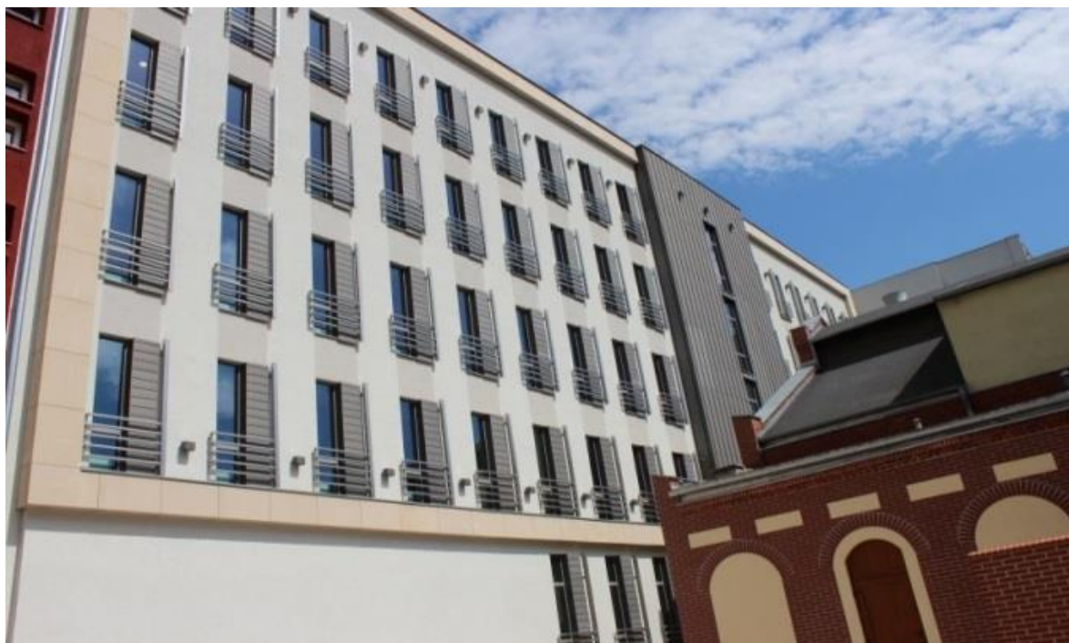
Rys. 2. Zdjęcie przedstawia budynek U na którym znajdują się okna z elementami metalowymi oraz część elewacji wykonanej z blachy ocynkowanej
