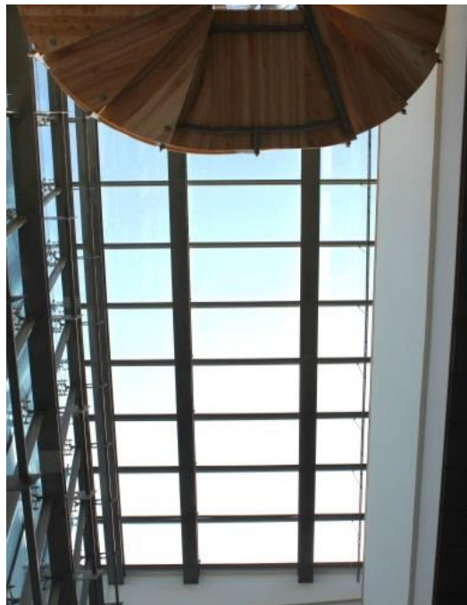
Rys. 4. Widok na świetlik w budynku U, który należy umyć z obu stron (tj. zewnętrznej i wewnętrznej)
