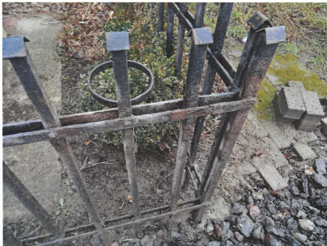
7. Stan zachowania ogrodzenia kapliczki - widoczna korozja.
