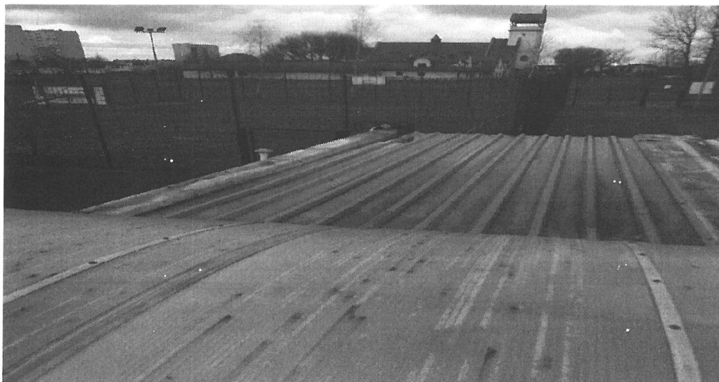
Fot. 19 Ślady uszkodzeń w postaci otworów na zadaszaniu między budynkami z poliwęglanu
