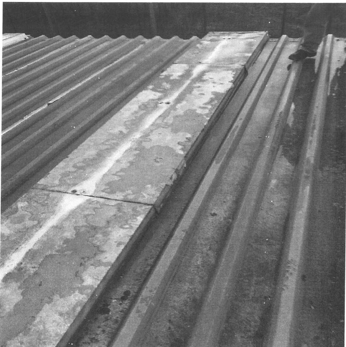
Fot. 6 Złe połączenia obróbek blacharskich na przerwie dylatacyjnej , zastoiska wody na pokryciu dachowym przyczyną przecieków.
