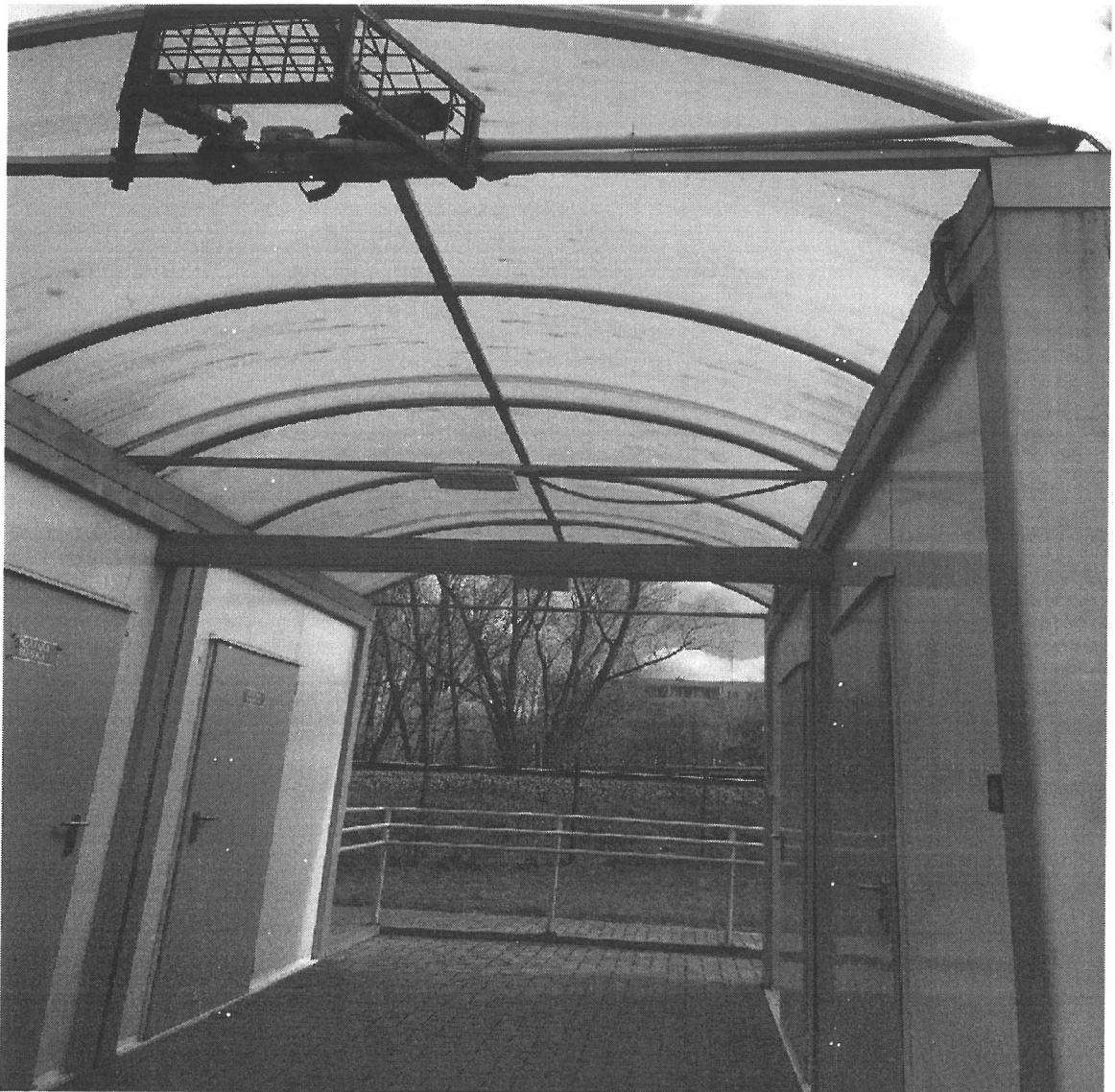
Fot. 8 Nieszczelności pokrycia z poliwęglanu „dziury” na wylot, łuszcząca się farba na konstrukcji zadaszzenia, ślady rdzy na konstrukcjach poziomych budynku konterera
