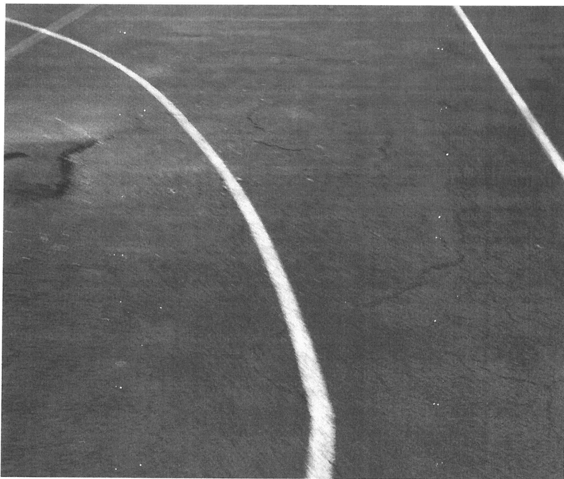
Fot. 1 Rysy i wybrzuszenia nawierzchni z poliuretanu na boisku wielofunkcyjnym
