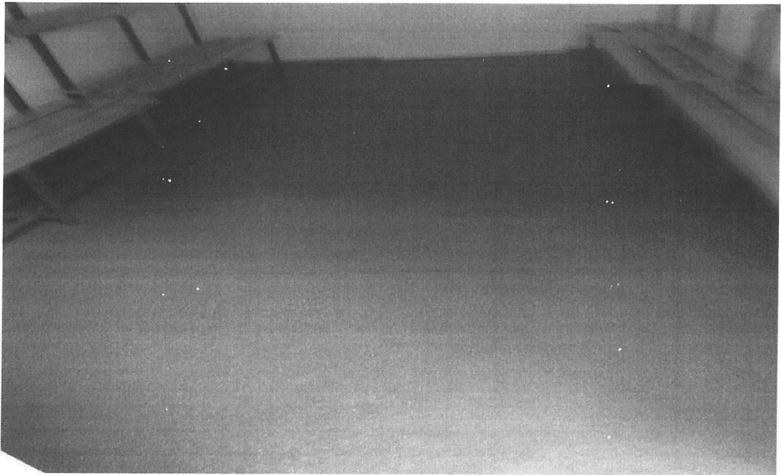
Fot. 12 Pomieszczenie szatni w którym dokonano odkrywki i stwierdzono zawilgocenia płyty OSB, wełny mineralnej
