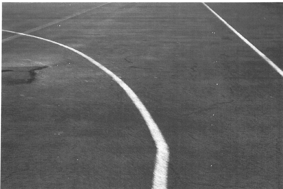
Fot. 4 Liczne rysy, pęknięcia oraz bardzo duże wybrzuszenia na nawierzchni poliuretanowej na boisku wielofunkcyjnym
