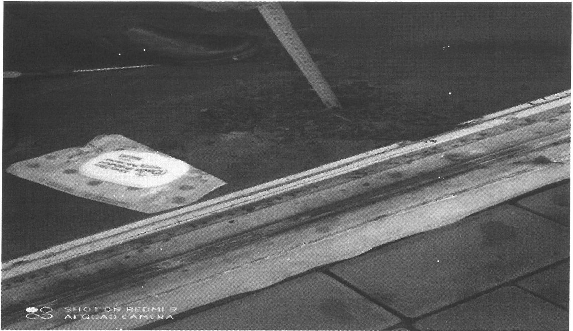
Fot.10 Odkrywka w miejscu zadolenia w pomieszczeniu trenera – zmięknęta płyta podłogowa OSB ( pokruszona )
