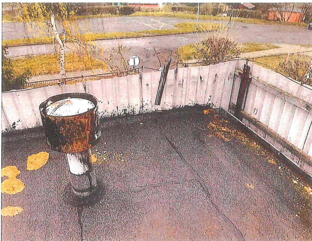
Znaczne zniszczenia atrapy dachu
