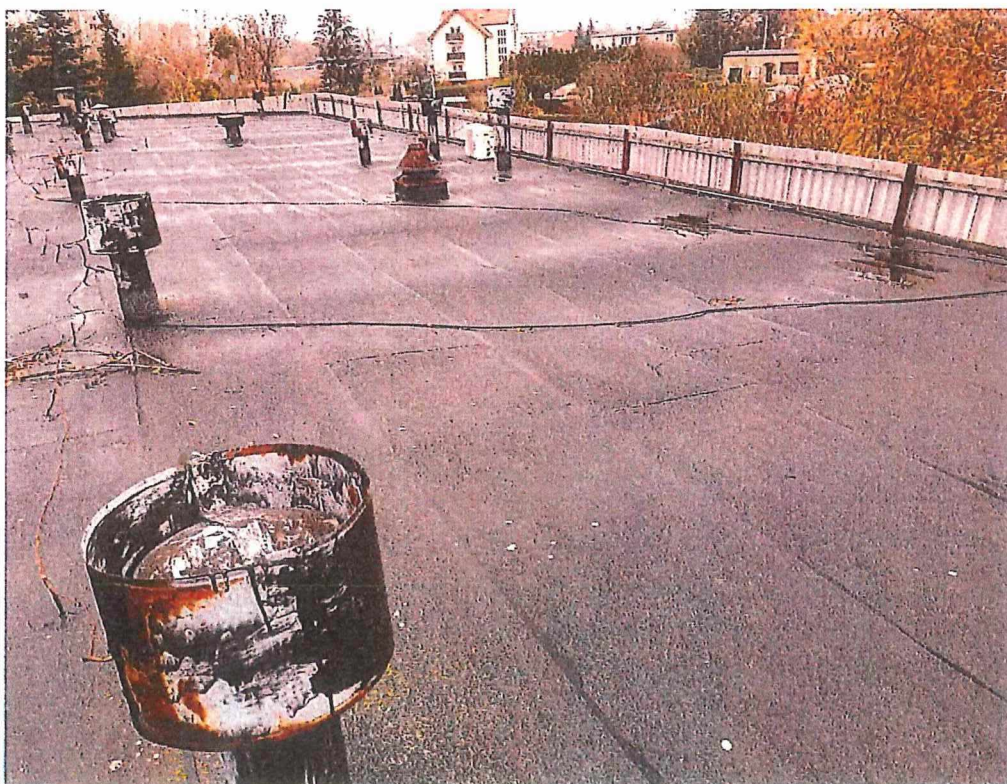
Znaczne ugięcia powierzchni oraz zniszczone (wyeksploatowane) kominki wentylacyjne dachu
