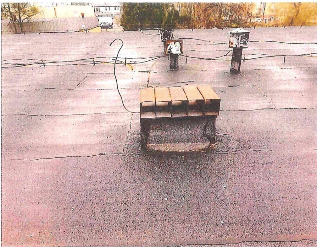
Znaczne ugięcia powierzchni dachu oraz zniszczone kominki wentylacyjne i instalacja odgromowa
