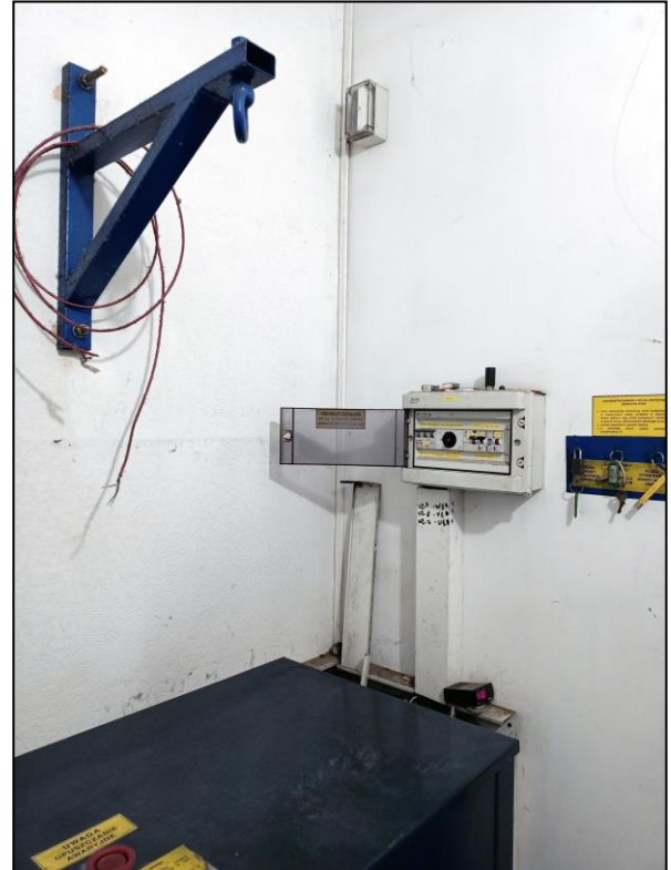
Maszynownia – tablica wstępna (rozdzielnica)
