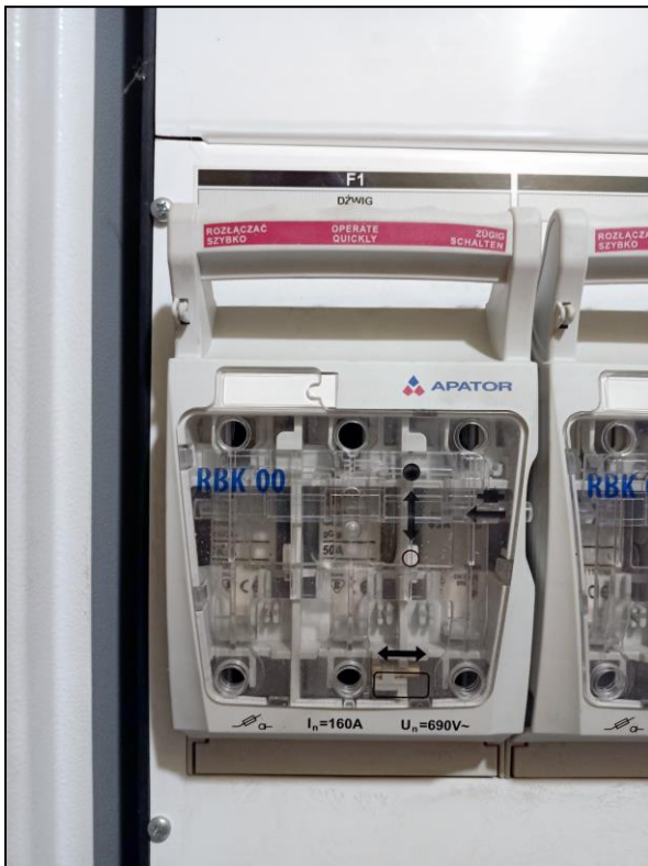
Zabezpieczenie linii zasilającej dźwig w TG znajdującej się w sąsiednim budynku
