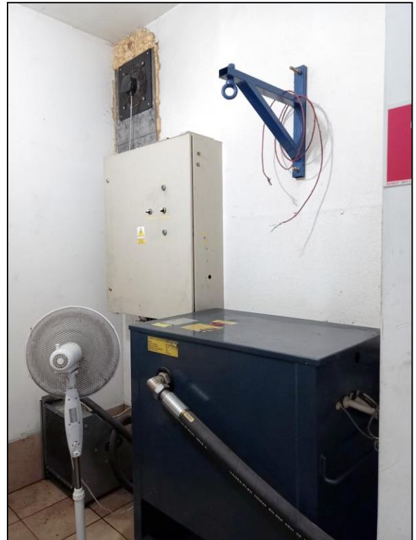
Maszynownia – podzespoły dźwigowe
