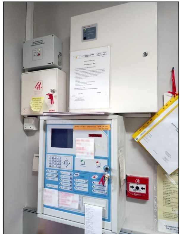
Centrala sygnalizacji pożaru POLON 4200 znajdująca się w dźwurce na wysokim parterze
