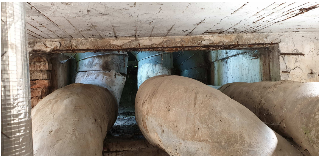
Fot. 3 Uszkodzenia nadproża od strony studzienki.
