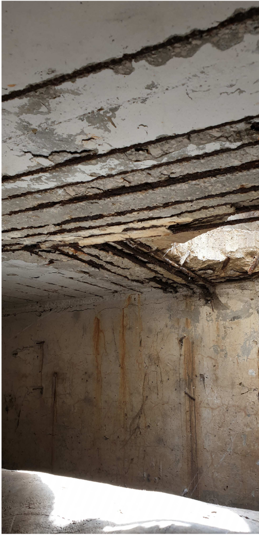
Fot. 1 Korozja betonu i stali zbrojeniowej płyty stropowej komory. Zacieki z rdzy na ścianach.
