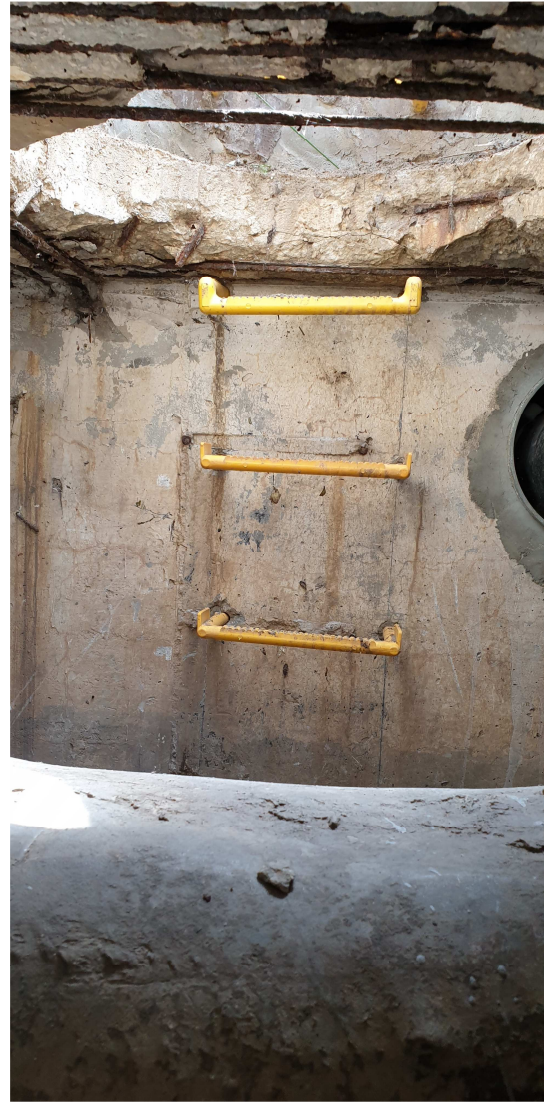
Fot. 2 Osłonięte zbrojenie w rejonie kominka włazowego.
