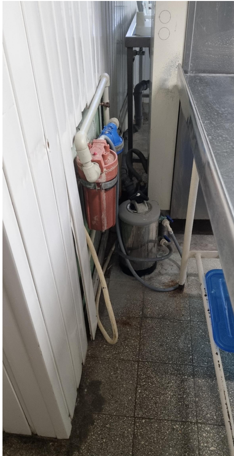
6. Wydawalnia – instalacja zmiękczenia wody
