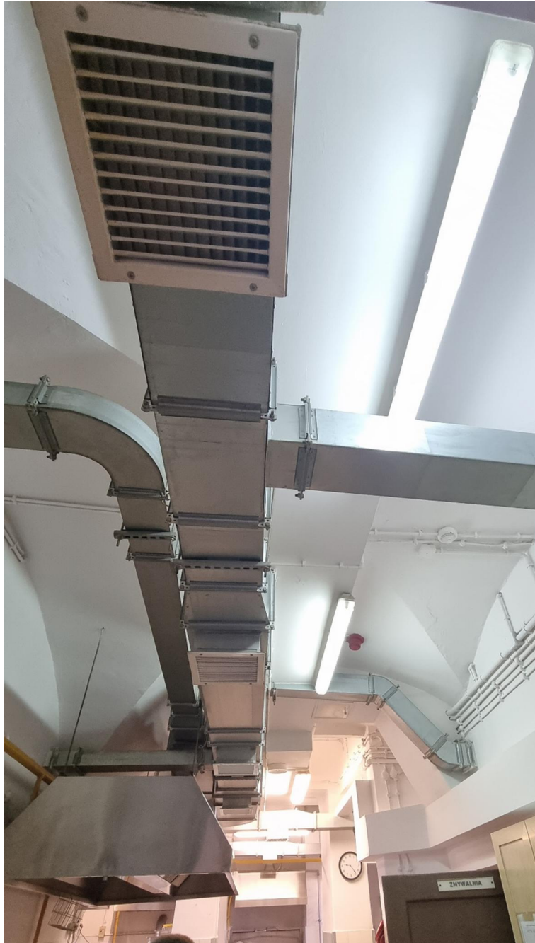
8. Kuchnia – widok instalacji
