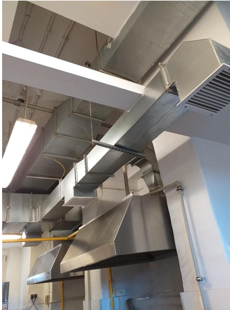
10. Kuchnia – widok instalacji
