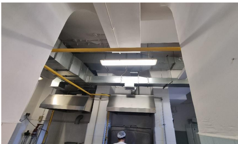
9. Kuchnia – widok instalacji
