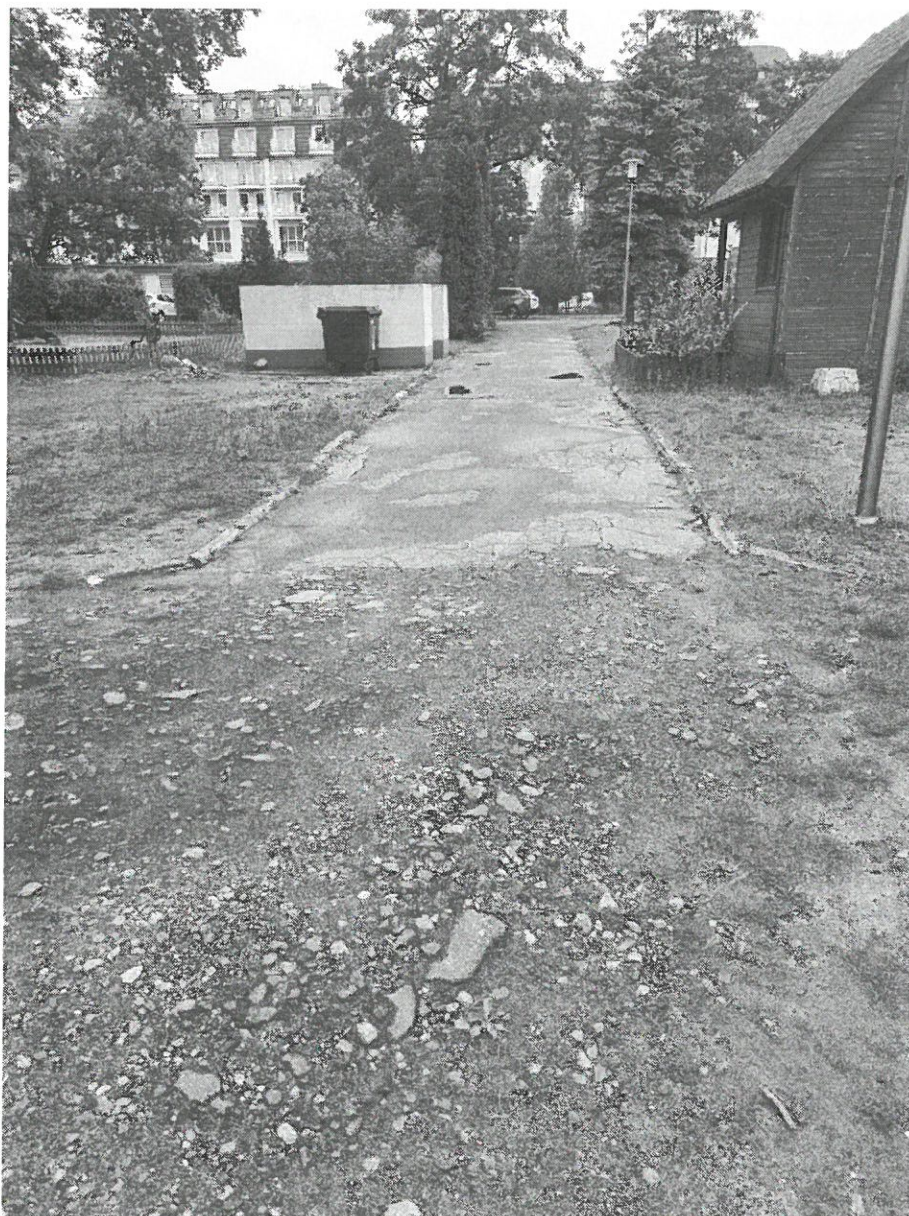
Rys. 1 Kwiecień, droga asfaltowa - do remontu
