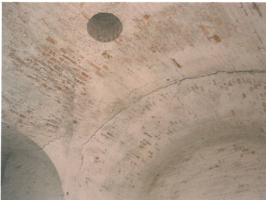
Fot. 9 Spękania sklepienia kazamat od strony Muru Fosbrei Północnego
