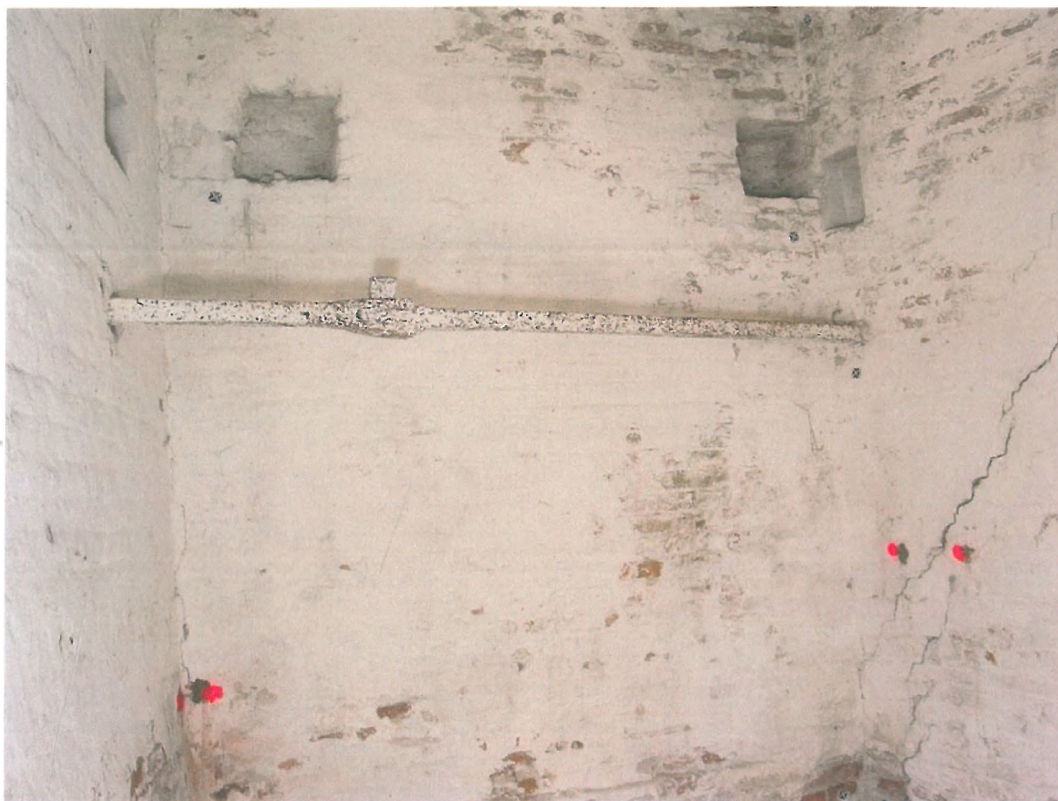
Fot. 10 Ankiel stężający ściany bastionu w pomieszczeniach od strony Muru Fosbrei Północnego; widoczne zarysowania ściany zewnętrznej bastionu (na zdjęciu po prawej stronie)
