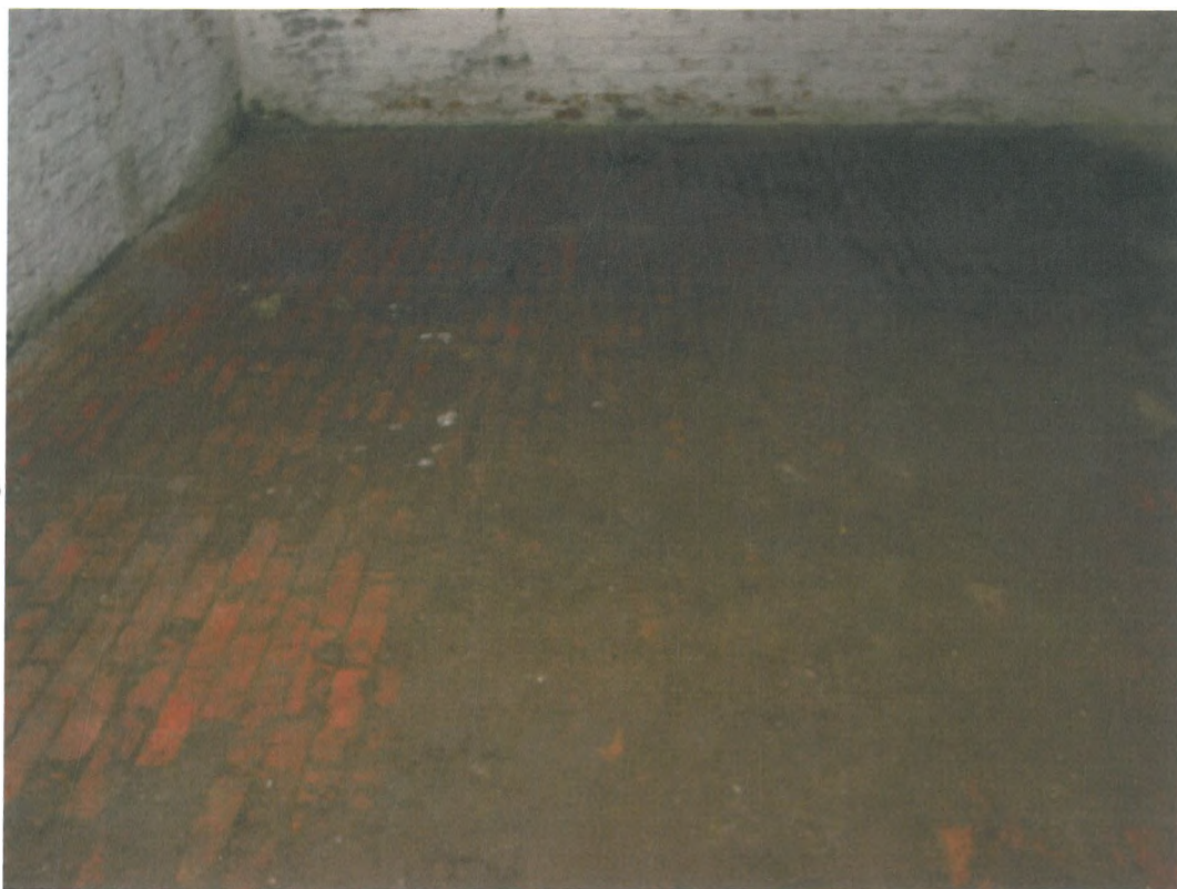
Fot. 8 Posadzka w kazamatach Bastionu Ostroróg. Cegła położona na rąb sugeruje przystosowanie pomieszczenia do składowania przedmiotów o znacznej masie
