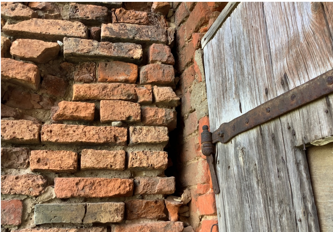
Fot. 32. Nie przewiązana przypora z cegły o zróżnicowanych wymiarach na elewacji zachodniej.
