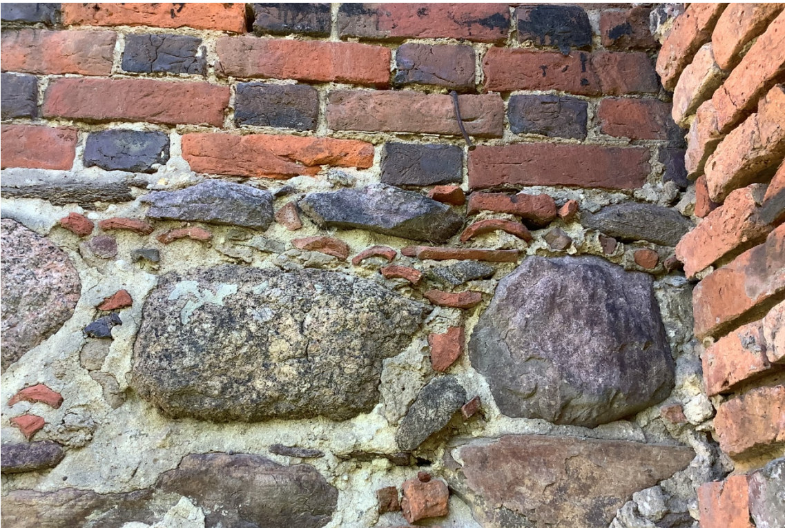
Fot. 31. Kamienie i cegły o dużych wymiarach w dolnej części murów elewacji zachodniej, cegła zendrówka i fragmenty dachówki.
