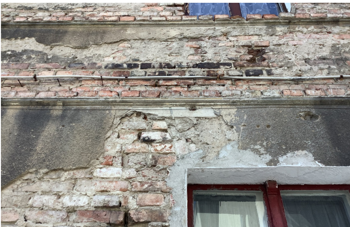
Fot. 33. Relikty tynków z przebudowy w 4 ćwierci XIX wieku ze śladami pseudo klińców nadokiennych, zachowane fragmenty gzymsów.
