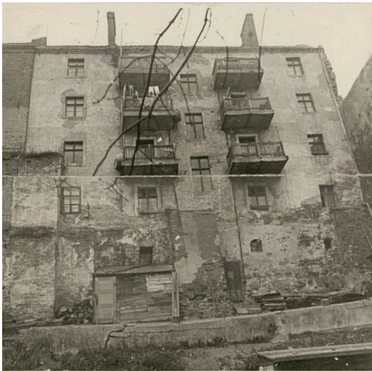
Ryc. 18. Fotografie archiwalne z 1959 roku. Źródło Zielona Karta Obiektu. Widoczne tynki i ślady opasek okiennych.
