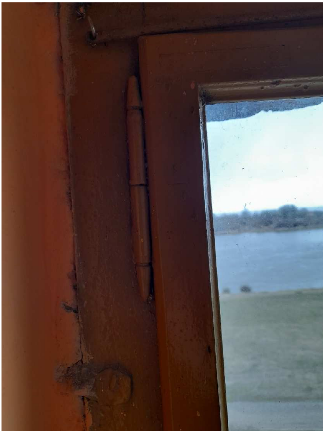
Fot. 26. Okucia, okno klatki schodowej.
