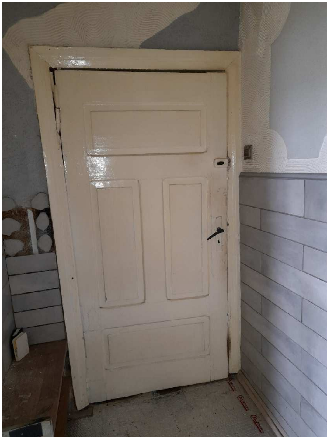
Fot. 20. Wewnętrzne drzwi ramowo-płycinowe do mieszkania.
