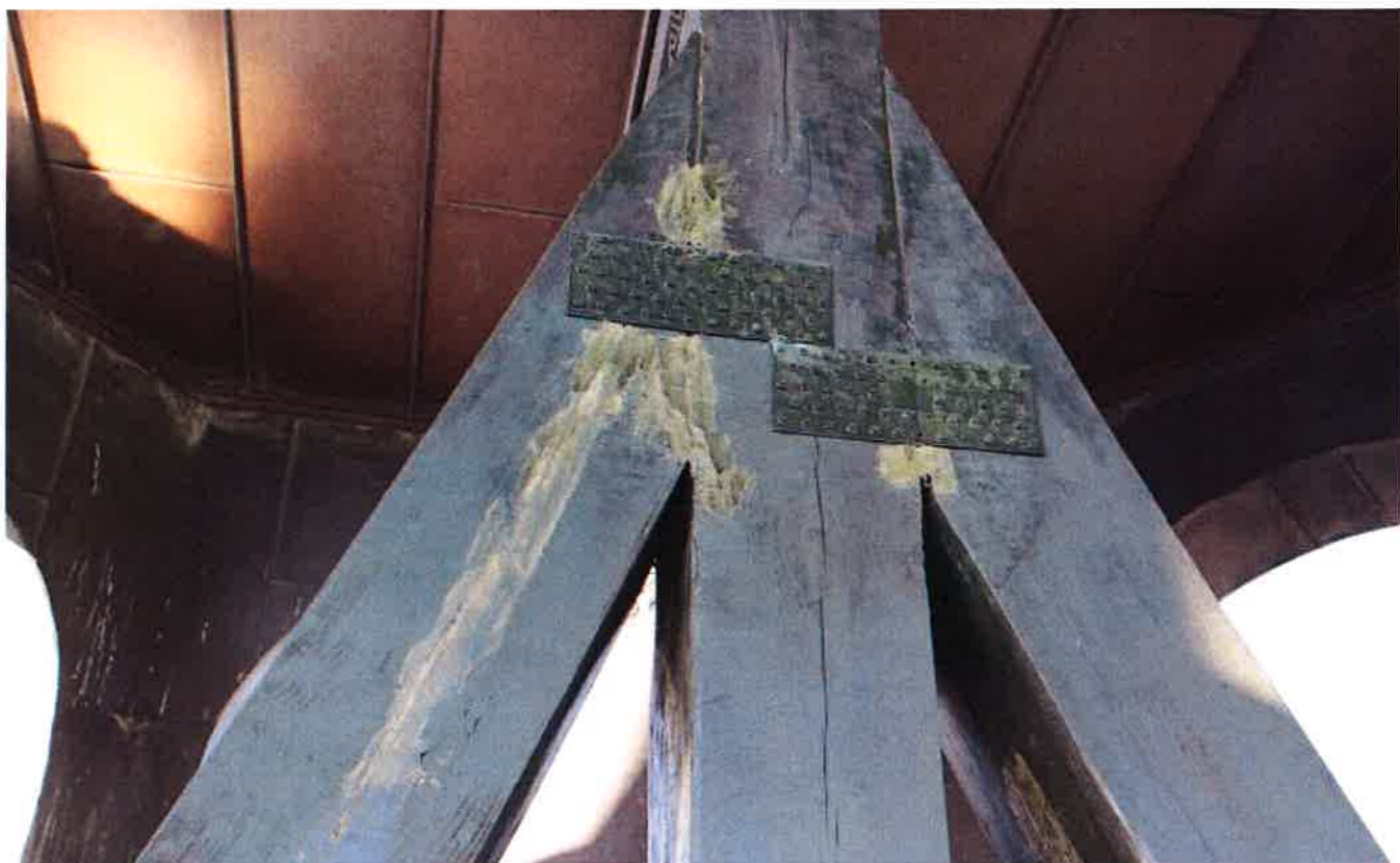
Fot. 53. Niestaranne wykonanie smarowania blach podłogowych tarasu (warstwa do usunięcia).
