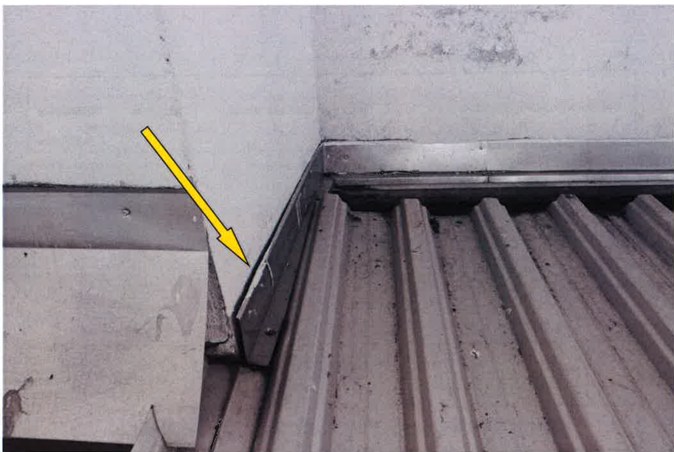
Fot. 85, 86. Szpary między ścianą a obróbka blacharską. Możliwość zaciekania wody pod obróbkę. Blacha nie umocowana.
