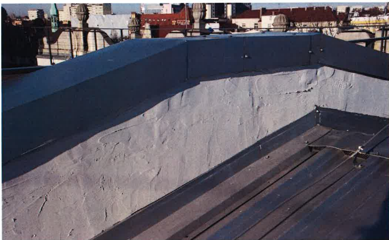
Fot. 80. Tynk na ścianie attykowej z dużymi nierównościami. Brak siatki zbrojącej pod warstwą tynku (peknięcia tynku, odpryski spowodowane brakiem siatki).
