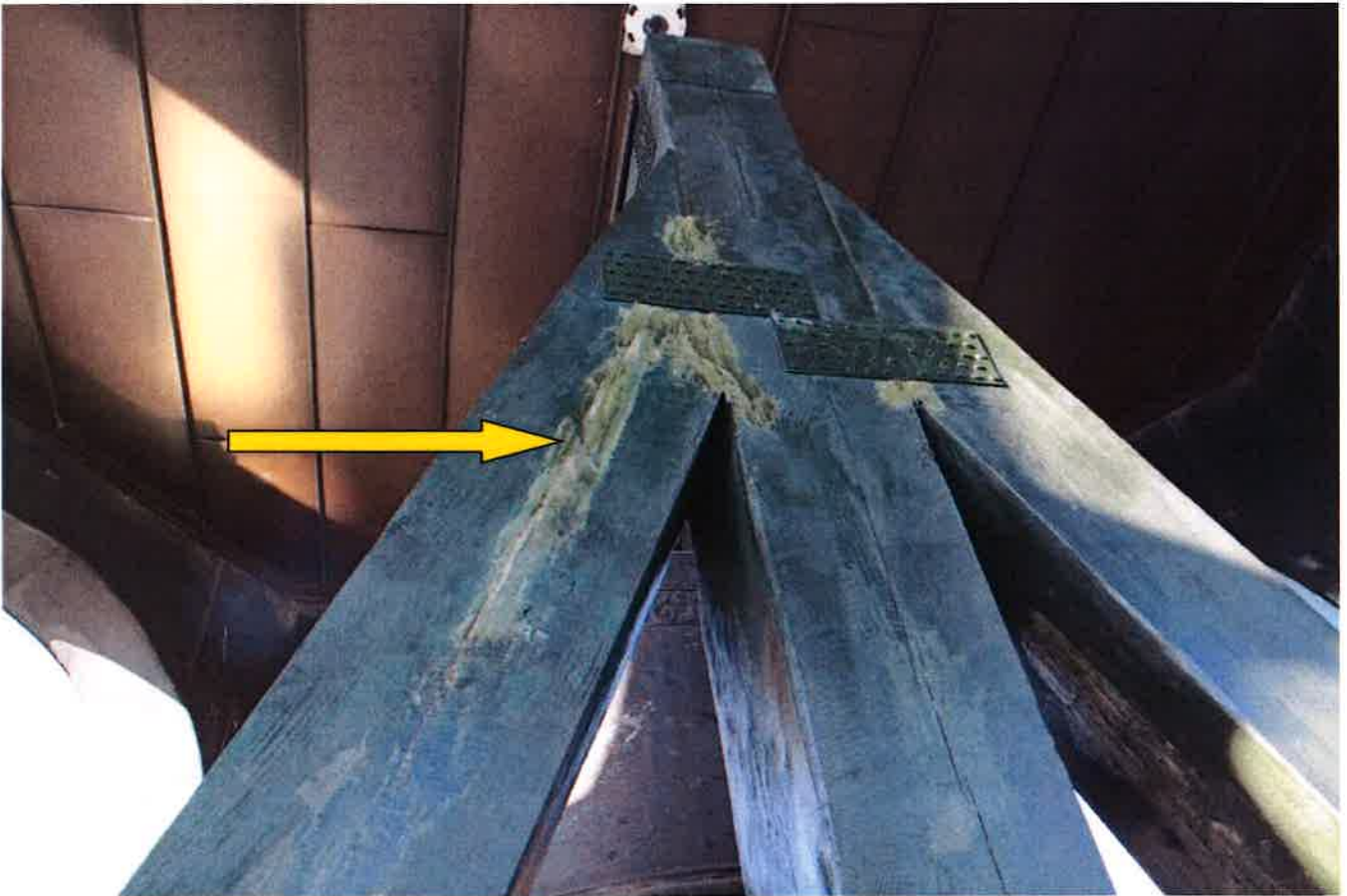
Fot. 43, 44. Konstrukcja stojaka dzwonu . Wykonanie z drewna sosnowego nie sezonowanego. Zbyt mokre drewno spęka- ne w trakcie wysychania po zamontowaniu . Pęknięcia powstałe w trakcie wysychania zaszpachlowane masą w sposób nieestetyczny, szpecący ogólny widok. Drewno powinno być sezonowane i odpowiednio segregowane z usunięciem elementów nadmiernie spękanych.
