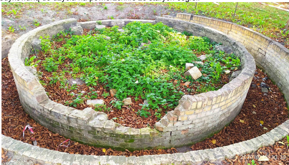
Stan istniejący fontanny do remontu
