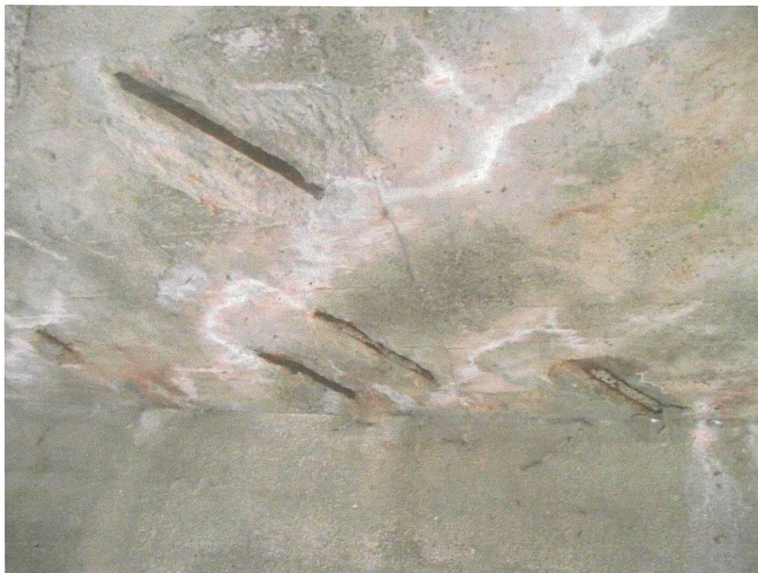
Fot. 3 . Płyta pomostowa, ubytki betonu, przecieki i wykwity. Korozja odsłoniętego zbrojenia.
