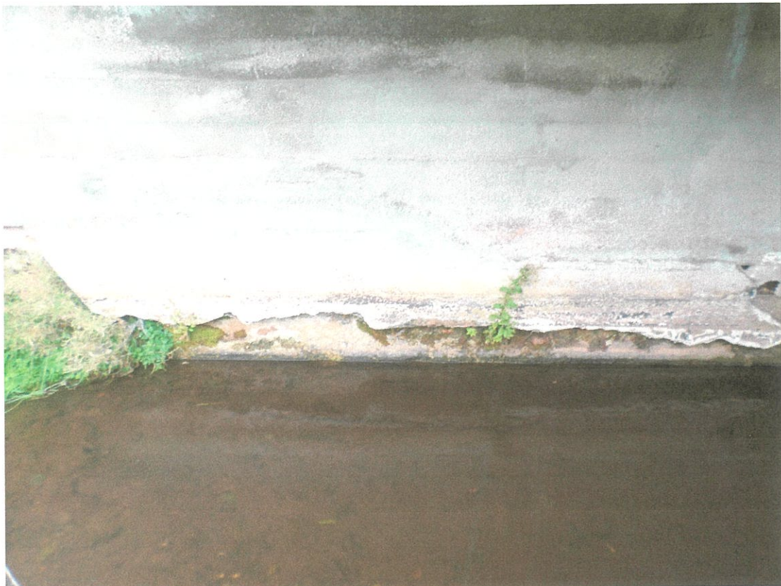
Fot. 2 . Erozja betonu przyczółków, złuszczenia, ubytki.
