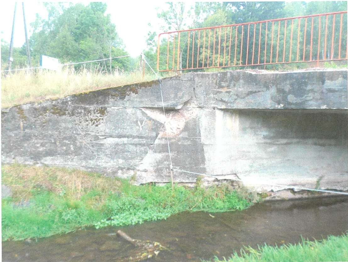
Fot. 1 . Erozja betonu skrzydełka i przyczółków, złuszczenia, ubytki.
