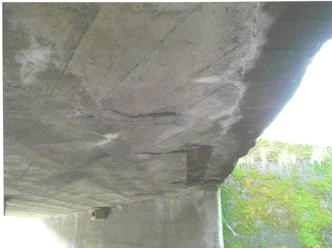
Fot. 4 . Uszkodzenia płyty pomostowej, korozja i ubytki betonu, przecieki wody, korozja odsłoniętych dźwigarów stalowych i zbrojenia.
