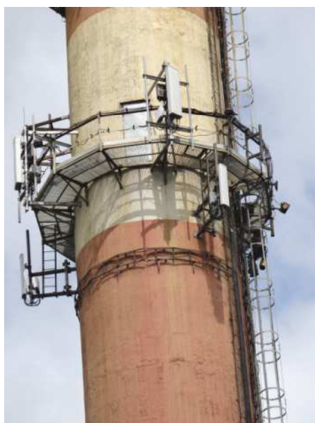
Fot.3,4,5.Pomosty obsługowe zamontowane na kominie
