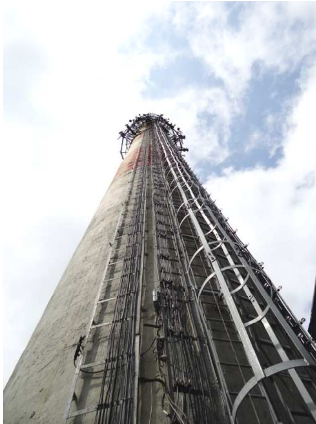
Fot.9.Ciagdrabin włazowych, pionowe trasy kablowe
