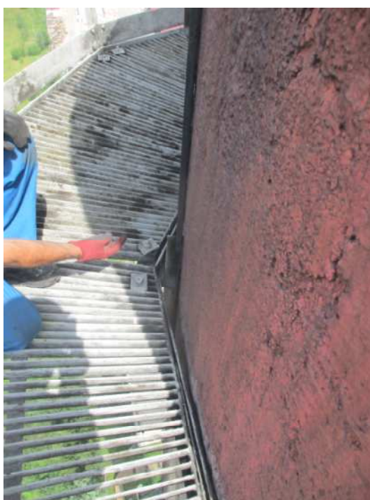
Fot.33.Nieciągły zwód odgromowy w okolicy pomostu szczytowego
