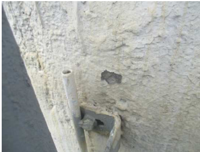
Fot.21.Lokalne uszkodzenia warstw wierzchnich trzonu
