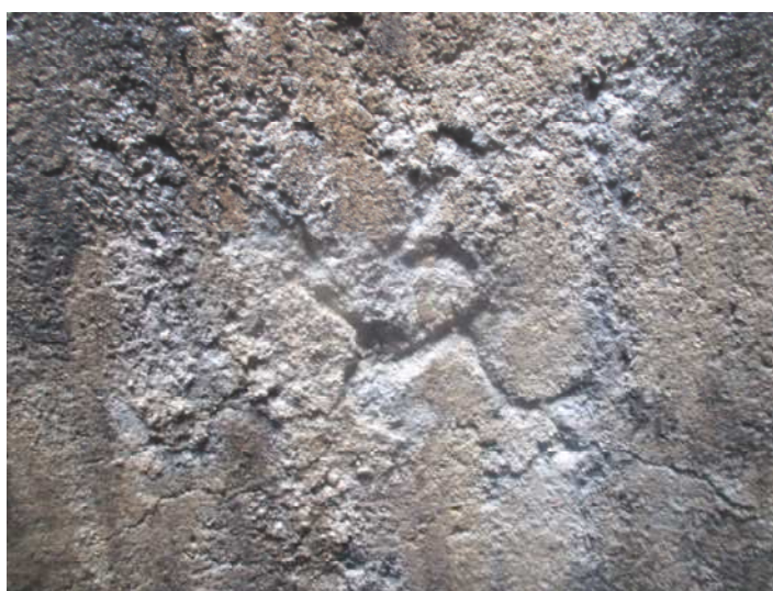
Fot.40,41,42.Niewielkie ubytki powierzchniowe wewnętrznej powierzchni przewodu dymowego w okolicy poziomu +65
