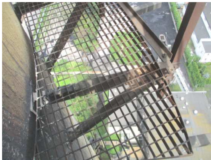
Fot.28,29,30.Korodujące podesty obsługowe anten i konstrukcje wsporcze anten na szczycie komina
