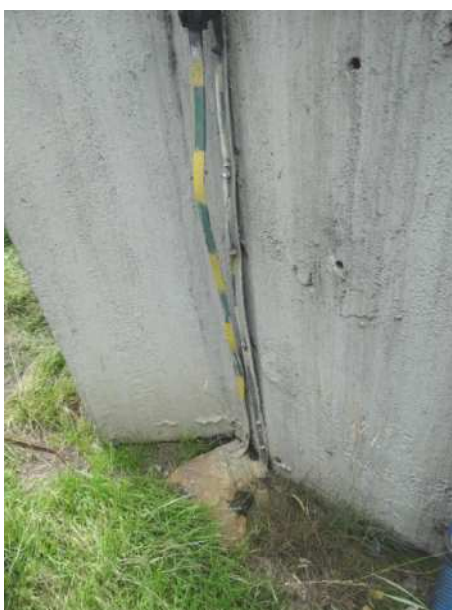
Fot.6,7,8.Otwor wejściowy do komina, zwody odgromowe
