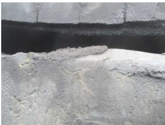
Fot.35.36.Zwieńczenie trzonu i przewodu dymowego
