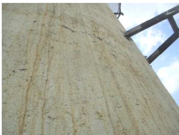
Fot.16,17,18.Zacieki korozyjne w szczytowym odcinku trzonu
