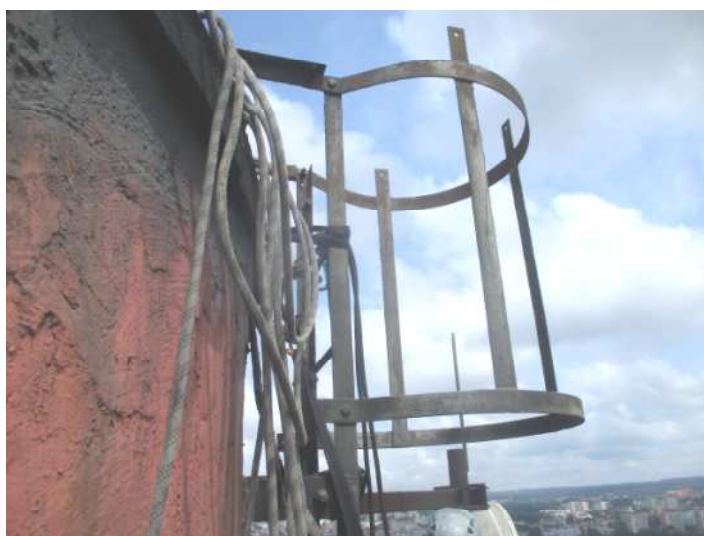
Fot.23,24,25. Uszkodzenia malowania poniżej głowicy
