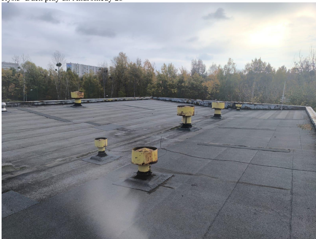
Rys.5 Dach przy ul. Andromedy 2b
