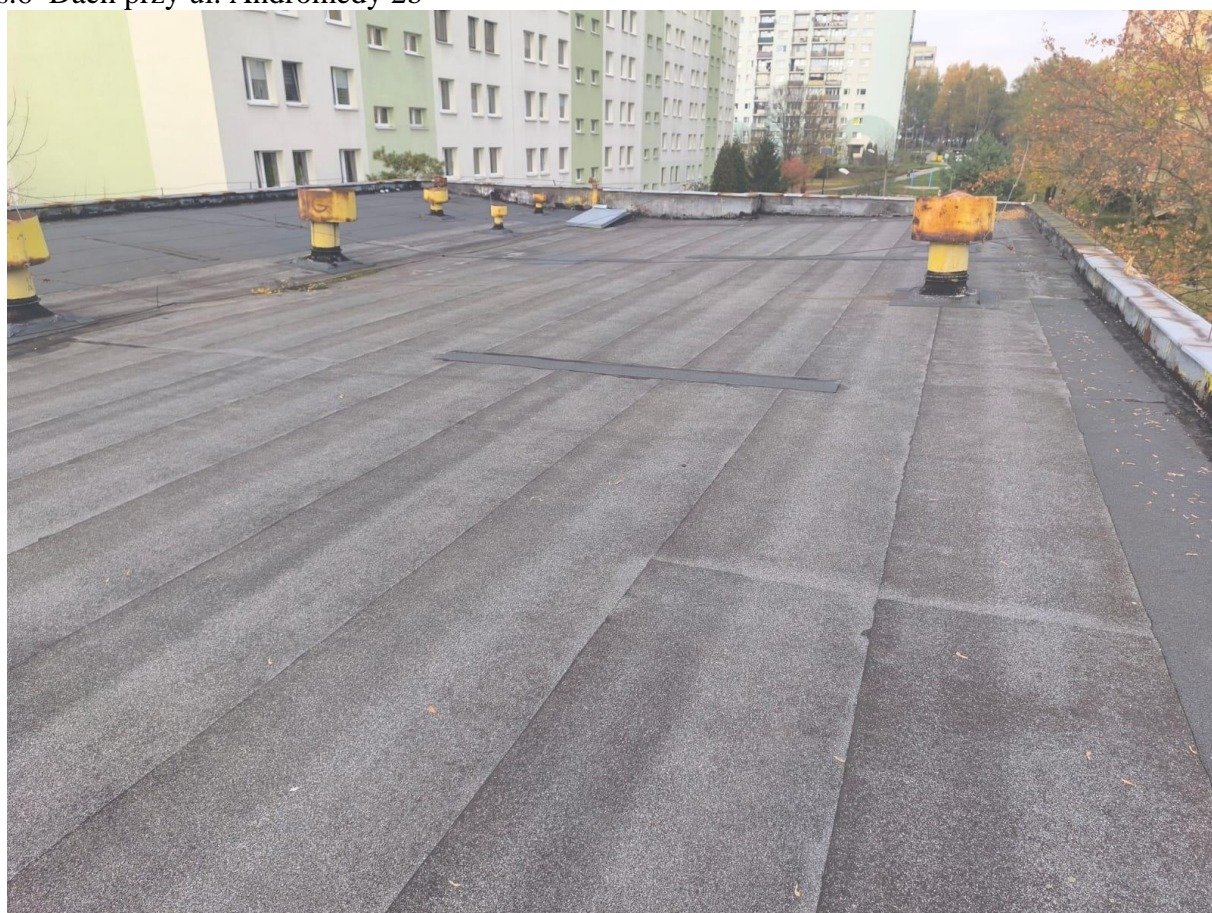
Rys.6 Dach przy ul. Andromedy 2b
