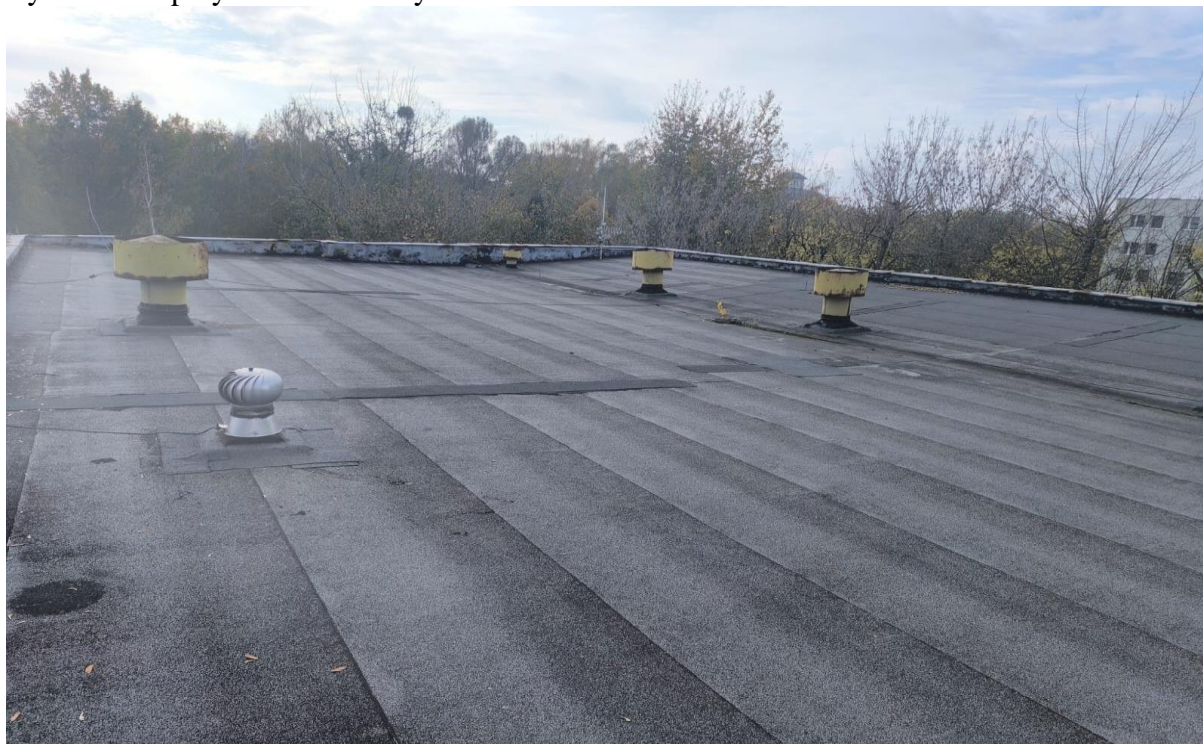
Rys.6 Dach przy ul. Andromedy 2b
