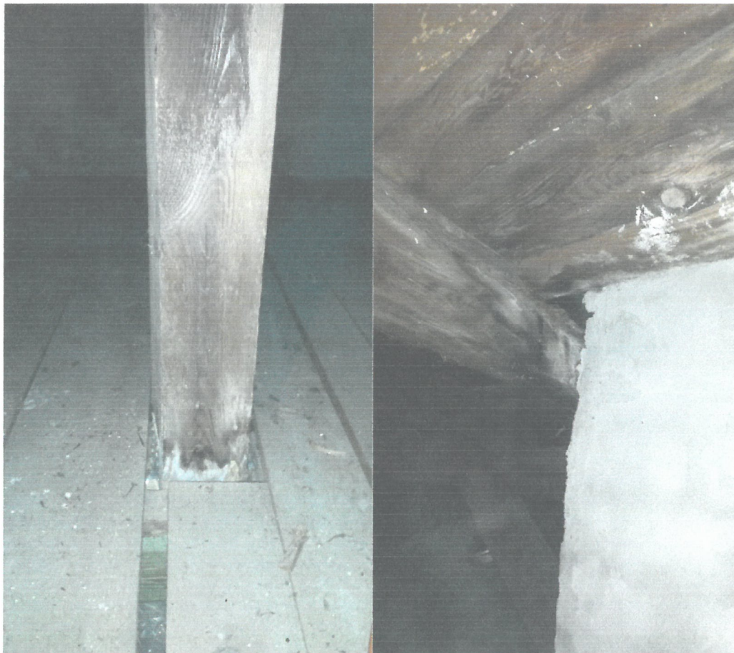
Korozja biologiczna elementów więzby dachowej – słupy i krokiew.
