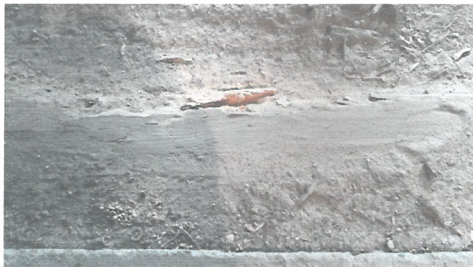
Korozja biologiczna i odspojenia materiału belek stropowych
