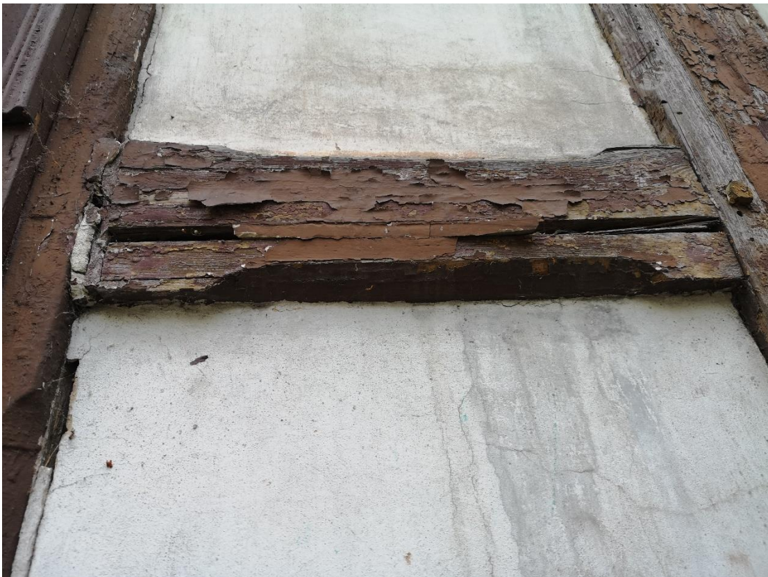
Stan techniczny drewna na elewacji
