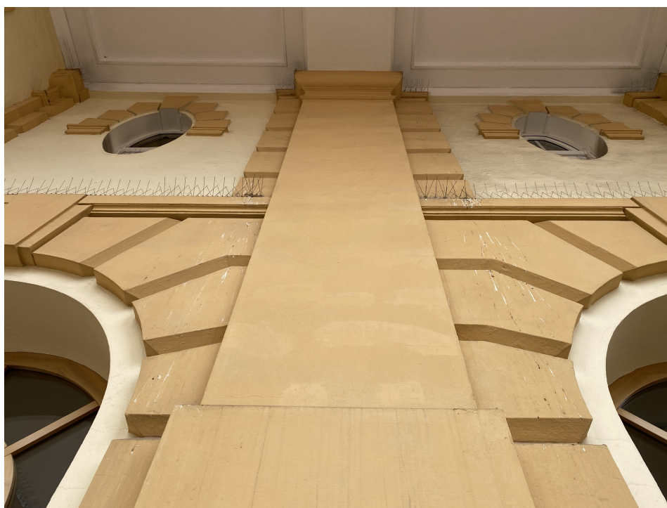
Ilustracja 19: Nieestetyczne naprawy w obrębie pilastrów. fot. P. Głuszko
