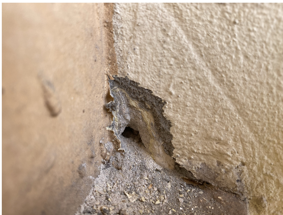
Ilustracja 20: Uszkodzenia tynku oraz warstw malarskich. fot. P. Głuszko
