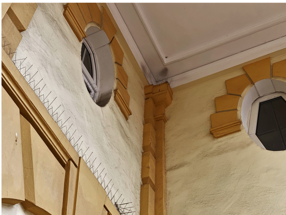
Ilustracja 18: Nierówna powierzchnia tynku powyżej boniowanej pierwszej kondygnacji portyku. fot. P. Głuszko
