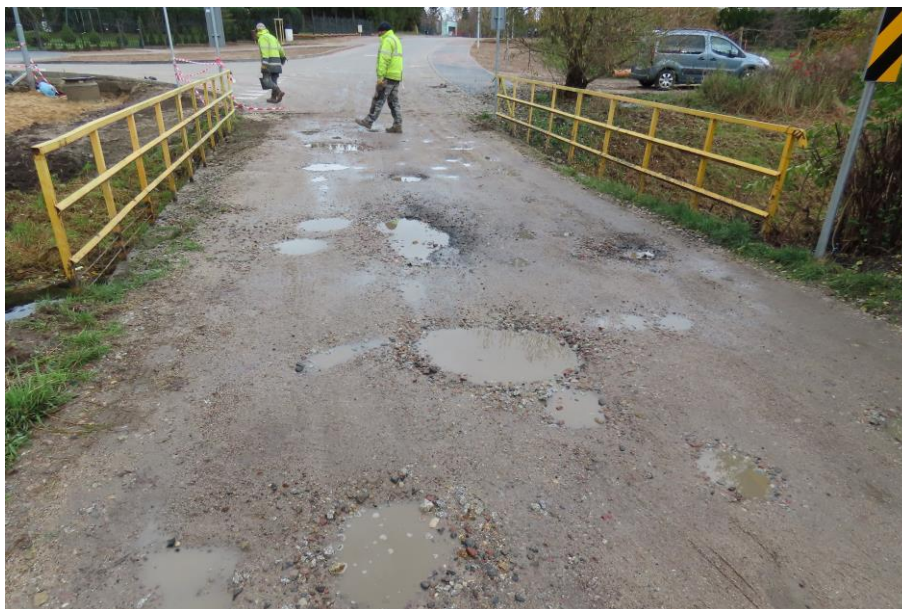
Fot. 2.1. Nawierzchnia tłuczniowa na obiekcie i dojazdach charakteryzuje się występowaniem licznych kolein z zastoiskami wody po opadach, zaś na poboczach wegetacja trawy
