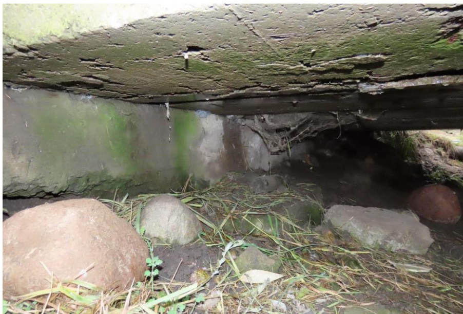
Fot. 2.11. Typowy widok podpory: ubytki betonu, zacieki wody, wegetacja glonów, zanieczyszczenia
