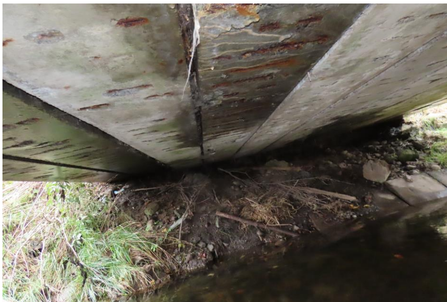
Fot. 2.11. Widok umocnień lewego brzegu koryta rzeki pod mostem: ubytki terenu, przemieszczenia i ubytki prefabrykowanych umocnień, zanieczyszczenia organiczne
