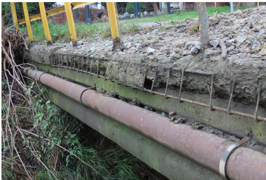
Fot. 2.5. Typowy wygląd gzymsu od strony górnej wody: destrukcja prefabrykatu gzymsu, na znacznej długości pozostała tylko siatka korodującego zbrojenia, korozja powierzchniowa rury osłonowej sieci przesyłowej
