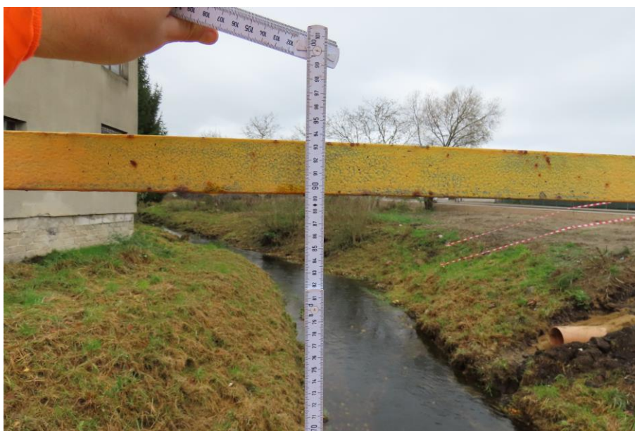
Fot. 2.3. Balustrada na obiekcie: wysokość balustrady 1,12 m, natomiast mierząc od nawierzchni tłuczniowej 0,93 m, na balustradach występują liczne drobne wykwity ognisk korozji
