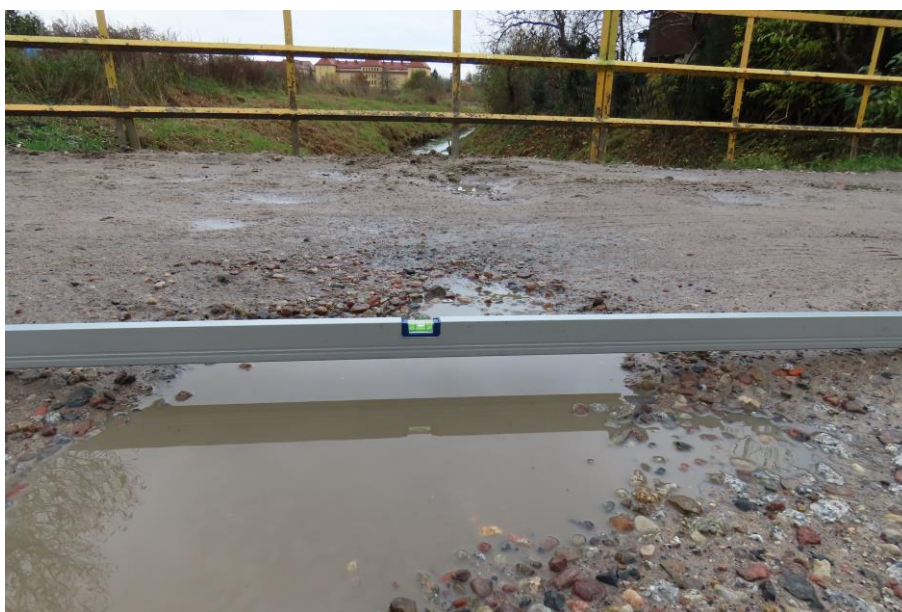
Fot. 2.2. Typowy wygląd koleiny na jezdni: głębokość około 80 mm, wymiary poprzeczne około 1x1 m
