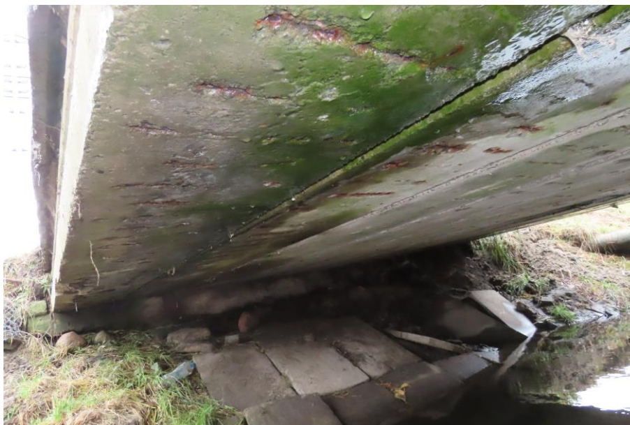
Fot. 2.7. Typowy wygląd dźwigarów skrajnych: zawilgocenia, wegetacja glonów, ubytki otuliny i postępująca korozja głównie strzemion, rzadziej zbrojenia głównego
