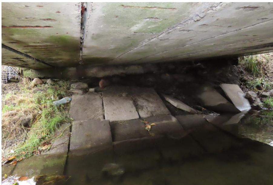
Fot. 2.12. Widok umocnień prawego brzegu koryta rzeki pod mostem: wypłukana i rozmyta skarpa, zapadnięcie prefabrykowanych umocnień
