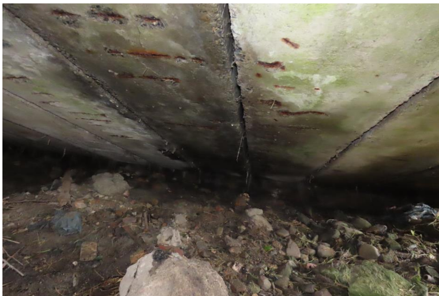
Fot. 2.9. Typowy wygląd dźwigarów pośrednich: zawilgocenia, wegetacja glonów, ubytki otuliny i postępująca korozja głównie strzemion, rzadziej zbrojenia głównego
