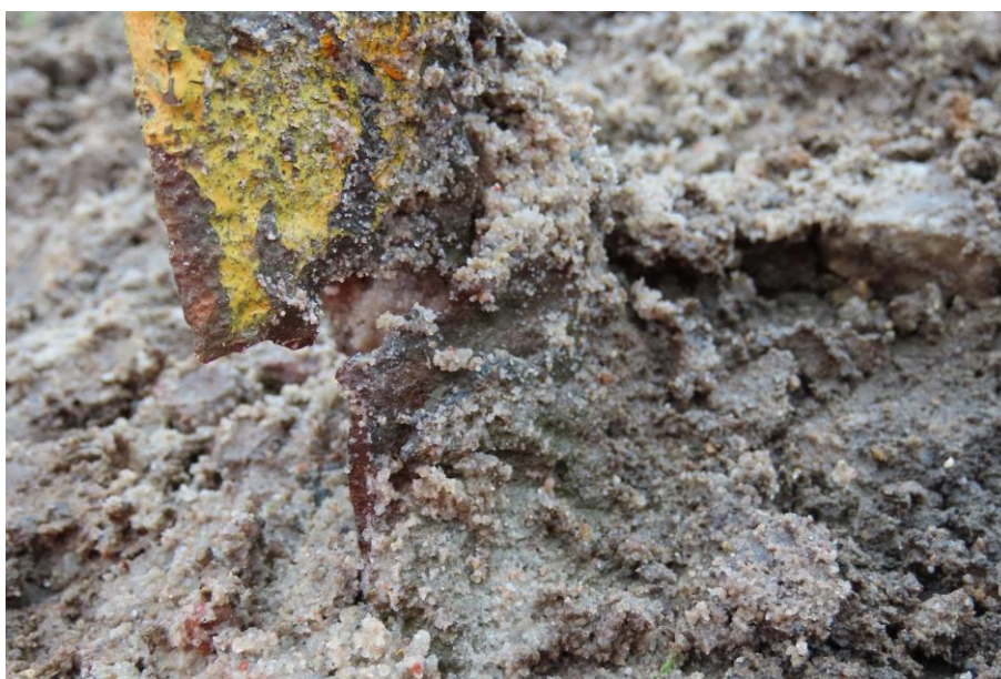
Fot. 2.4. Zaawansowana korozja słupka balustrady w utwierdzeniu (perforacja ścianek kształtownika) – pojedynczy przypadek po stronie górnej wody
