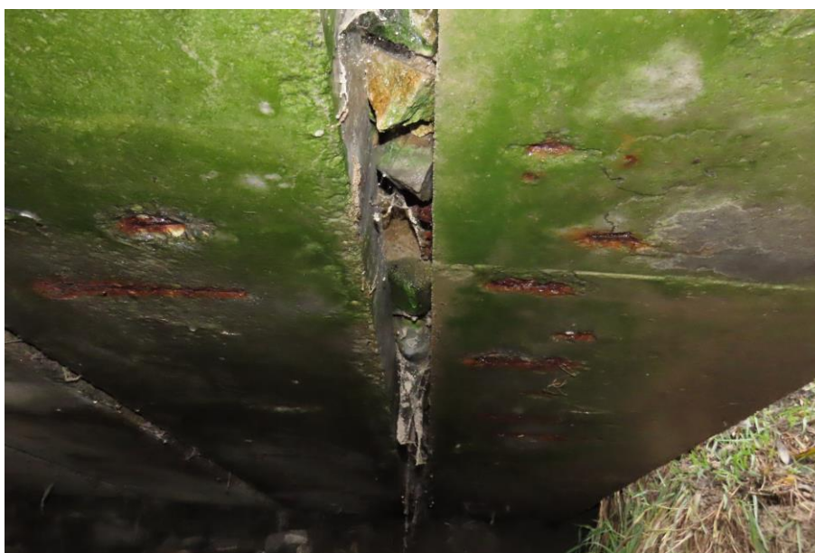
Fot. 2.10. Szczelina między dźwigarami wypełniona tłuczniem, co oznacza, że ustrój nośny nie jest zespolony nadbetonem, nie ma też izolacji, natomiast bezpośrednio na dźwigarach ułożona jest nawierzchnia tłuczniowa
