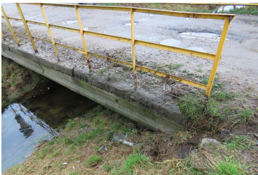
Fot. 2.6. Gzyms od strony dolnej wody: znaczne ubytki betonu i korozja zbrojenia, na skarpach brak korytek ścieków skarpowych do odprowadzenia wody
