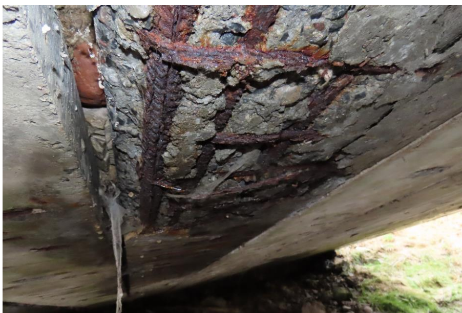
Fot. 2.8. Dźwigar czwarty licząc od strony górnej wody: lokalna zaawansowana korozja zbrojenia (strzemiona w wyniku korozji utraciły ciągłość), zacieki wody, ubytki betonu
