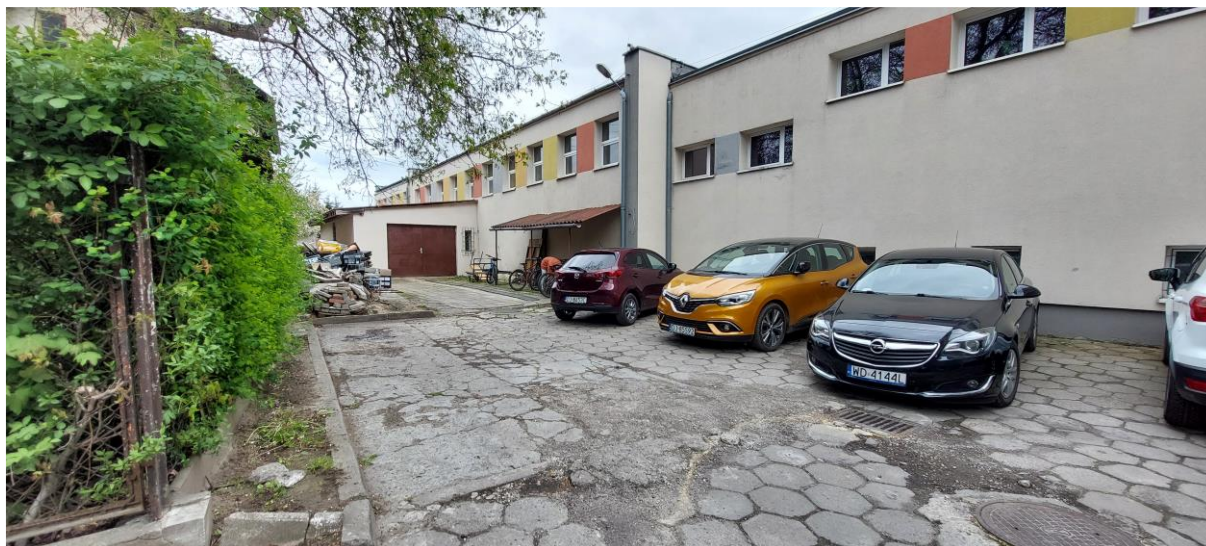
Fot. 1. Widok budynku od strony zachodniej, nawierzchnia wymagająca wymiany (strefa „a”).
