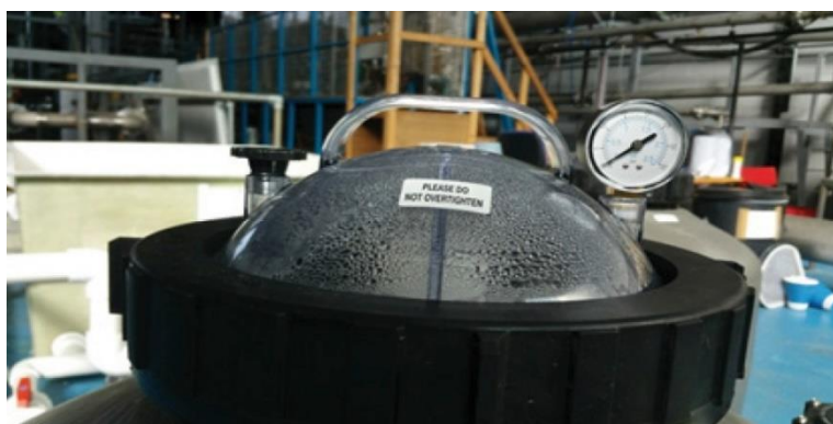
Manometry w zbiornikach filtracyjnych
