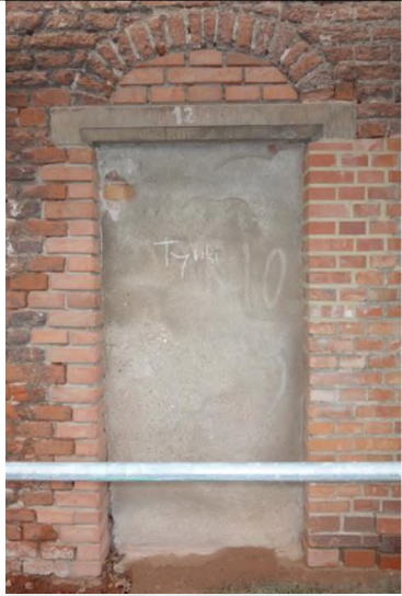
Drzwi nr 7 - zamurowane
