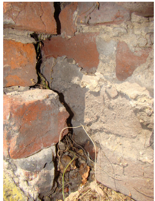
fot. 10: odspojenie licowania w części cokołowej od strony południowej; widoczna 2cm szczelina i wrastająca w nią roślinność
