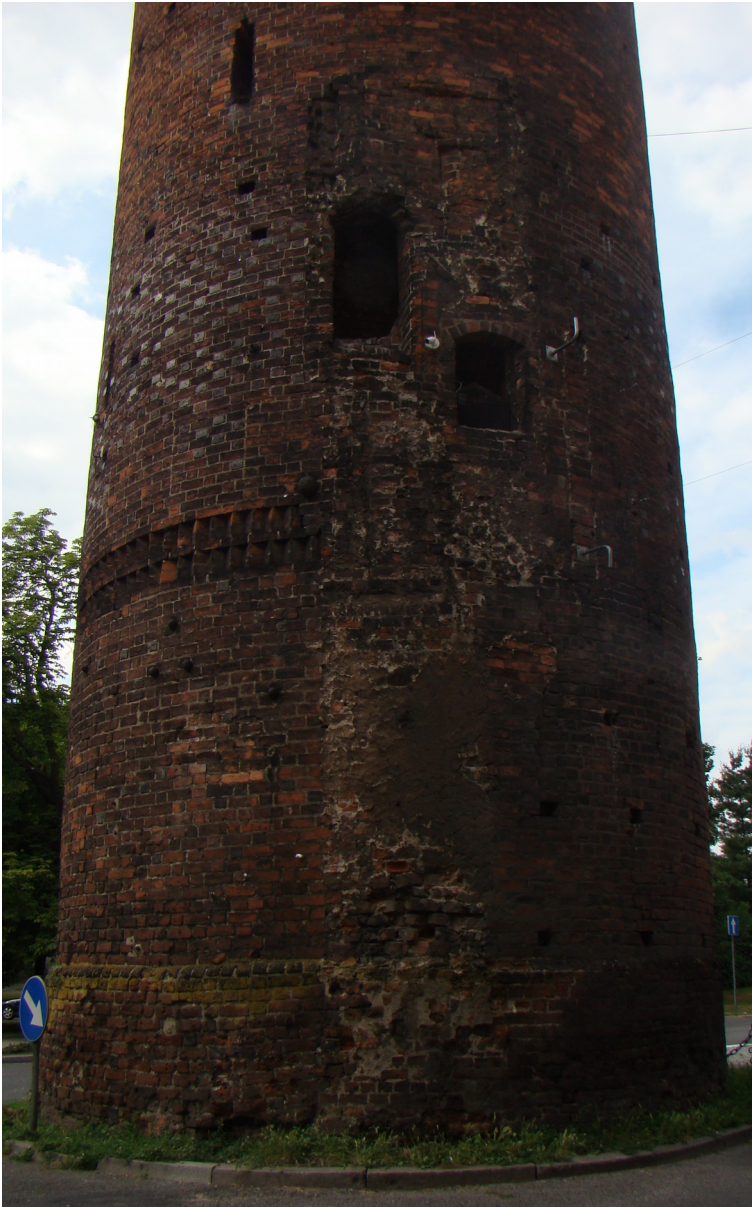
fot. 6: strzępia i ślady po przyleganiu murów obronnych od strony wschodniej; widoczne wtórne zaprawy przykrywające połączenie muru wymagające uporządkowania, w górnej części otwory dawnych wejść na mury obronne, cokół pokryty koloniami porostów
