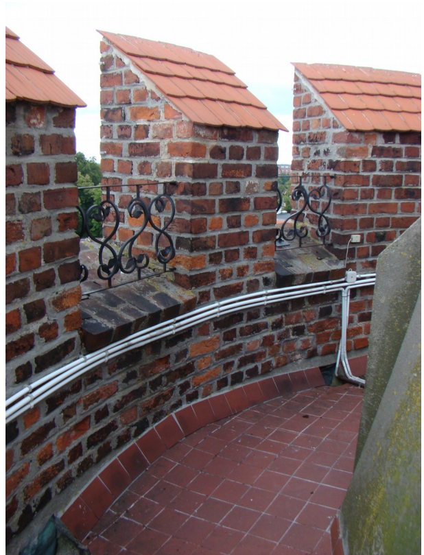
fot. 21: wewnętrzna strona krenelaża z cementowym wypełnieniem spoin; widoczna obecna posadzka ceramiczna i wymagające schowania przewody instalacji, zakłócające estetykę obiektu
