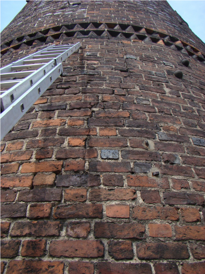
fot. 9: rysa pęknięcia na ścianie od strony południowej
