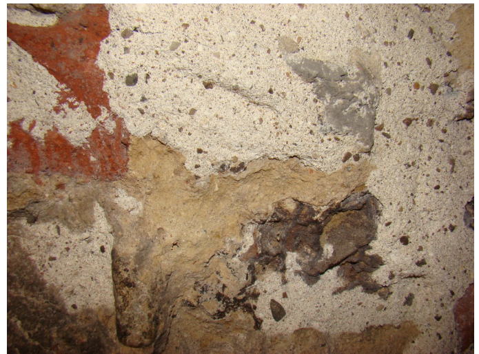
fot. 27: dwa rodzaje tynku w wejściu do baszty, oba mocno zdestruowane, ze śladami pobiał, tynk pierwotny o cieplejszym kolorze
