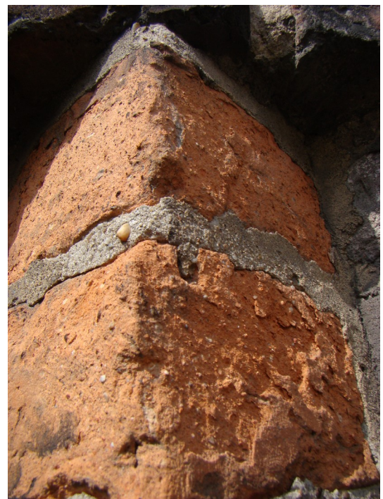
fot. 18: fragment ząbkowego fryzu z wtórnie wstawionymi na zaprawę z udziałem cementu cegłami; widoczna łuszcząca i pudrująca się ich powierzchnia
