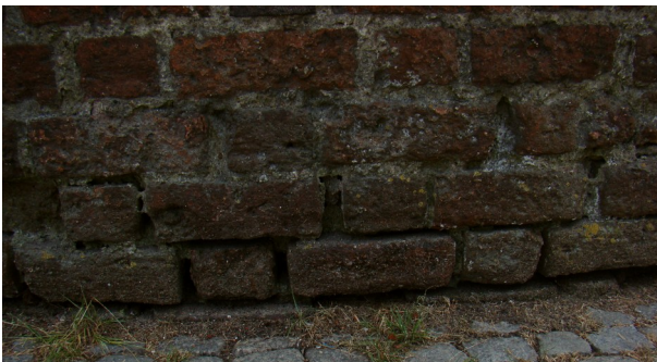
fot. 17: wypłukane głęboko spoiny w przyziemiu
