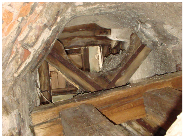
fot. 39: szczytowa część hełmu z więźbą; widoczne półkoliste wycięcia w belkach podstawy sygnaturki dające przestrzeń do wciągania dzwonu, widoczne grube złogi ptasiego guano na belkach i żelazne listwy spinające belki podstawy sygnaturki
