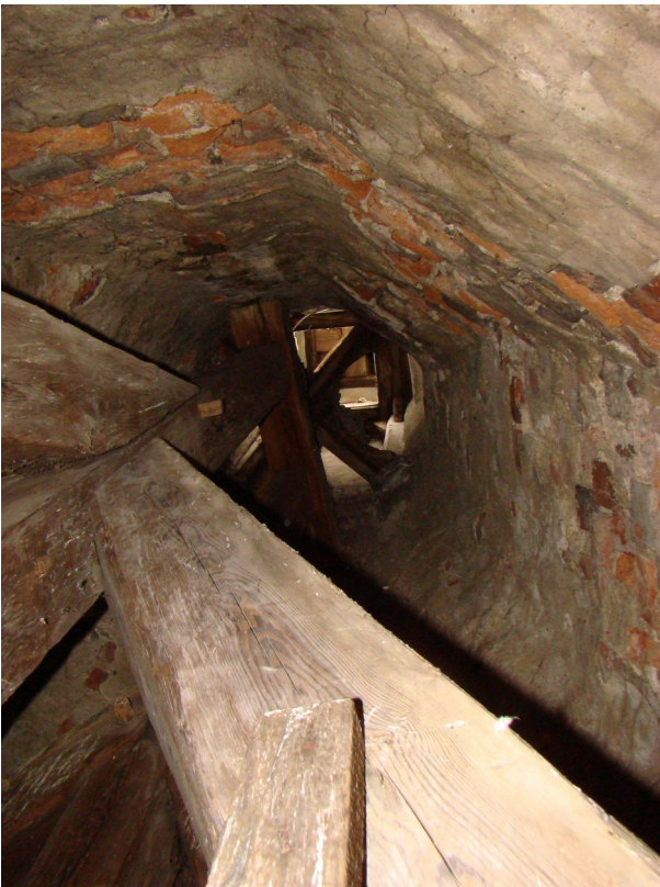
fot. 38: wnętrze hełmu; widoczne miętko kładzone opracowanie tynkarskie i utracone fragmenty tynku w miejscach destrukcji cegieł w wyniku kumulacji soli, widoczna więźba łączona na kołki, przenosząca ciężar sygnaturki mieszczącej dawniej dzwon zegara
