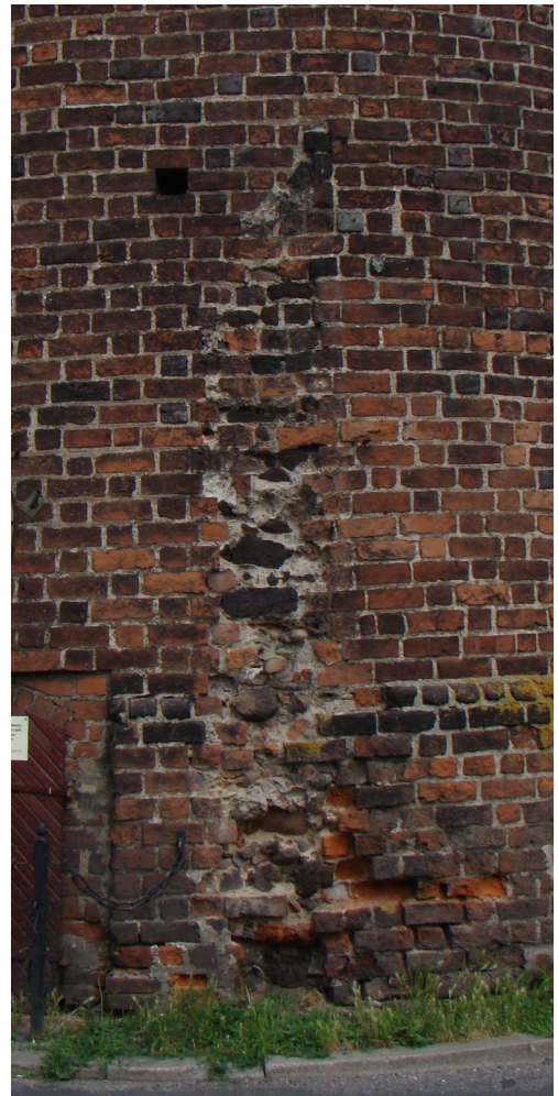
fot. 5: strzępia i ślady po przyleganiu murów obronnych od strony zachodniej; widoczne w dolnej części ubytki cegieł w licu, zacierające linię strzępi
