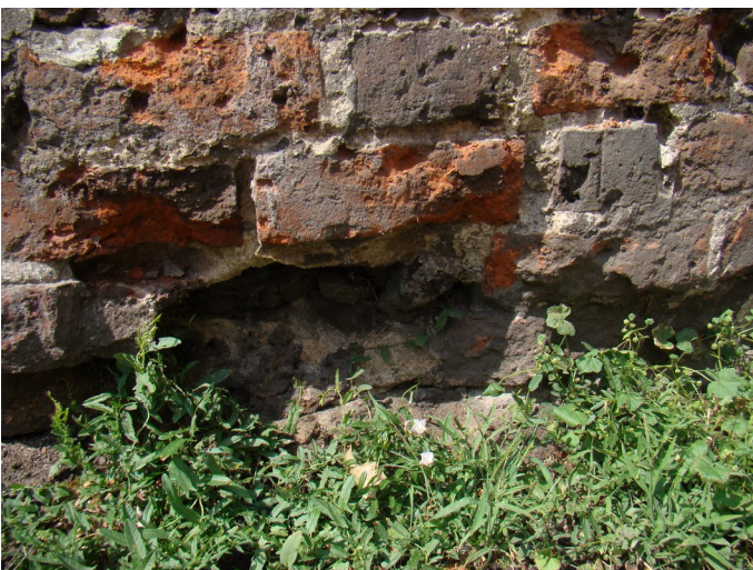
fot. 11: przykład głęboko zdestruowanego w przyziemiu muru w wyniku zasolenia i działania wody
