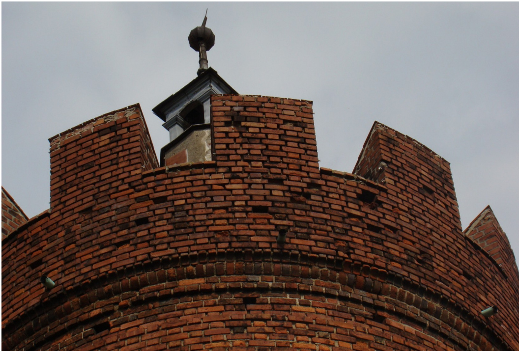
fot. 16: krenelaż baszty z licznymi ubytkami cegieł; widoczne głęboko wypłukane spoiny, nieudolnie przemurowane i przypadkowe fugi z cementowej zaprawy w najwyższych warstwach zębów krytych dachówkami
