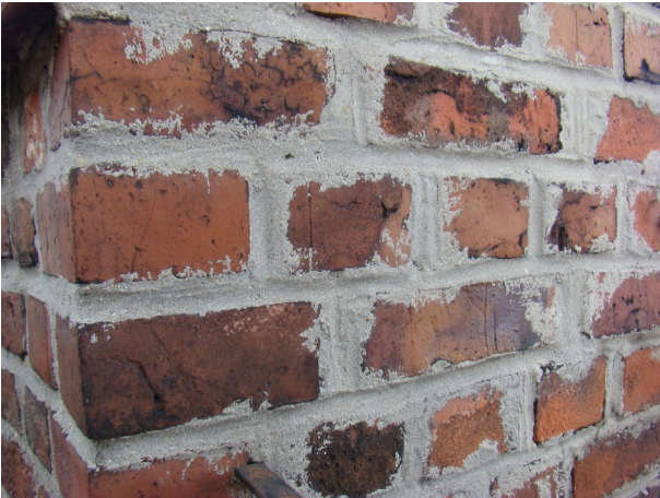
fot. 20: jeden z zębów krenelaża widziany od wewnętrznej strony; widoczne nieudolnie wykonane cementowe wypełnienia spoin
