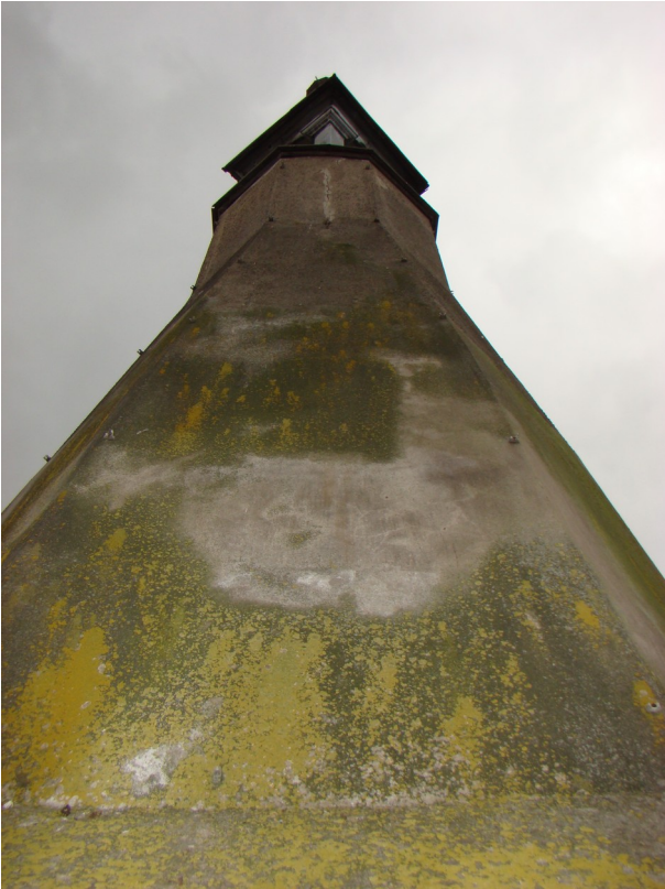
fot. 22: cementowa wyprawa tynkarska hełmu, widziana z krenelaża; widoczne kolonie porostów i zanieczyszczenia tynku
