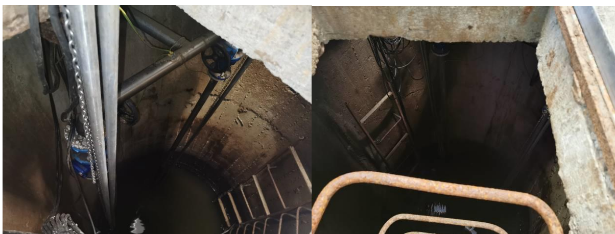
Rysunek 1 Komora przepompowni - stan obecny
