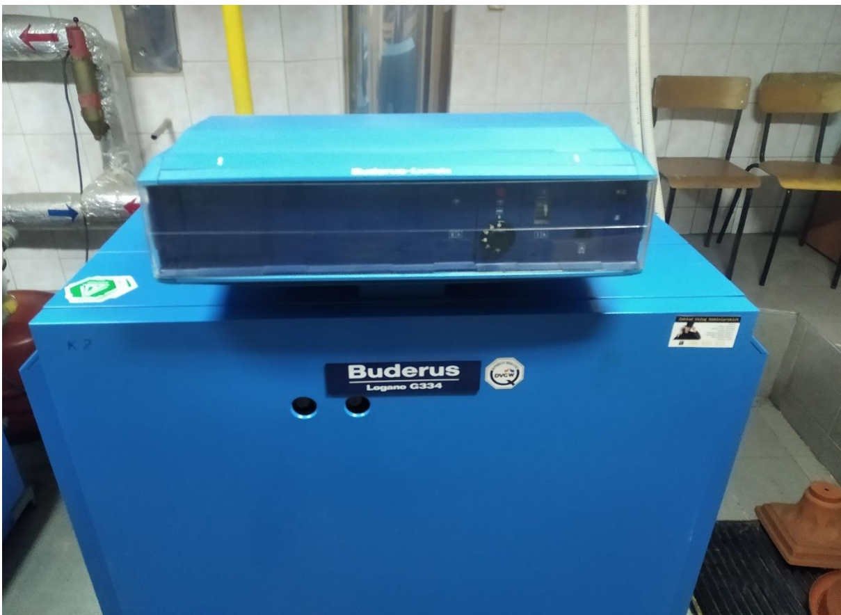
Rysunek 2. Kocioł gazowy wykorzystywany w rozpatrywanym budynku
