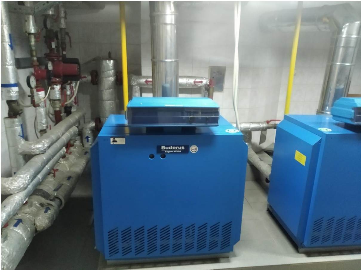
Rysunek 1. Kocioł gazowy wykorzystywany w rozpatrywanym budynku
