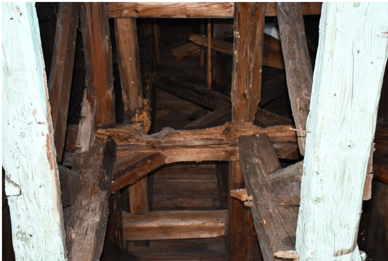
Zdj. 3 Uszkodzone elementy konstrukcji w wieży poz. 27,44 m
