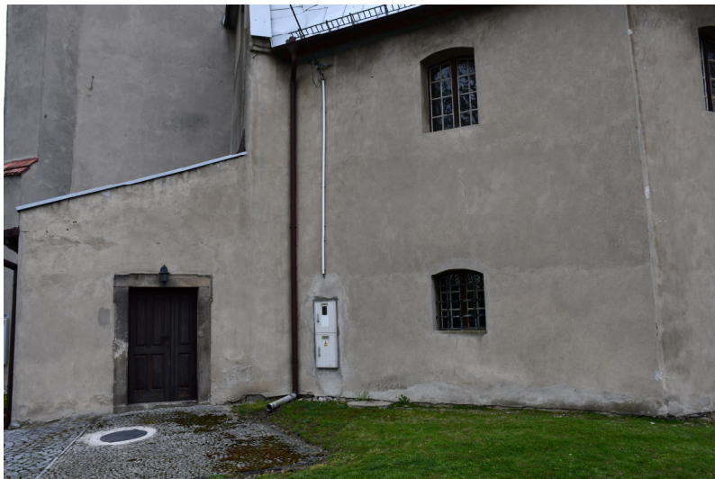
Zdj. 19 Elewacja płd-zach. uszkodzenia tynków i zarysowania
