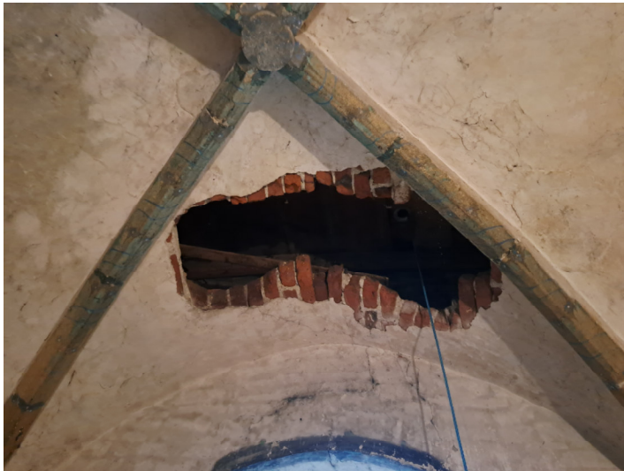
Zdj. 7 Uszkodzenie sklepienia
