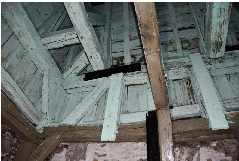
Zdj. 4 Wzmocnienie konstrukcji wieży, zagrzybione deskowanie
