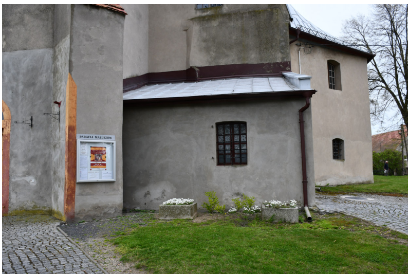
Zdj. 20 Elewacja zach. uszkodzenia tynków i zarysowania w kaplicy
