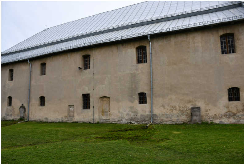
Zdj.11 Elewacja północna uszkodzenia tynków
