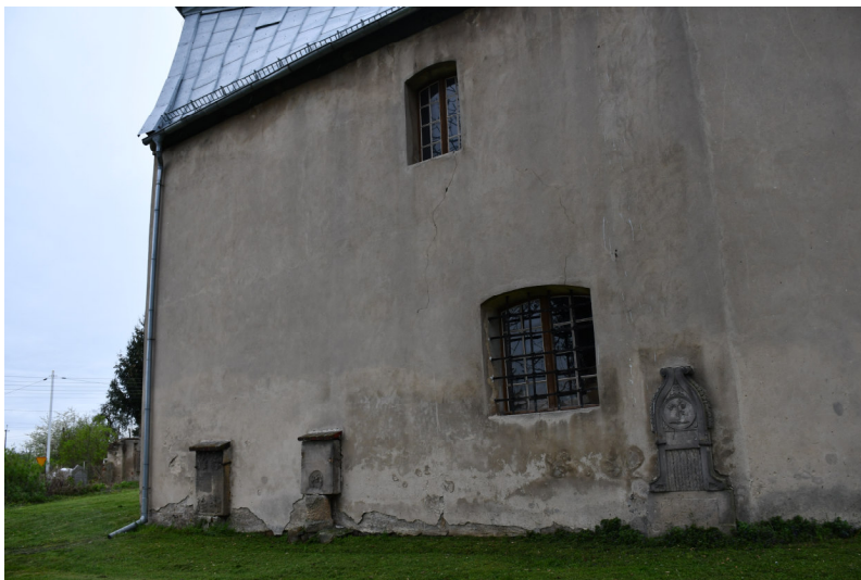
Zdj.12 Elewacja północno-wsch. uszkodzenia tynków, zarysowania ścian
