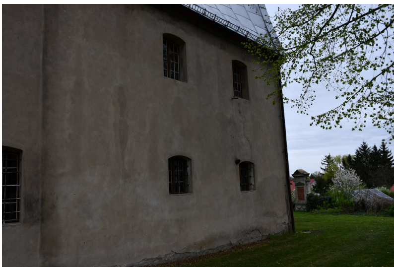
Zdj.14 Elewacja płd- wsch. uszkodzenia tynków, zarysowania ścian
