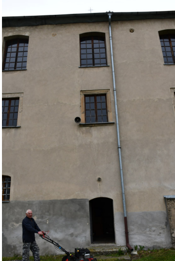
Zdj.13 Elewacja wsch. uszkodzenia tynków, zarysowania ścian
