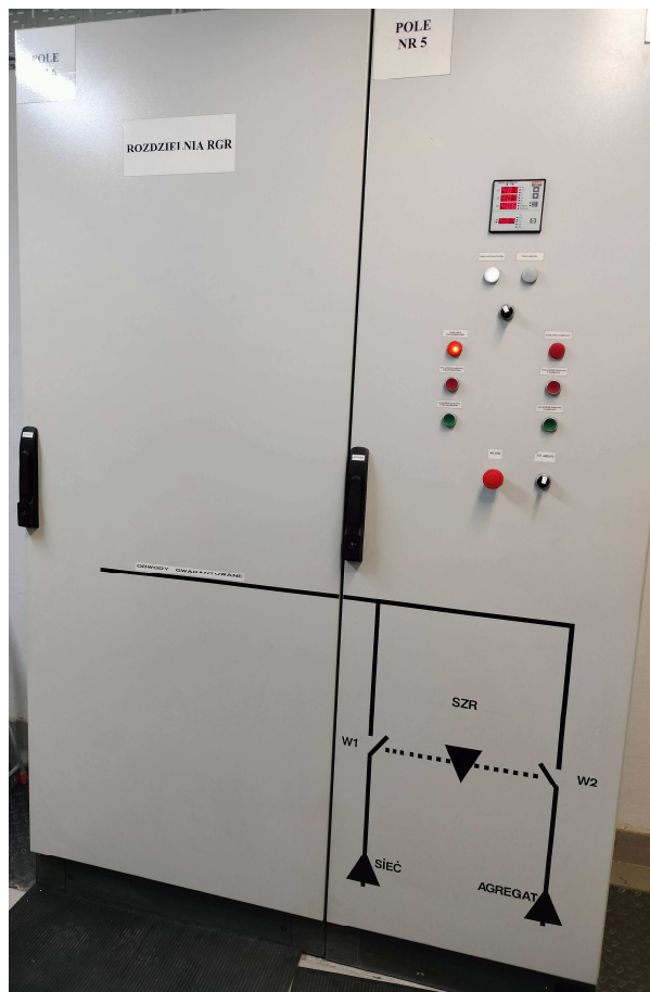
Rys. 6 Widok rozdzielni głównej RGN – elewacja
