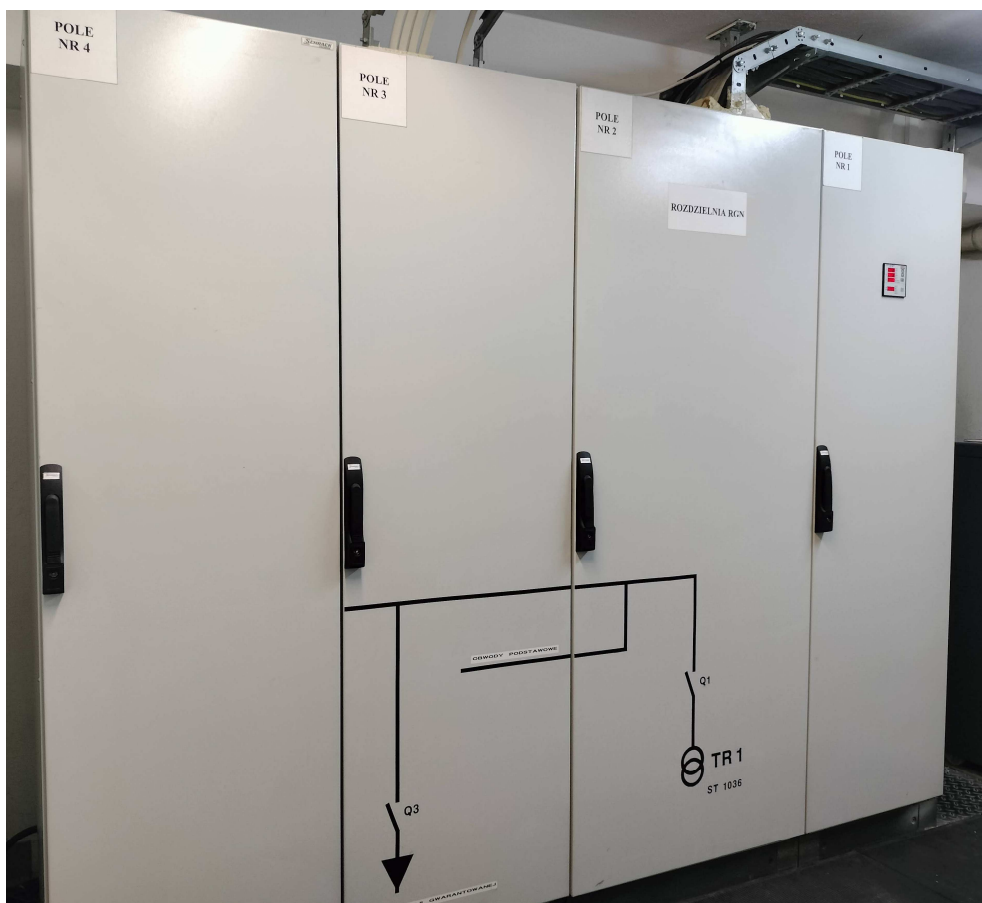
Rys. 7 Widok rozdzielni głównej RGN – elewacja
