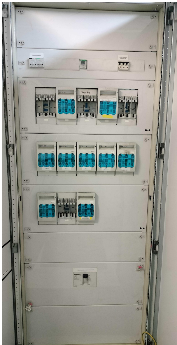
Rys. 8 Widok rozdzielni głównej RGN – rozmieszczenie aparatów pole nr 2
